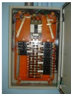
Figura 2 – Modelo do quadro de distribuição.
