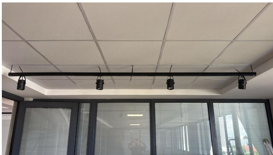
Figura 18- Spot direcionável para eletrocalha tipo perfilado metálico
