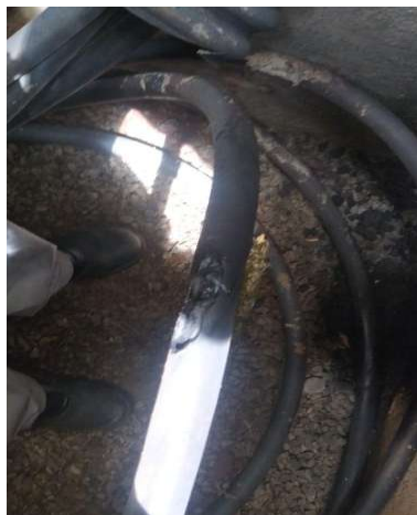
Cabo transmissor danificado
