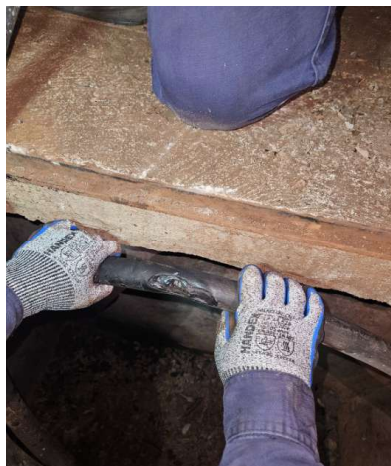
Detalhe do cabo danificado
