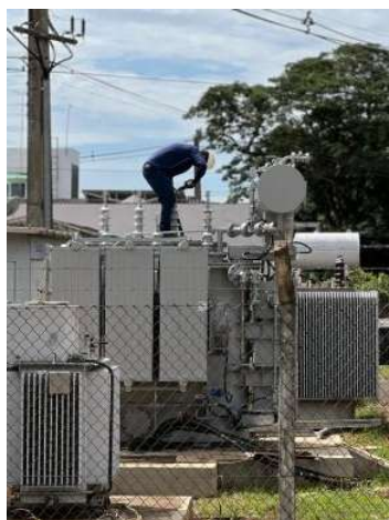
Instalação do transformador Copel
