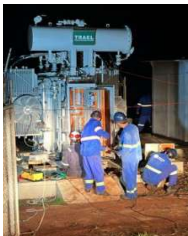
Equipe parametrizando os relés de proteção do transformador
