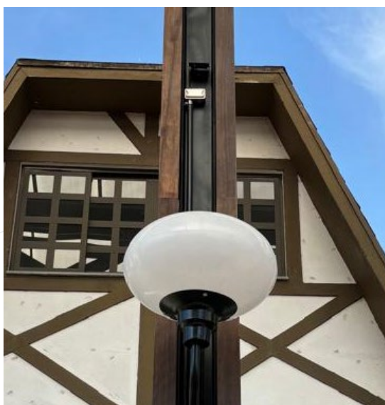
Figura 1 – Luminárias e \Projetores Existentes.
