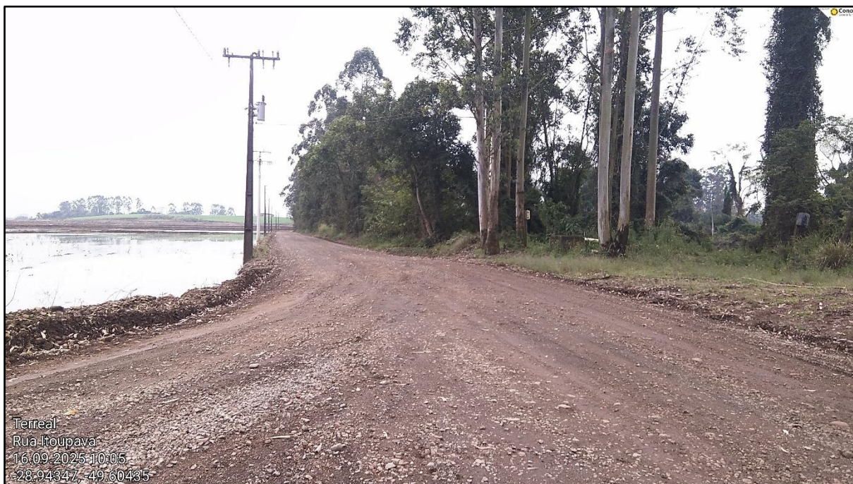
Figura 24 – Final do trecho da Rodovia TVO 362 e início do trecho da Rodovia TVO 359 ser pavimentado
