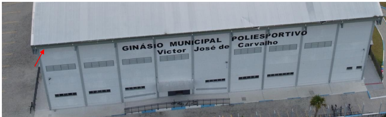
Figura 03 - Identificação da calha que deverá ser substituída no trecho danificado. Arquivo pessoal.
