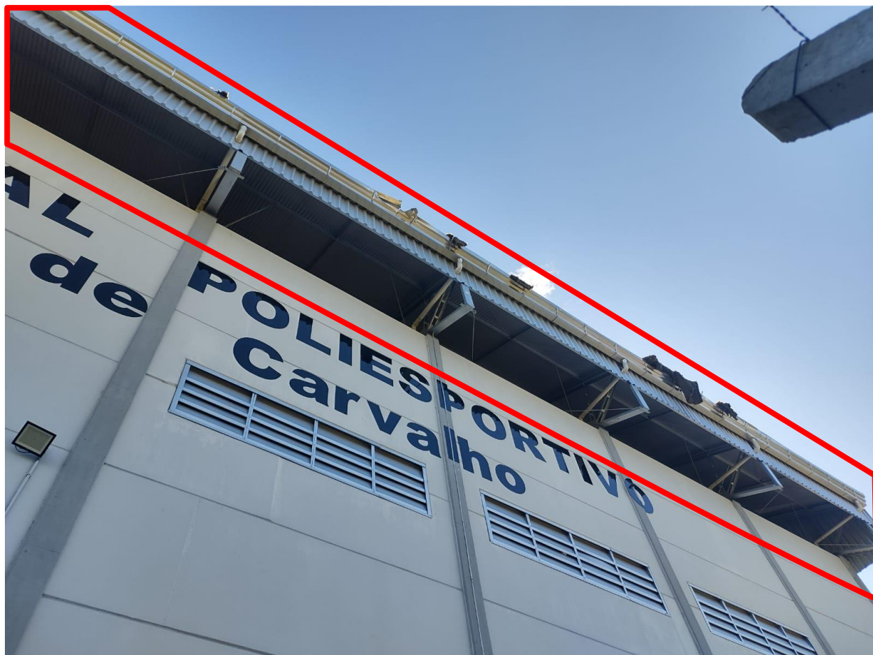
Figura 07 - Identificação do vão lateral que deverá ser fechado em toda a extensão do ginásio. Arquivo pessoal.
