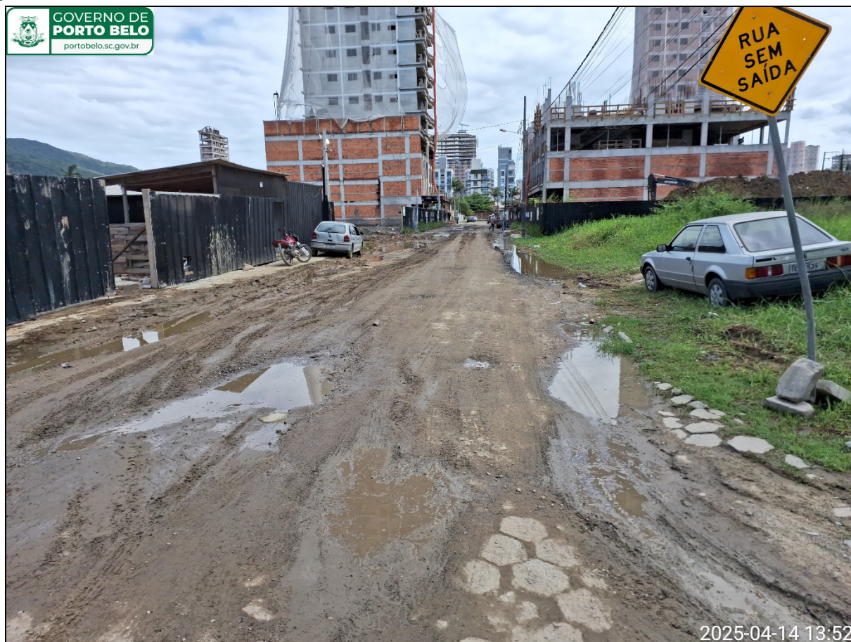
Figura 5 – Situação da via mesmo em dias sem chuva
