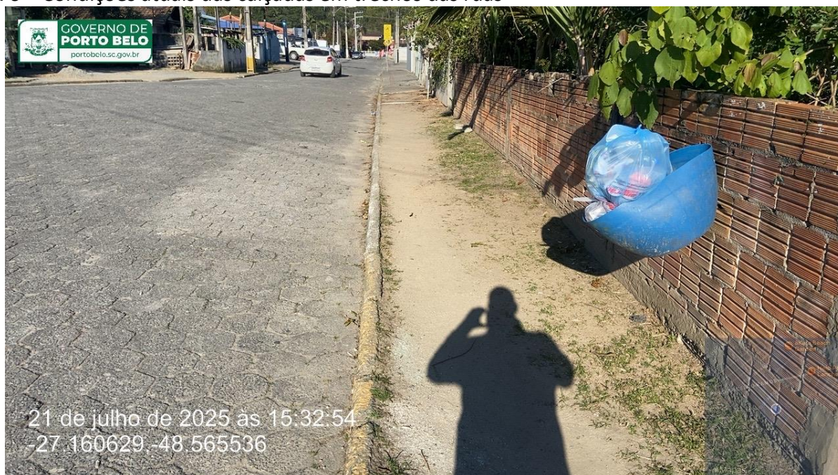
Figura 6 – Condições atuais das calçadas em trechos das ruas
