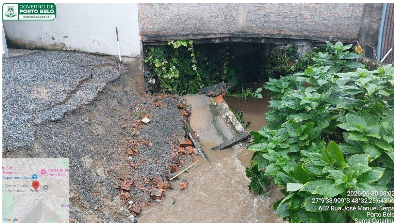
Figura 3 – Agravamento da situação, com queda do muro.
