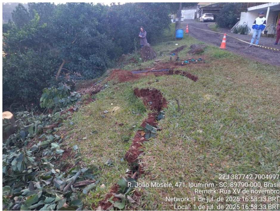
Legenda – situação das rachaduras 01/07 terça.
