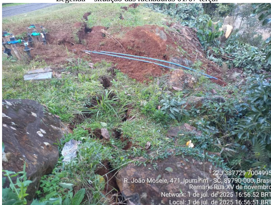
Legenda – situação das rachaduras 01/07 terça.
