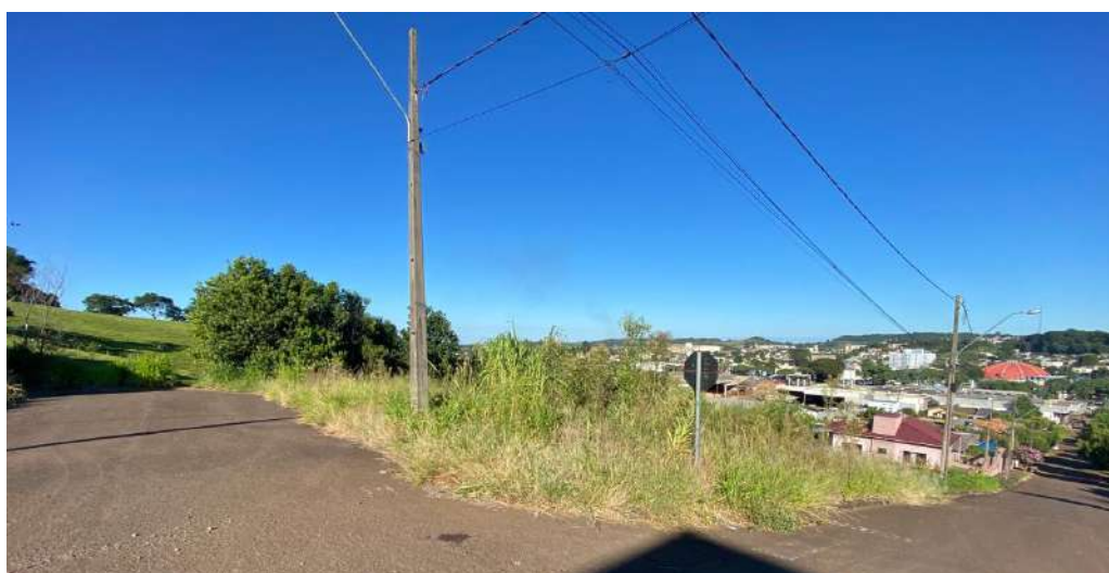
Figura 1- Poste rua José João Cembranel
