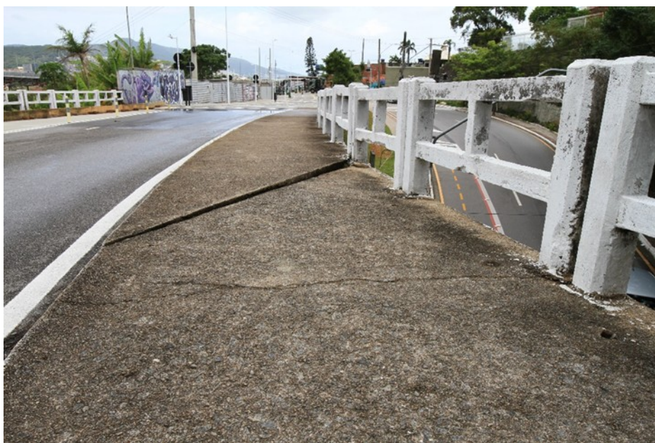
Figura 16: Vista do estrado - Detalhe de deformação exagerada da laje em balanço na junta
