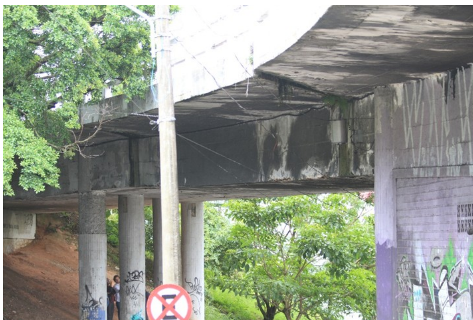
Figura 6: Vista lateral - Detalhe desnível na junta
