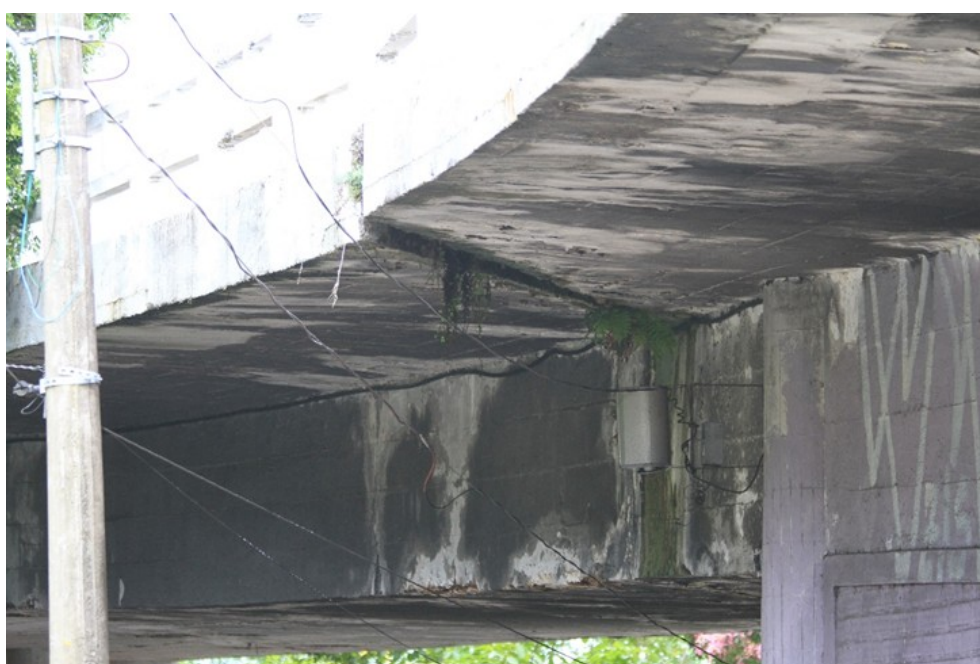
Figura 7: Vista lateral - Detalhe desnível na junta
