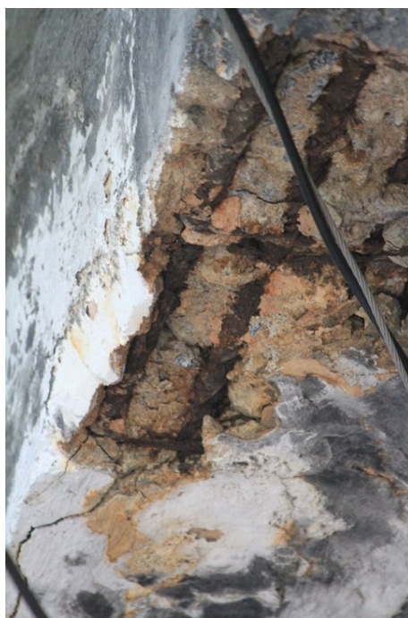
Figura 10: Detalhe da armadura com perda de seção
