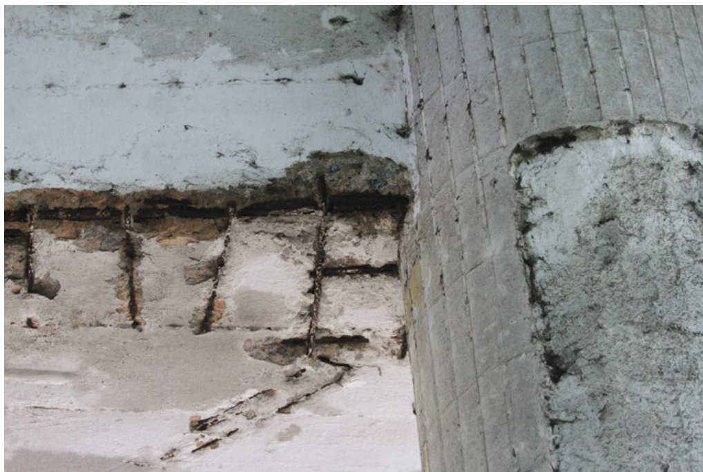
Figura 4: Detalhe de armadura exposta e oxidada
