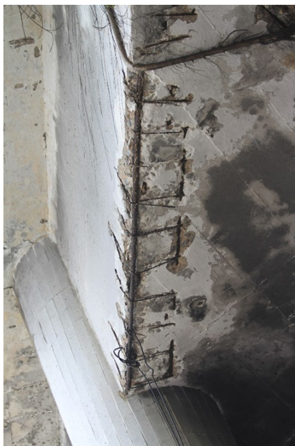
Figura 14: Vista inferior - armadura exposta oxidada
