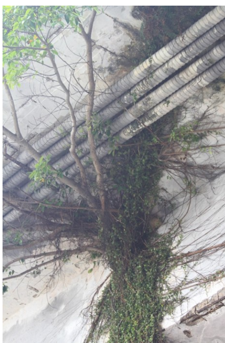
Figura 15: Detalhe de acúmulo de matéria orgânica em junta do tabuleiro
