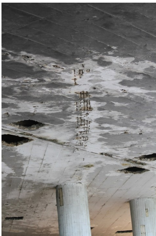
Figura 12: Vista inferior nas proximidades de junta - armadura principal exposta oxidada
