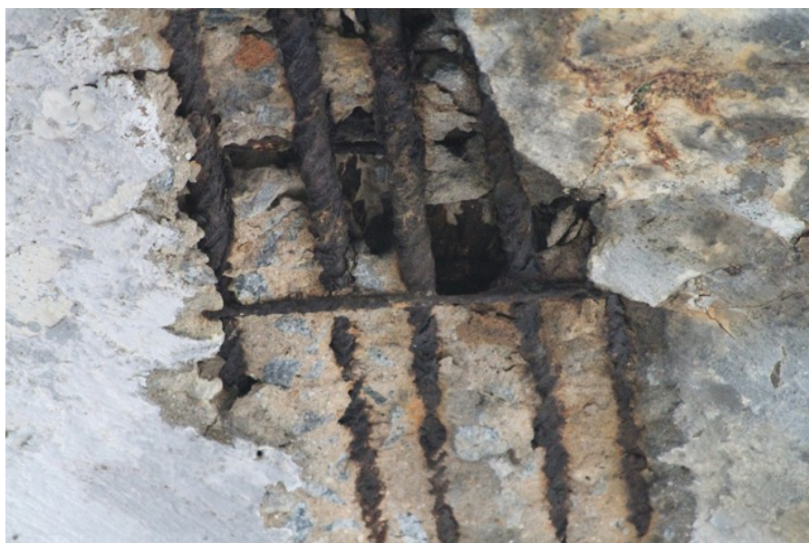
Figura 13: Detalhe armadura exposta oxidada - Vazio por ocorrência de ninho de pedra
