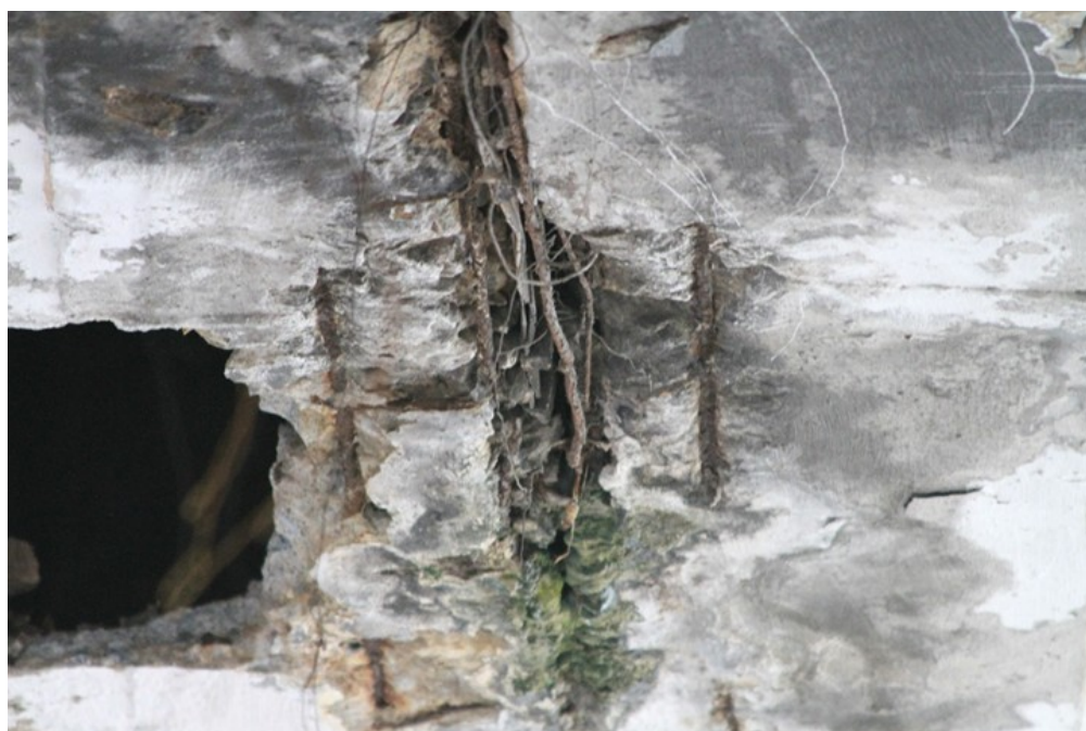
Figura 11: Detalhe de fundo da viga na junta - Armadura exposta oxidada e acúmulo de matéria orgânica
