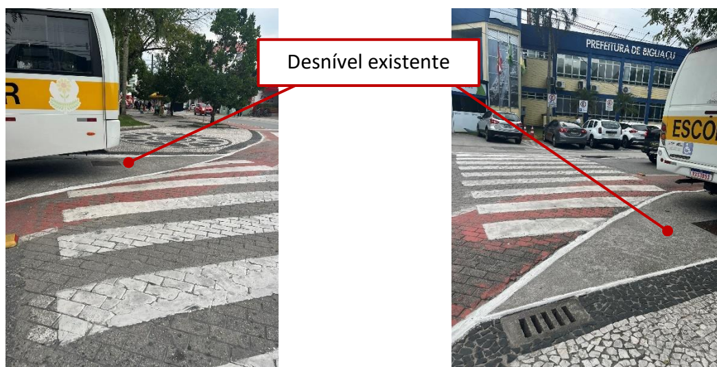
Figura 9 e Figura 10 - Desnível no piso entre a faixa elevada e a Praça Nereu Ramos.
