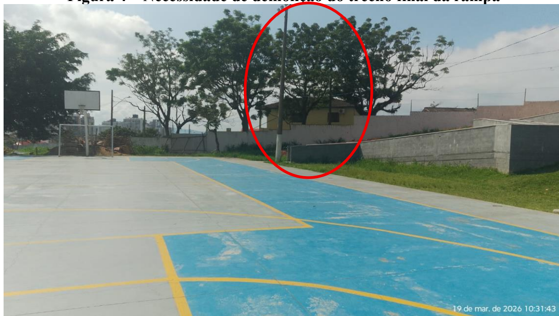
Figura 4 – Necessidade de demolição do trecho final da rampa
