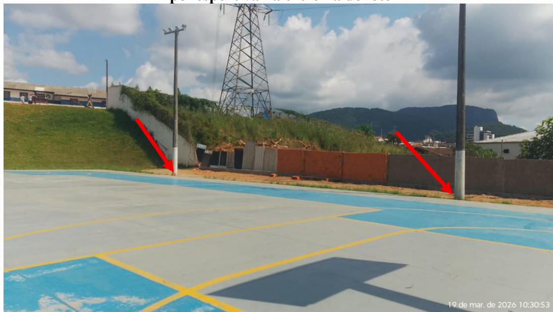
Figura 7 – Necessidade de relocação dos postes de iluminação da quadra poliesportiva na extrema do lote
