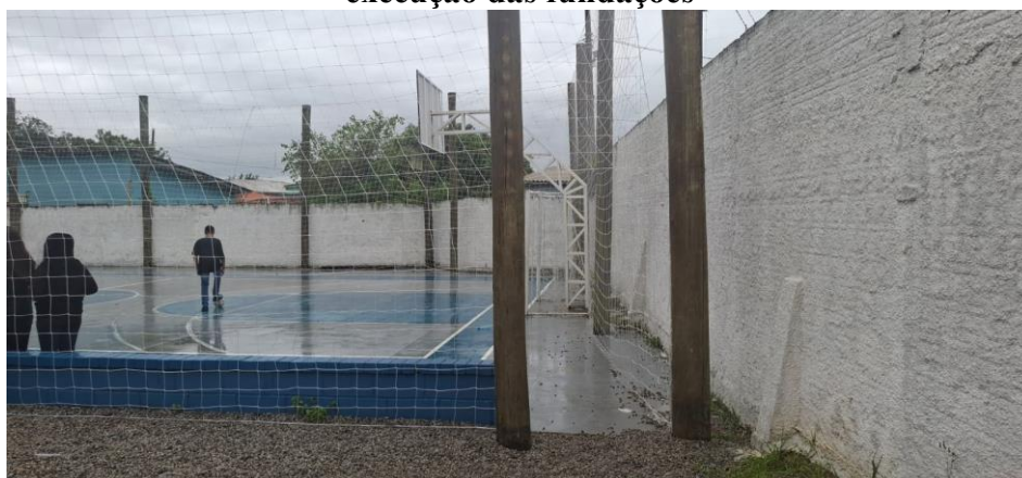
Figura 4 – Desalinhamento da quadra com a divisa permitindo facilmente à execução das fundações
