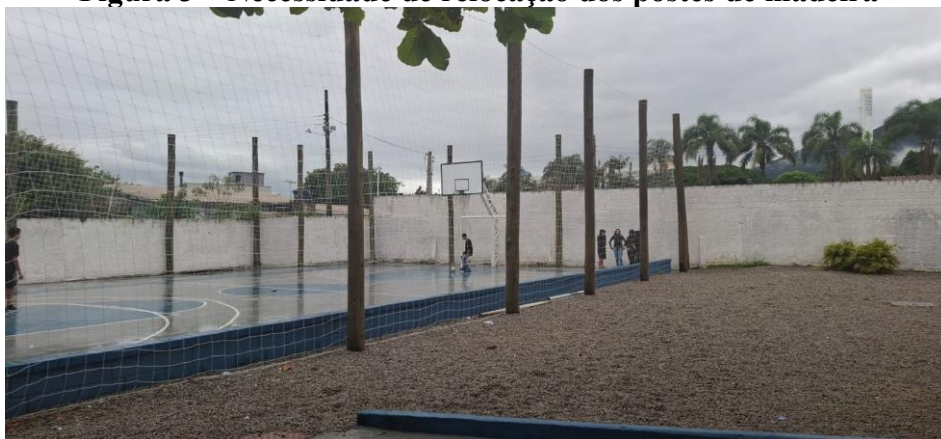
Figura 3 – Necessidade de relocação dos postes de madeira
