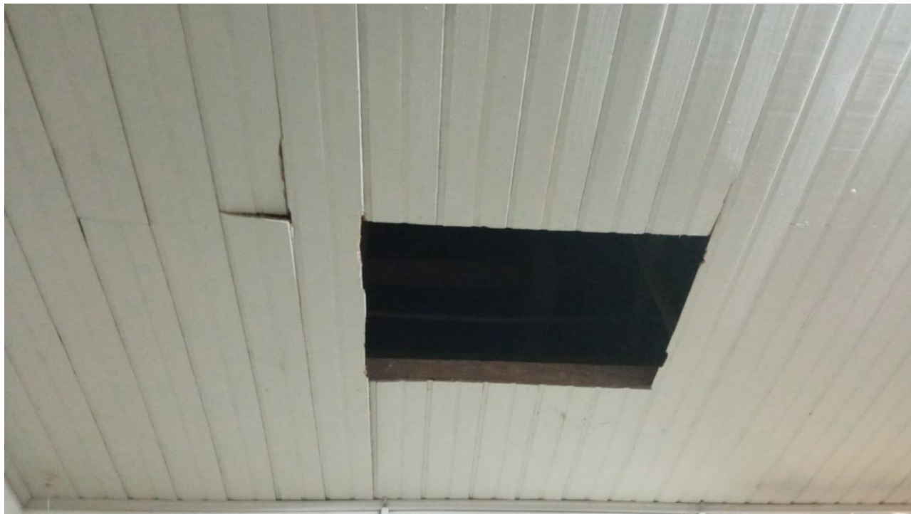
Foto 02: Forro danificado e acesso alçapão.
