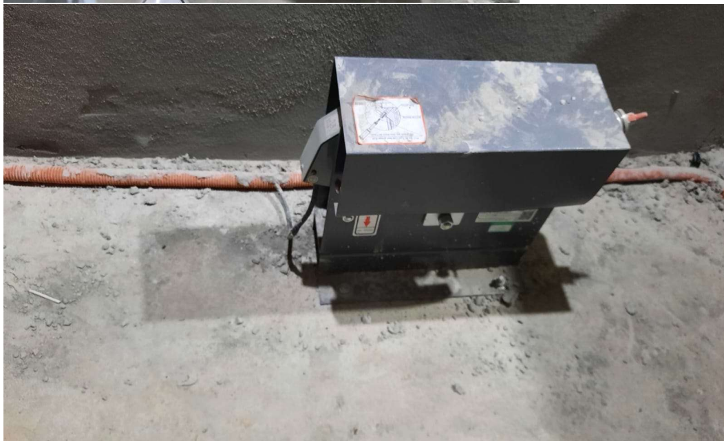
Figura 6. QUADRO DE COMANDO
