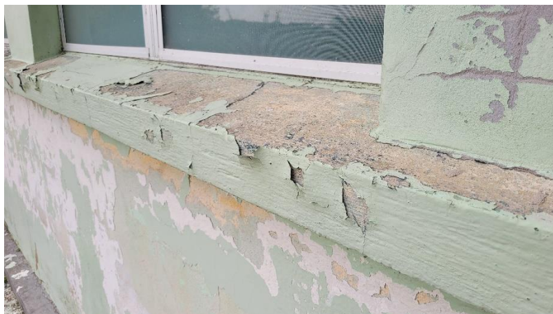
Figura 11: situação atual da pintura, evidenciando a necessidade de execução do preparo antes do recebimento de novas demãos
