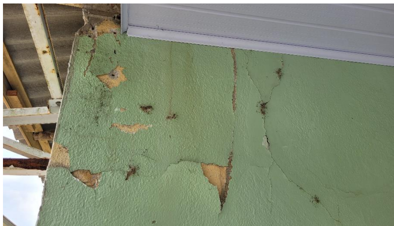
Figura 12: situação atual da pintura, evidenciando a necessidade de execução do preparo antes do recebimento de novas demãos
