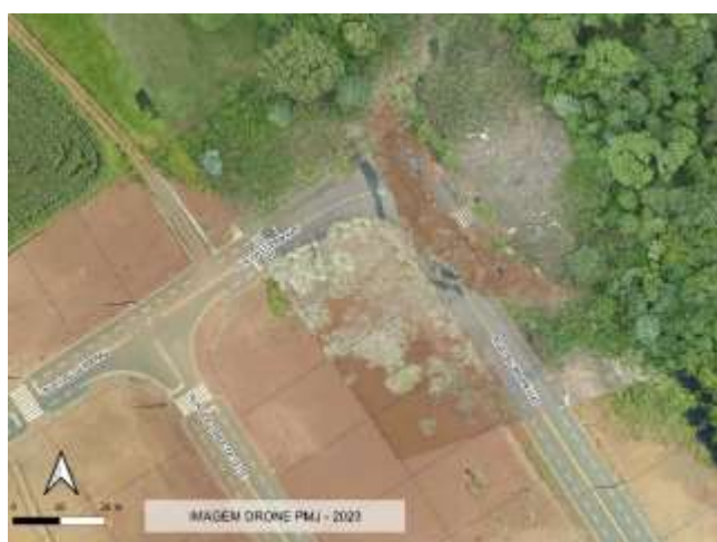
Figura 08 – Após rompimento e deslizamento do talude de aterro (Prefeitura Municipal de Joaçaba, 01 de novembro de 2023)
