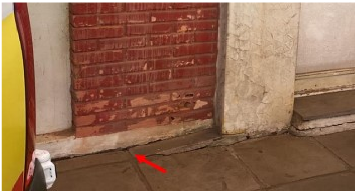
Figura 35 - Indício de recalque diferencial
