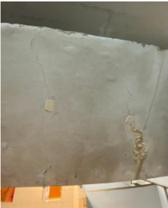
Figura 29 - Monitoramento rachadura 45 graus parede do banheiro feminino
