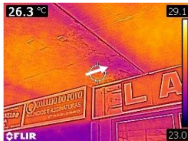
Figura 46 - Pontos de umidade na laje de cobertura na junta de dilatação estrutural
