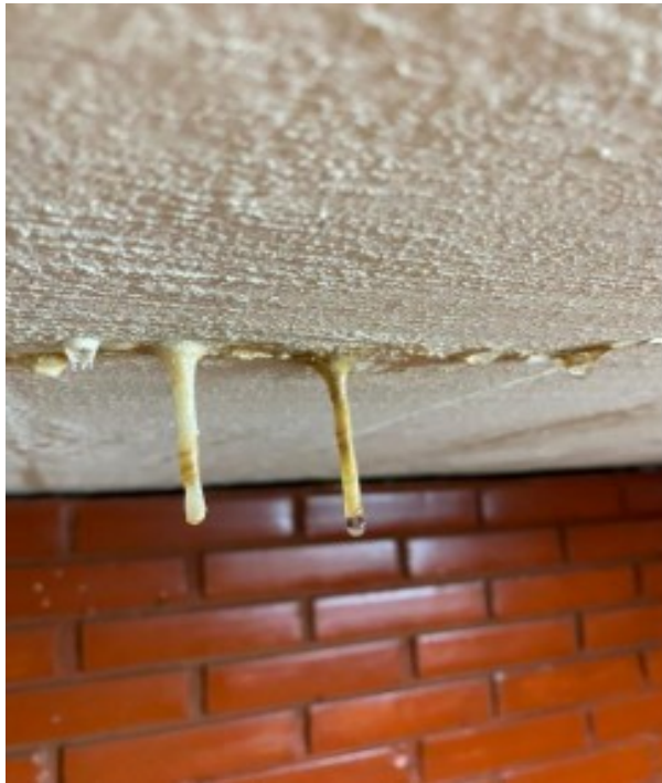
Figura 49 - Gotejamento pela fissura da laje do depósito
