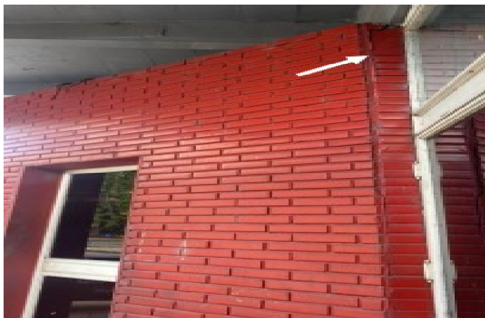
Figura 14 - Trinca 45° na alvenaria fachada frontal
