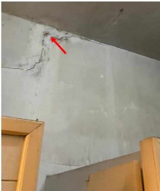
Figura 18 - Rachadura a 45º parede que divide o banheiro masculino e feminino
