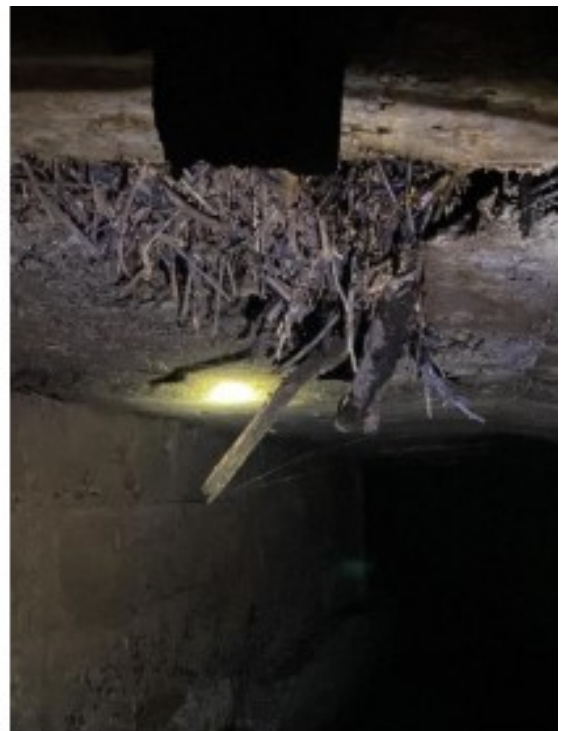
Figura 54- Laje da galeria com presença de raízes e sujidades
