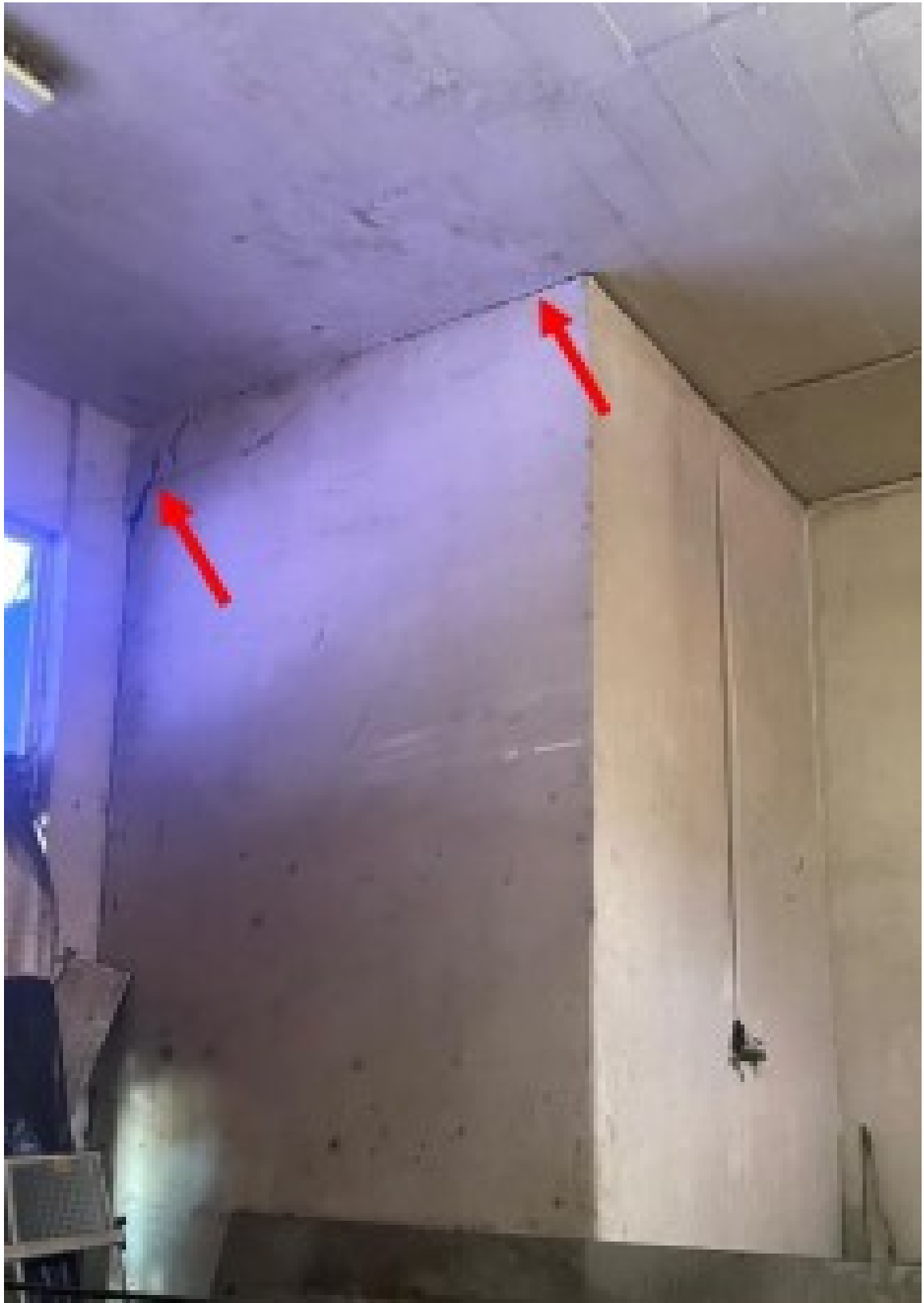
Figura 12- Trinca no encunhamento e a 45º na alvenaria
