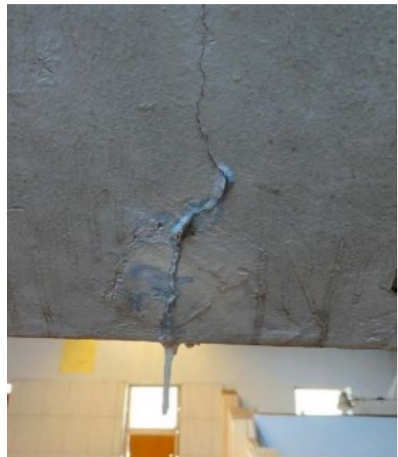
Figura 17 - Trinca com eflorescência na calha pluvial da viga V7
