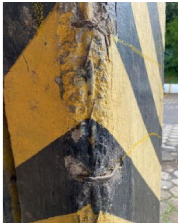
Figura 41 - Armadura exposta no pilar P3
