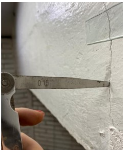
Figura 22 Fissura V7C com 0,15mm de espessura
