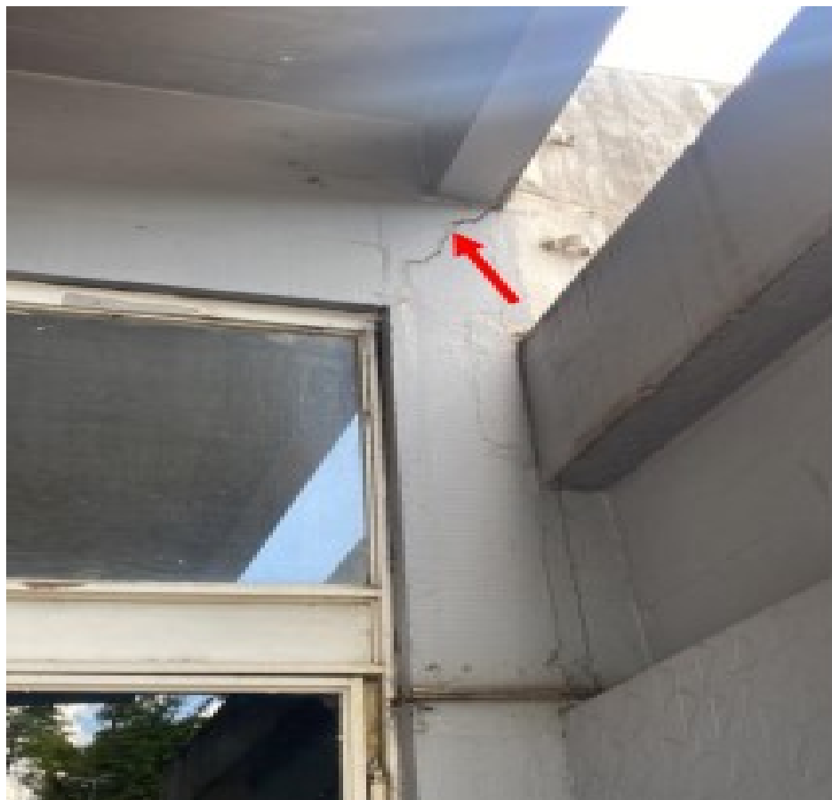
Figura 13 - Trinca 45° na alvenaria fachada frontal
