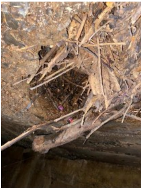
Figura 53 – Laje da galeria com presença de raízes
