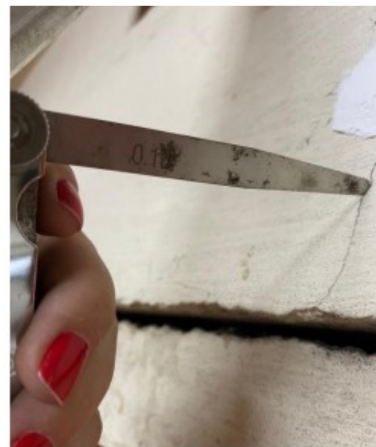
Figura 21 - Fissura viga V7A com 0,10mm de espessura
