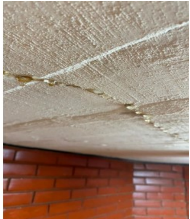
Figura 50 - Gotejamento pela fissura da laje do depósito
