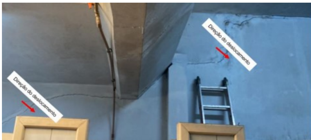
Figura 33 - Monitoramento fissura laje sala depósito em 12/01
