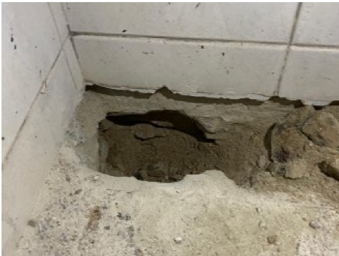
Figura 34 - Parede de alvenaria assentada direto sobre o piso
