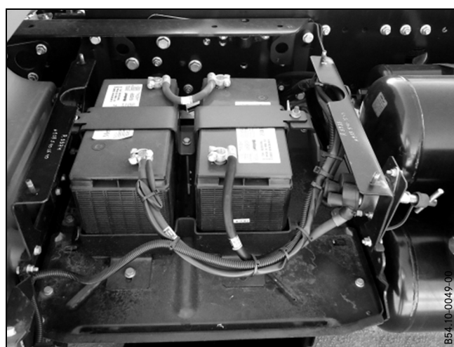
Caixa da bateria
