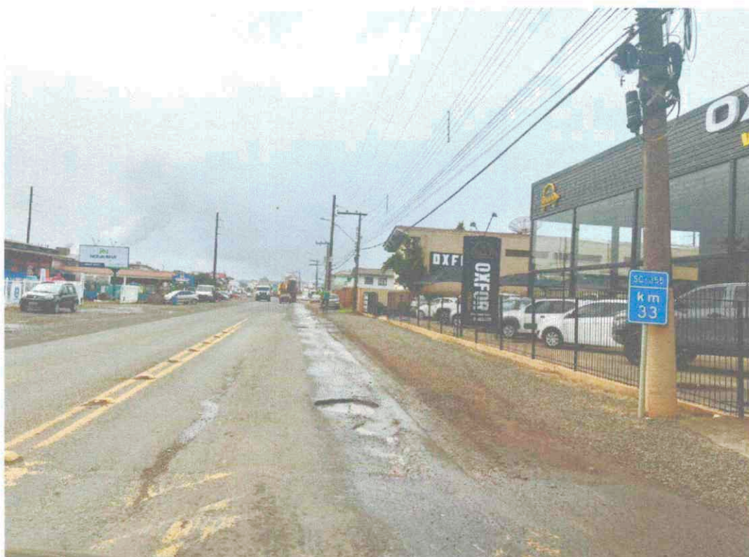
Figura 2 – Asfalto esburacado e com presença de deformações -Km 33
