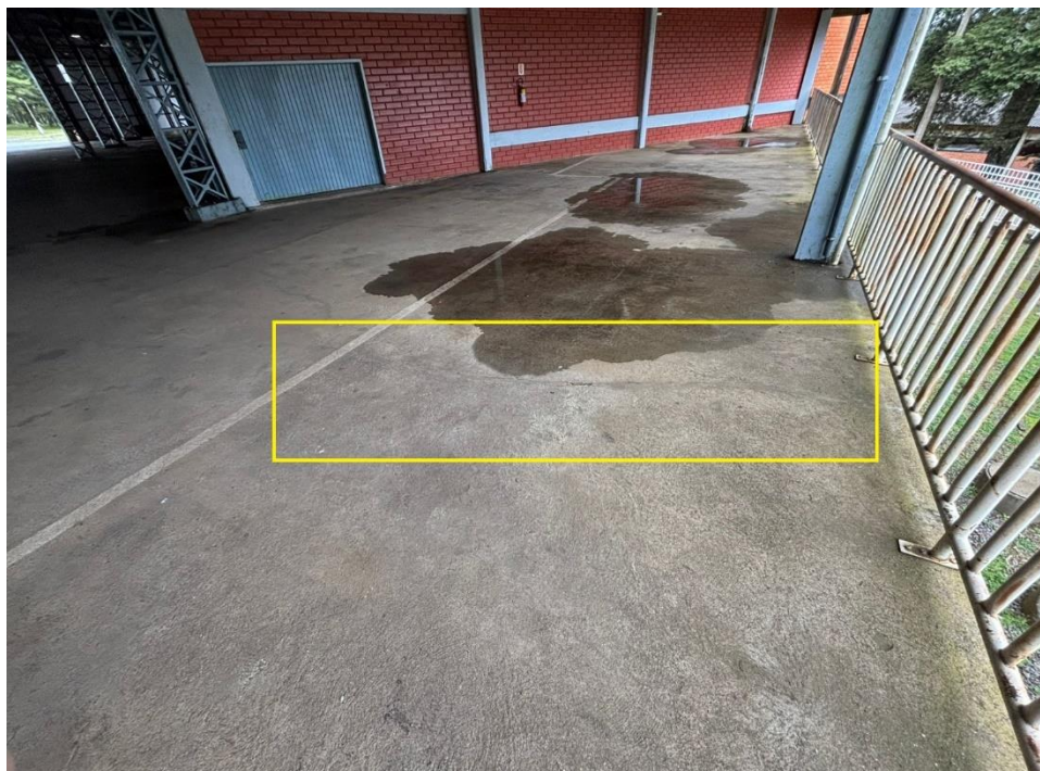
Figura – Fissura a ser reparada parte superior da laje
