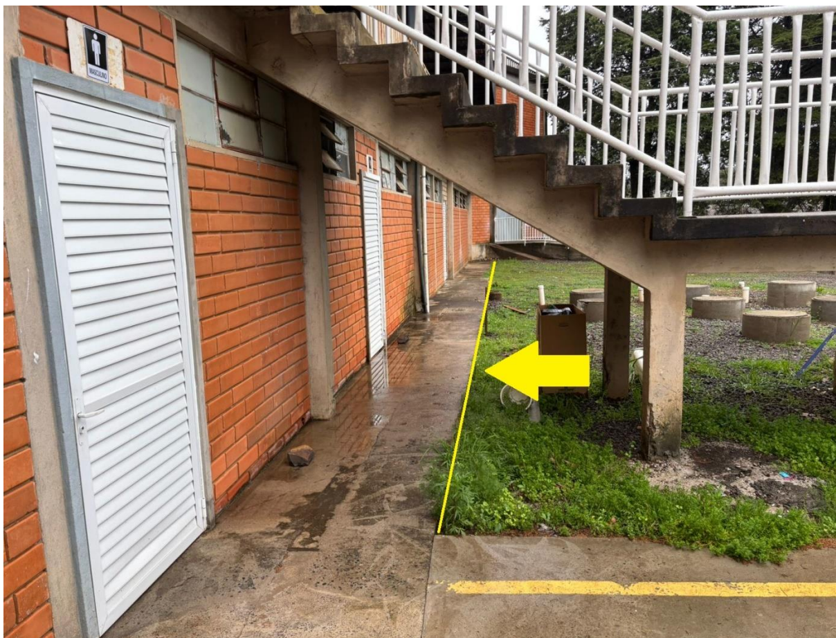
Figura – Calçada externa a ser demolida e reconstruída com 1,5 m de largura Conforme indicado em projeto, deverá ser construída uma calçada em concreto armado, com 6 cm de espessura em frente a escada de acesso ao pavimento superior, conforme apresentado na Figura a seguir.
