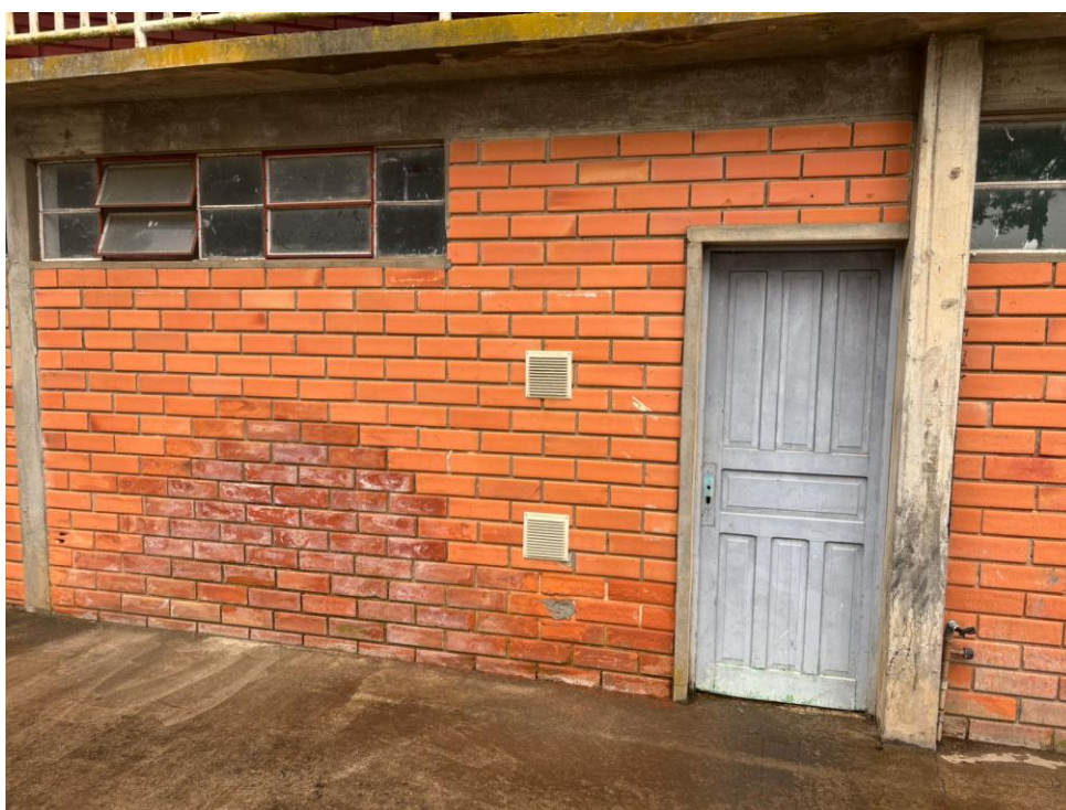
Figura – Vazamento de água a ser reparado
