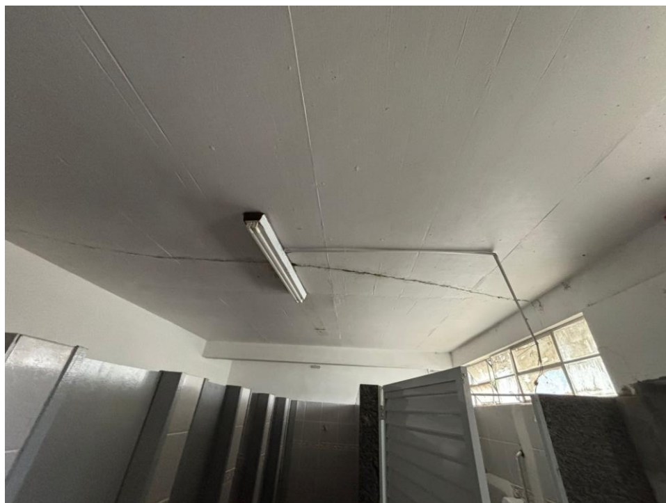
Figura- Fissura a ser reparada- parte inferior da laje
