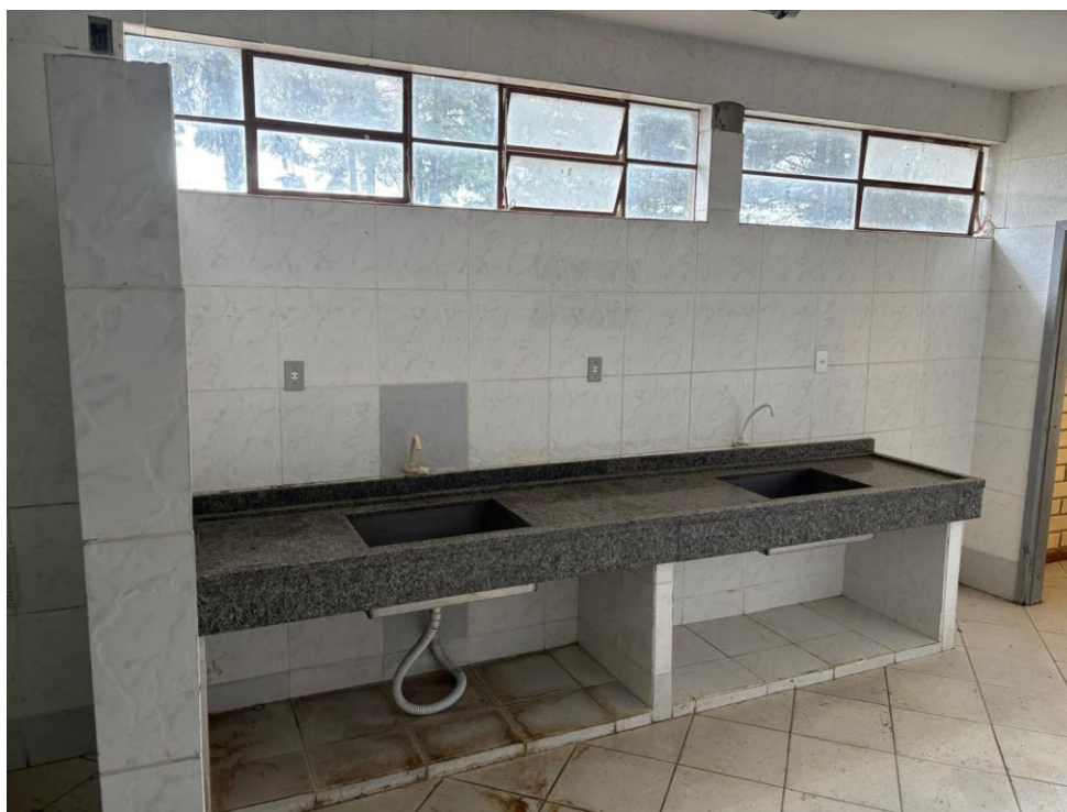
Figura – revestimento a ser substituído para acesso ao vazamento de água.
