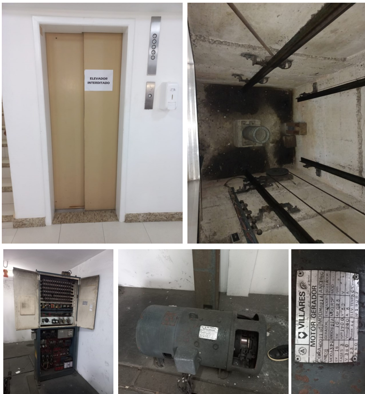
Figura 2: Vista gerais do elevador principal em sua situação presente, e de suas instalações para funcionamento (Triplan Engenharia, 2023)
