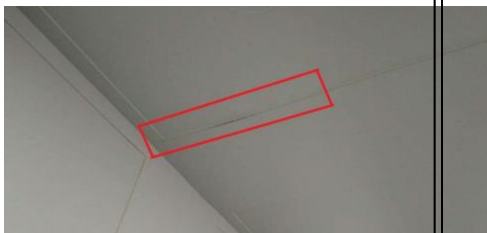
Foto 19: Junção dos módulos com infiltração - CIGERD Joinville.
