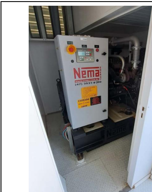
Foto 28: Gerador posicionado acima da chapa xadrez.
