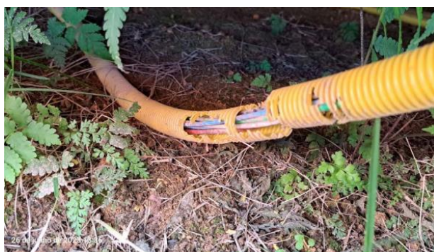
Foto 15: Mangueira corrugada deteriorada - CIGERD Tubarão.
