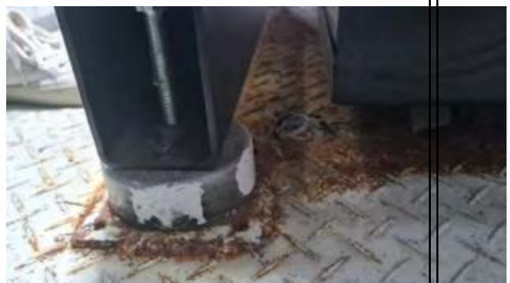
Foto 29: Ferrugem na chapa xadrez abaixo da sapata de fixação do gerador.
