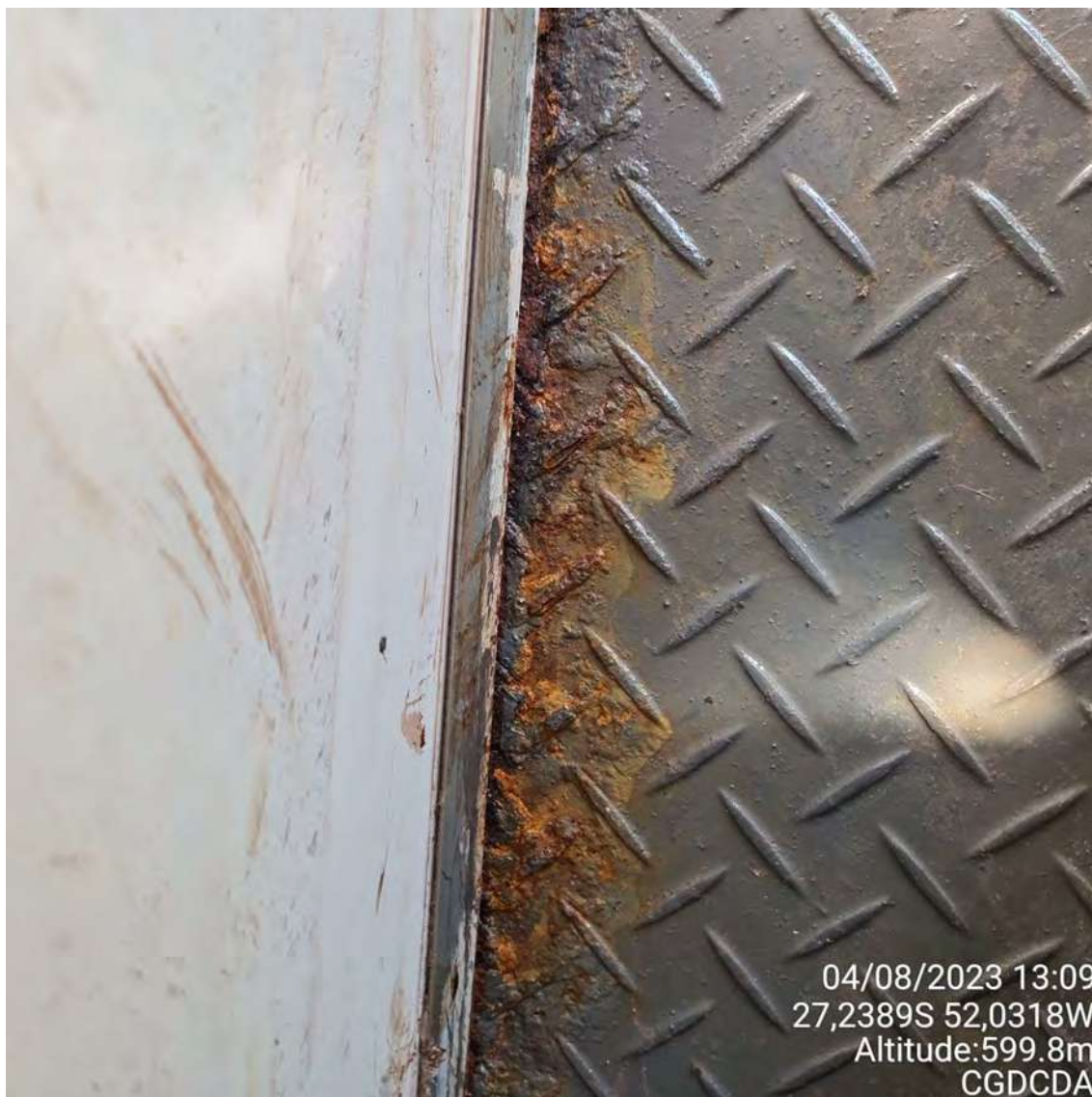
Figura 13 - Cozinha com piso enferrujado
