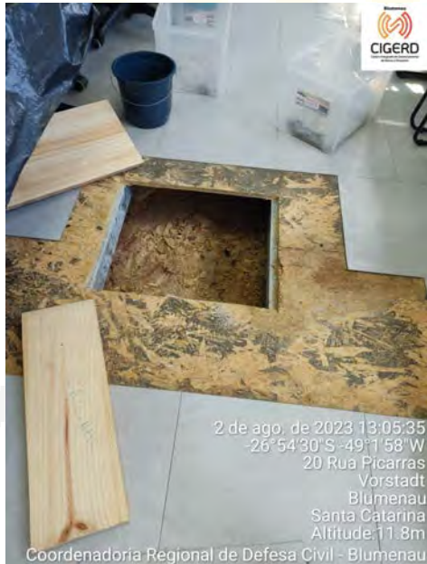
Figura 5. Piso Danificado na Sala de Operações
