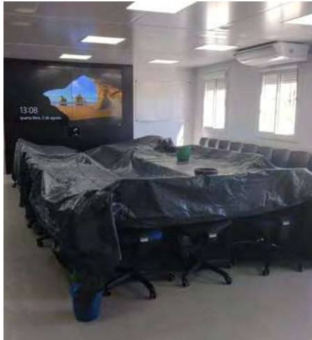
Figura 3. Mesa de Reunião coberta com lonas devido às goteiras
