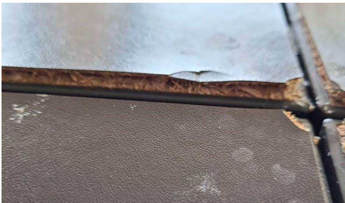
Figura 15 - Mesa danificada pela umidade
