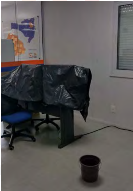
Figura 6. Goteira na Sala de Coordenação Regional
