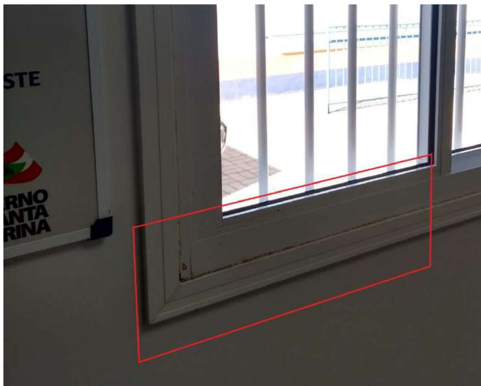
Figura 1. Infiltração pela janela na Sala de Situação.
