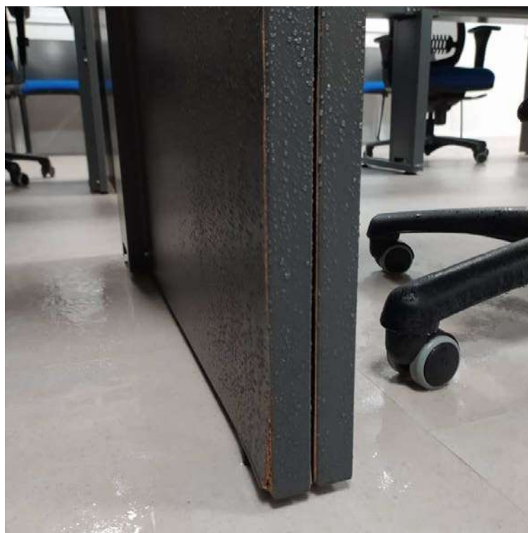
Figura 4. Deterioração da mesa devido a infiltração.
