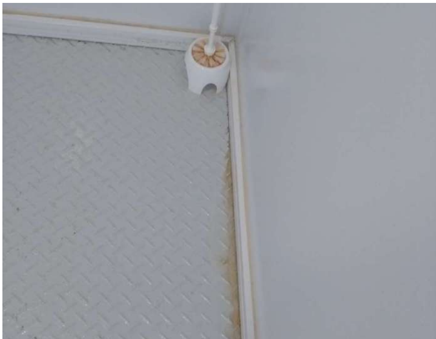
Figura 6. Infiltração na parede do banheiro.
