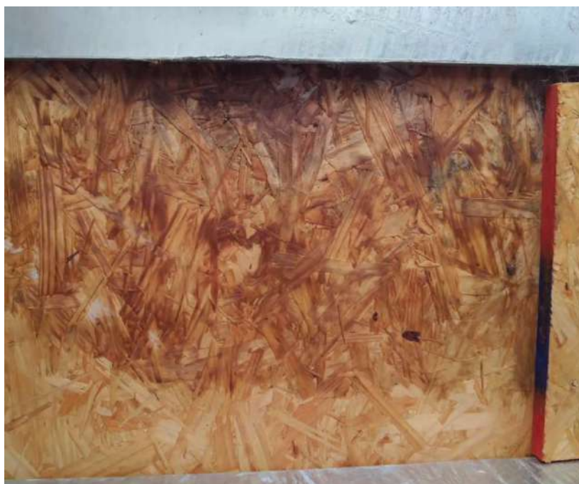
Figura 21. Placa OSB com umidade.
