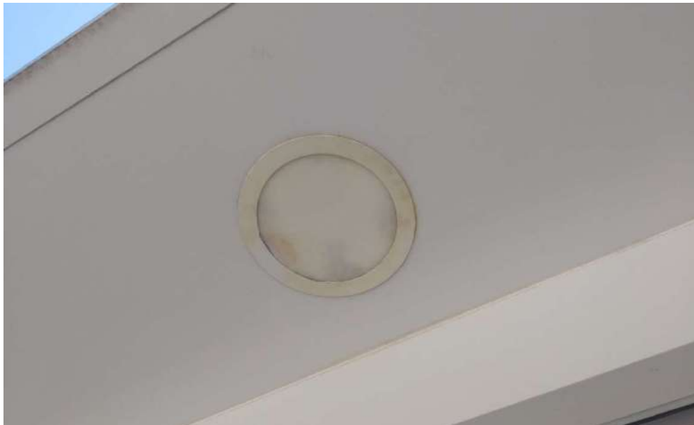
Figura 5. Luminária com infiltração.
