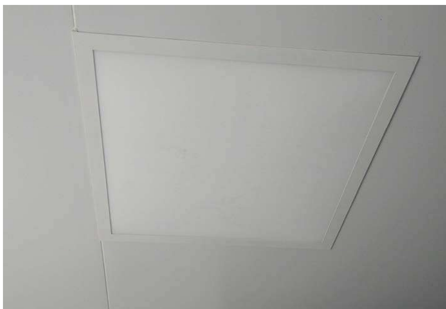
Figura 48. Luminária com infiltração.
