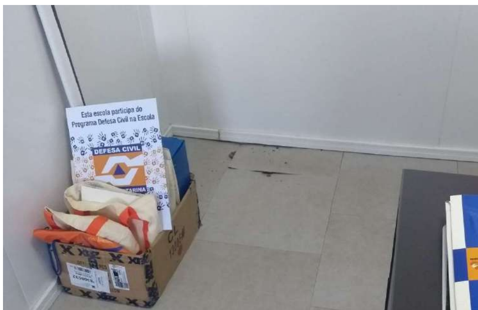
Figura 10. Deterioração do piso na sala do Coordenador.
