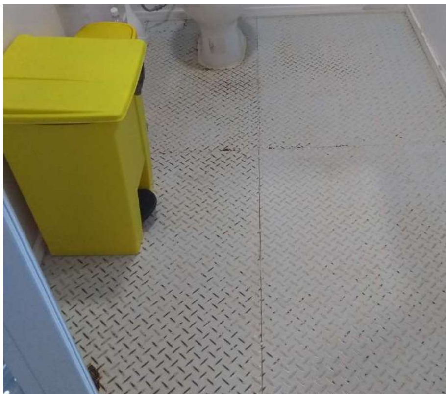
Figura 17. Ferrugem na chapa xadrez no banheiro.
