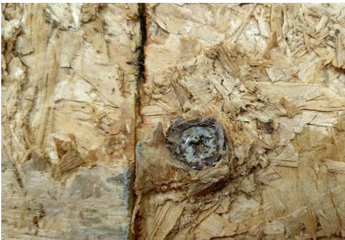
Parafuso oxidado pela umidade.
