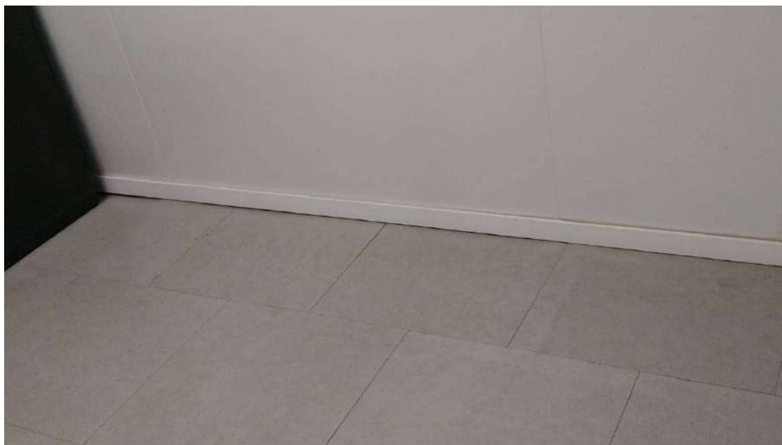
Figura 35. Afundamento no piso da recepção.
