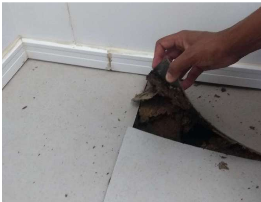
Figura 11. Deterioração do piso na sala do Coordenador.
