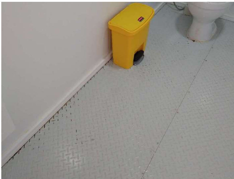
Figura 43. Ferrugem no piso de chapa xadrez.
