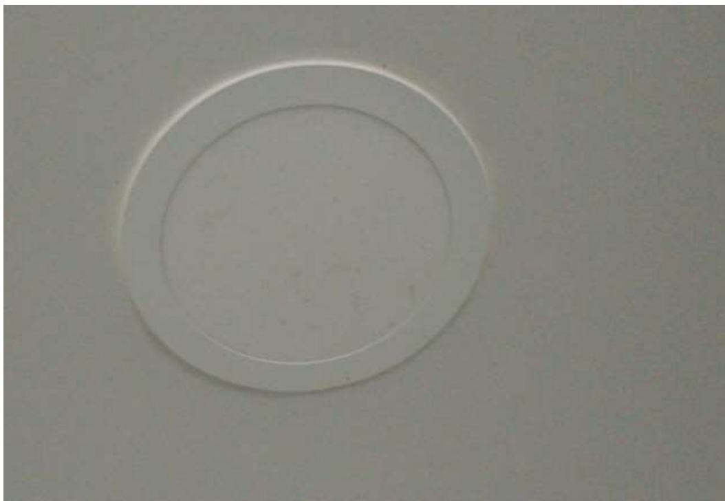
Figura 33. Luminária com umidade.
