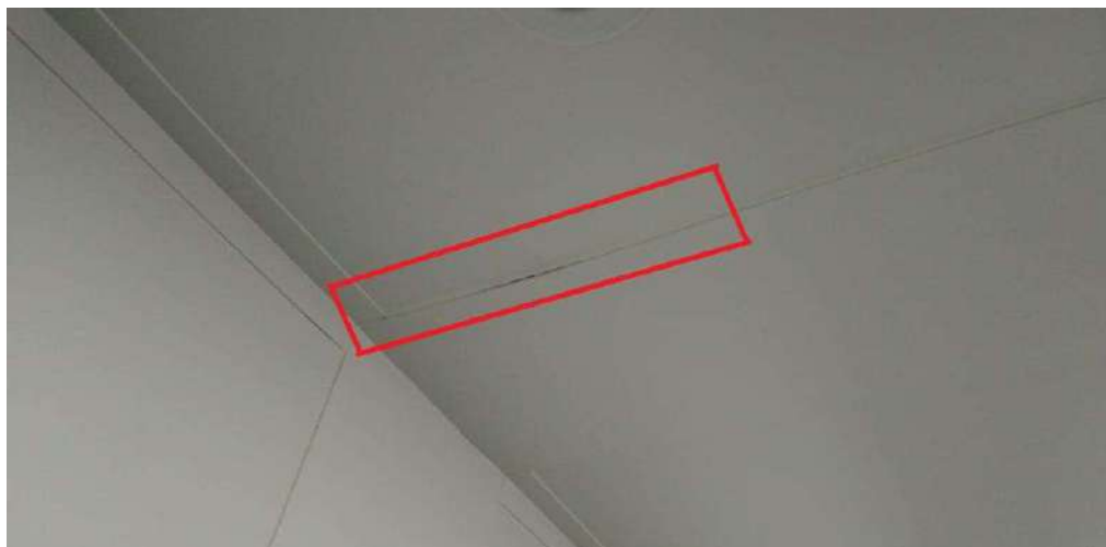
Figura 34. Ocorrência de mofo no encontro entre placas.
