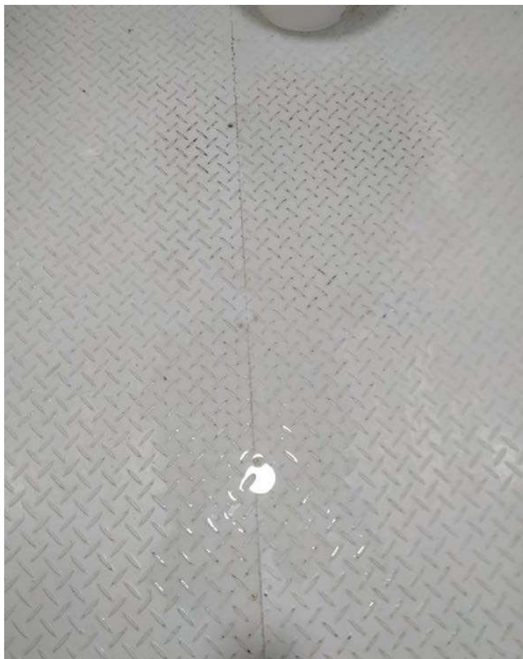
Figura 37. Acúmulo de água no piso do banheiro.
