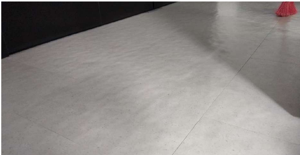
Sinais de ondulações no piso, revelando o inchamento do painel OSB.
