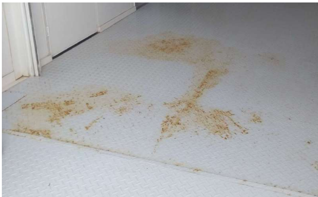
Figura 2. Ferrugem no piso de chapa xadrez.
