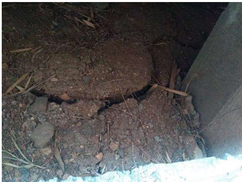
Figura 27. Fenda no solo de fundação do centro regional.
