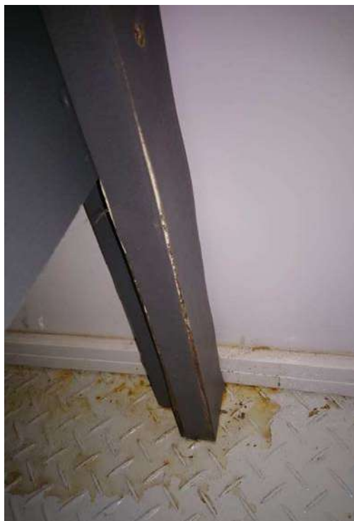
Figura 7. Deterioração na estrutura do beliche.
