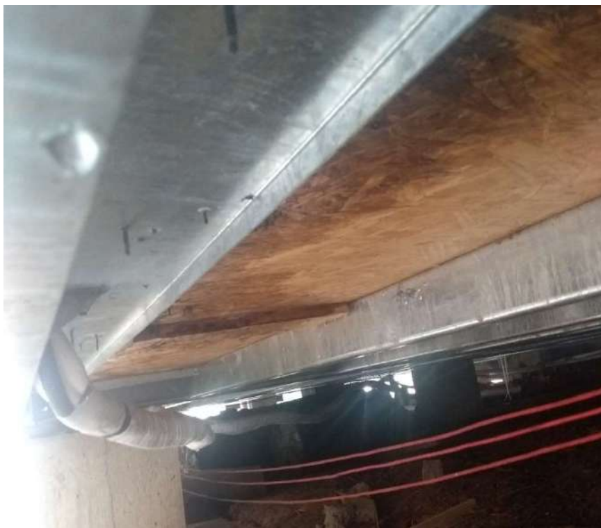
Figura 22. Placa OSB com umidade.
