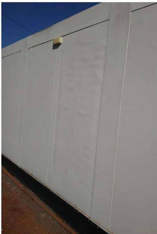
Figura 12. Possível infiltração na placa de vedação.
