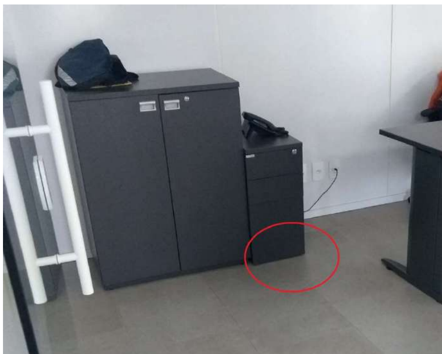
Figura 15. Região com problema no piso, sala Coordenador.
