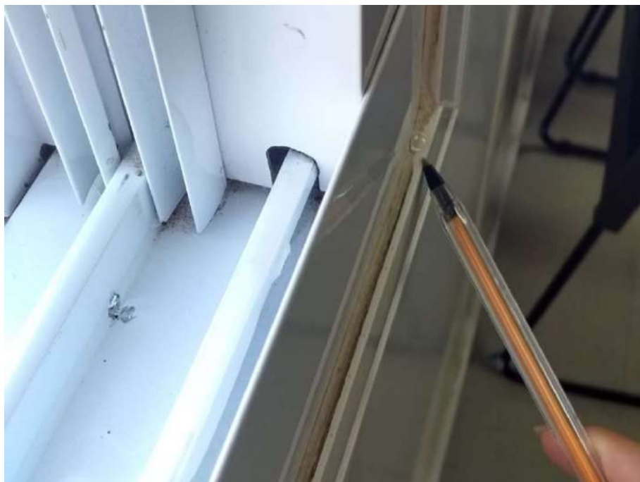
Figura 14. Infiltração pela janela.
