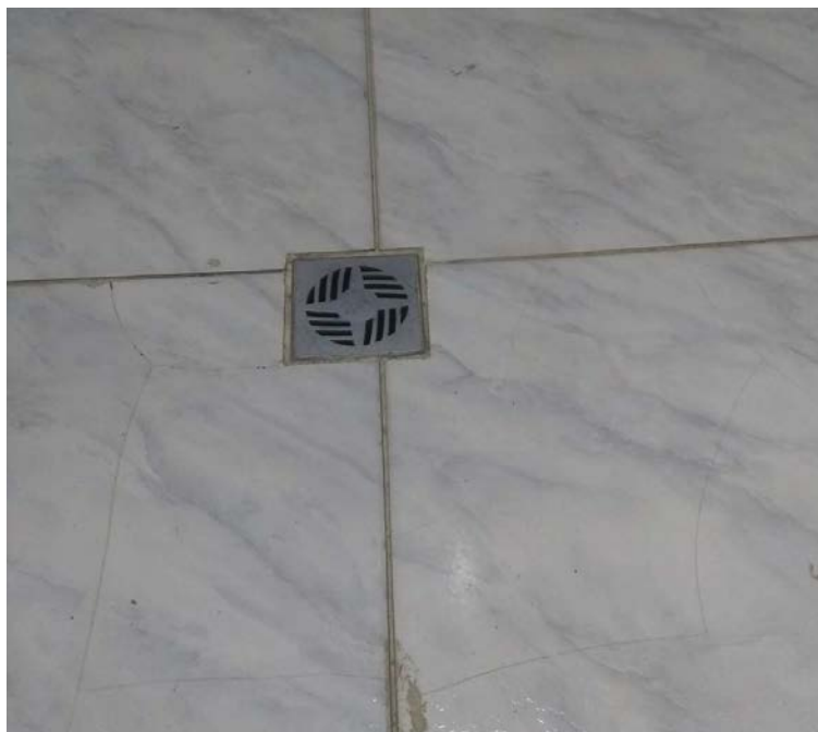
Figura 16. Revestimento cerâmico quebrado.
