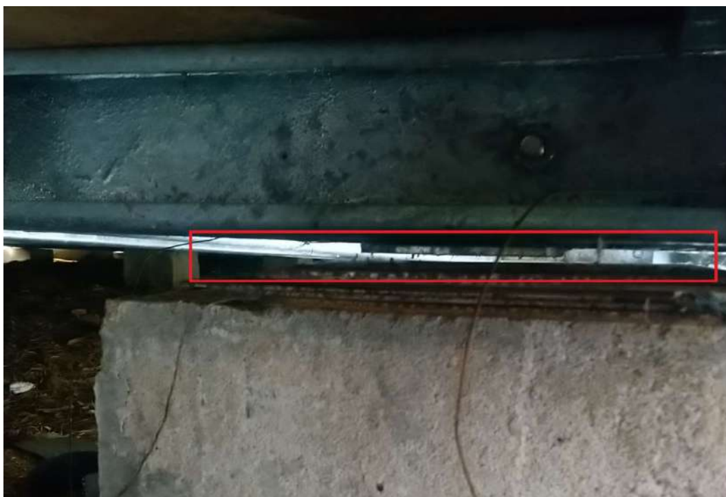
Figura 25. Vão entre as placas metálicas e a fundação.
