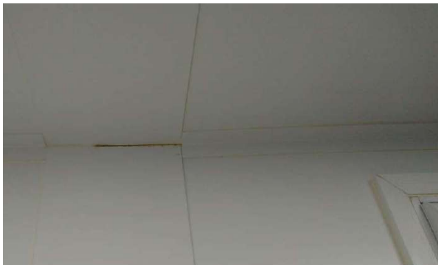
Figura 28. Ferrugem no teto.
