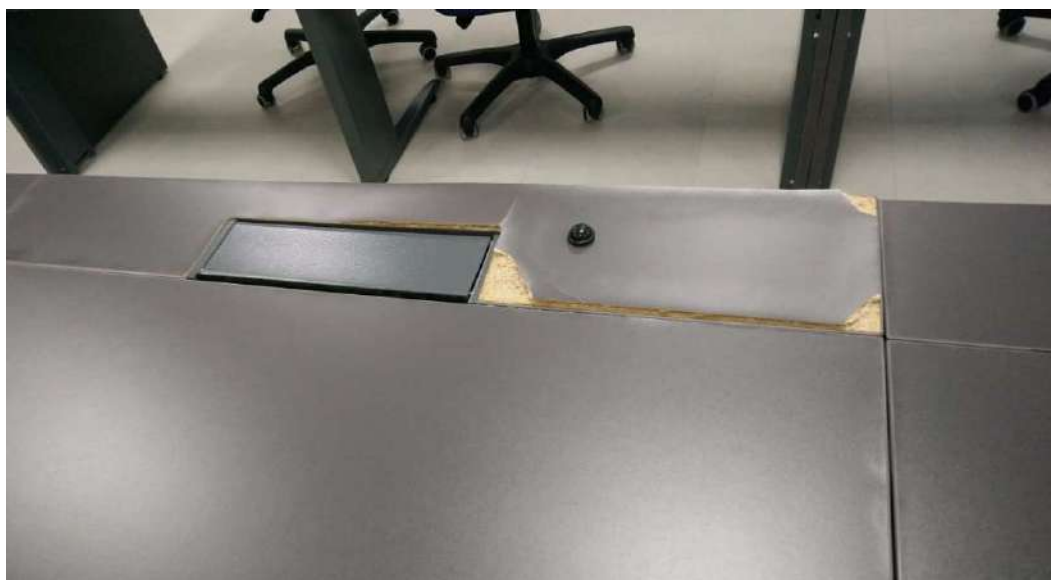
Figura 46. Deterioração da mesa da sala de situação.
