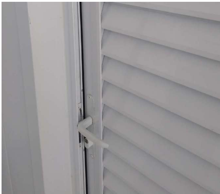
Figura 8. Porta do depósito.
