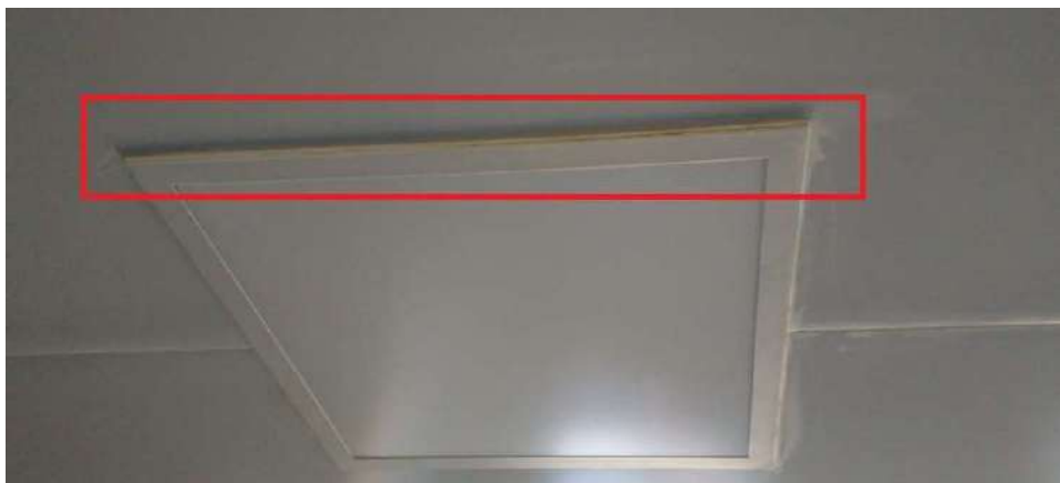
Figura 42. Infiltração pela luminária.
