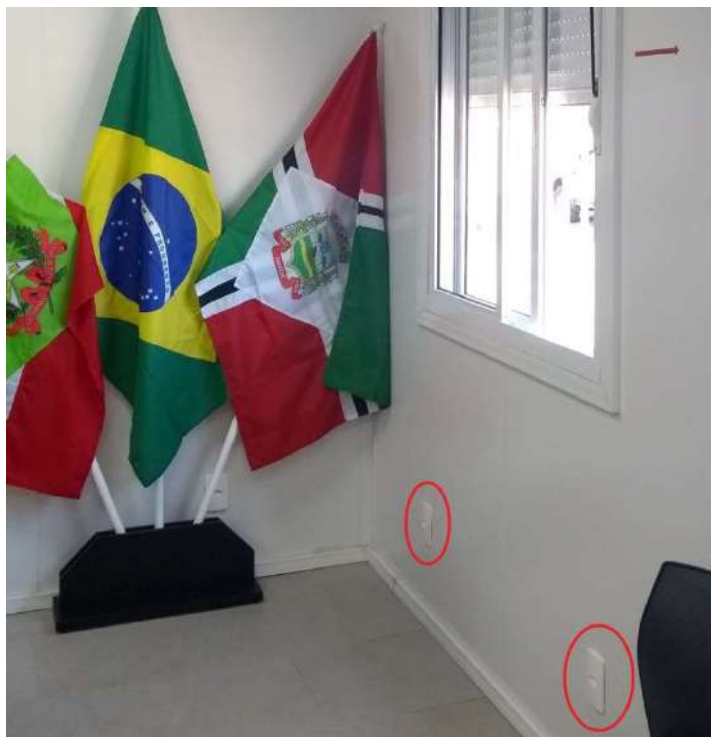
Figura 13. Tomadas nas quais ocorrem infiltração.
