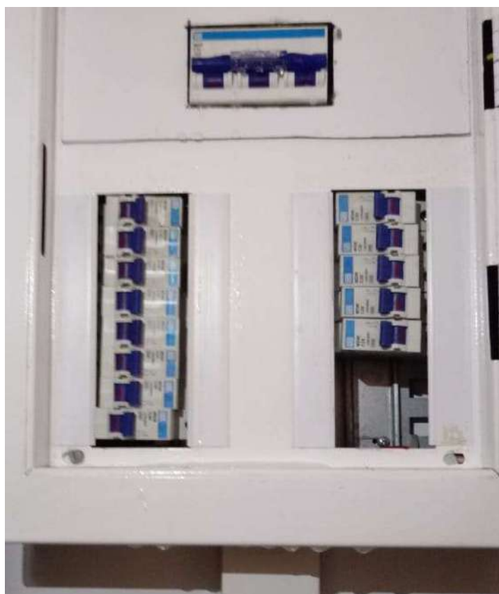
Figura 19. Infiltrações na caixa de disjuntores.
