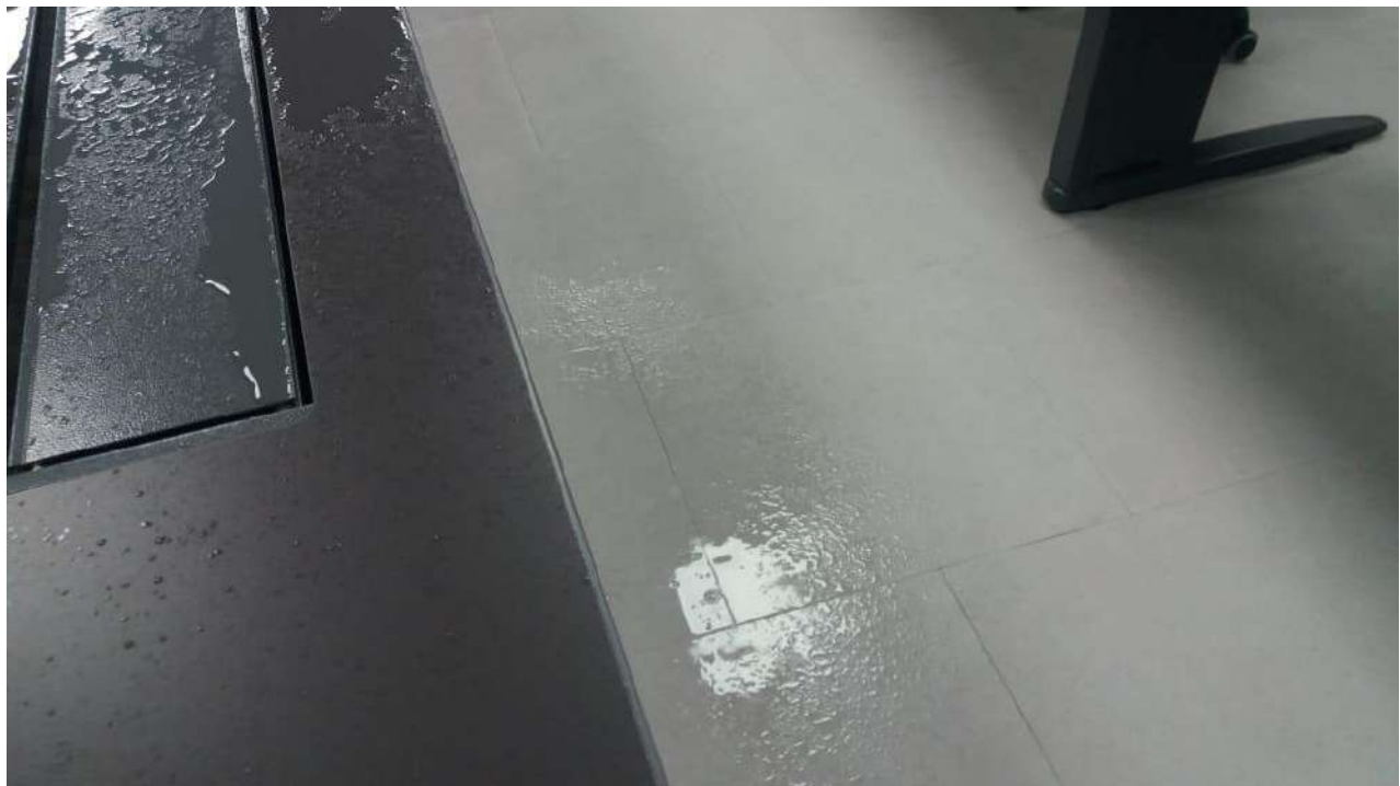
Figura 4. Interno - gotejamento - Situação em 03.09.2018, banco de dados DC
