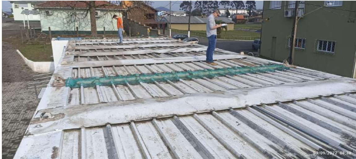
Figura 6. Cobertura - falha de proteção entre os módulos, autores.
