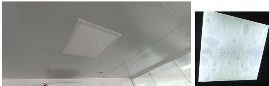
Figura 20. Sala de Monitoramento - detalhe da luminária.
