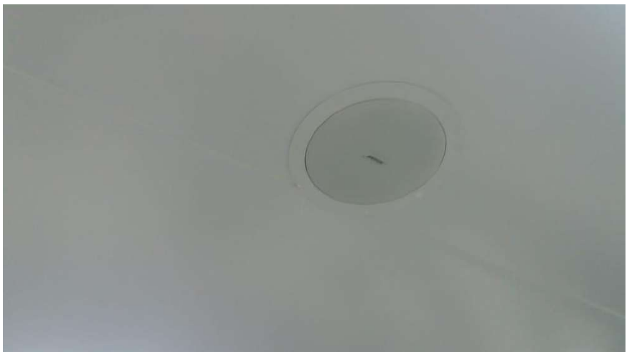
Figura 5. Interno - gotejamento pela luminária - Situação em 03.09.2018, banco de dados DC
