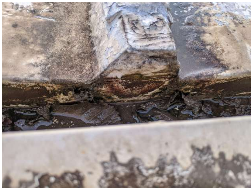
Figura 14. Impermeabilização realizada na ponta da telha trapezoidal com falha, autores.
