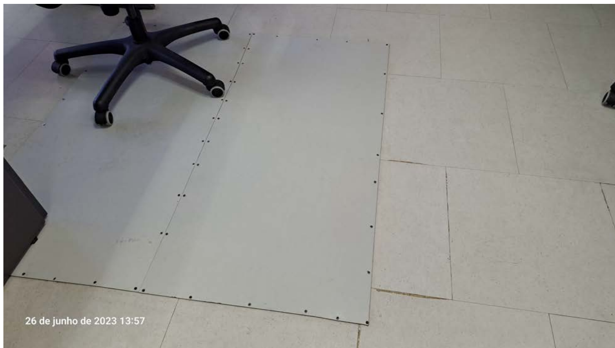
Figura 16 - Piso degradado - Visando o uso, foi instalado uma chapa metálica
