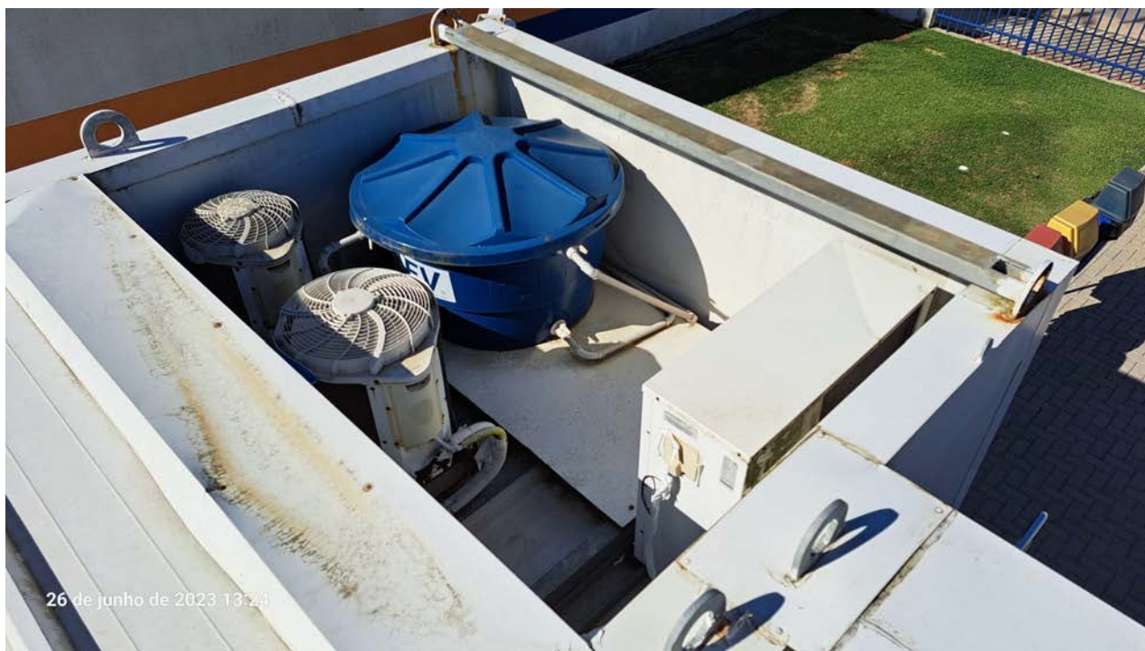
Figura 4 - Cobertura metálica - Alguns pontos apresentam sinais de ferrugem
