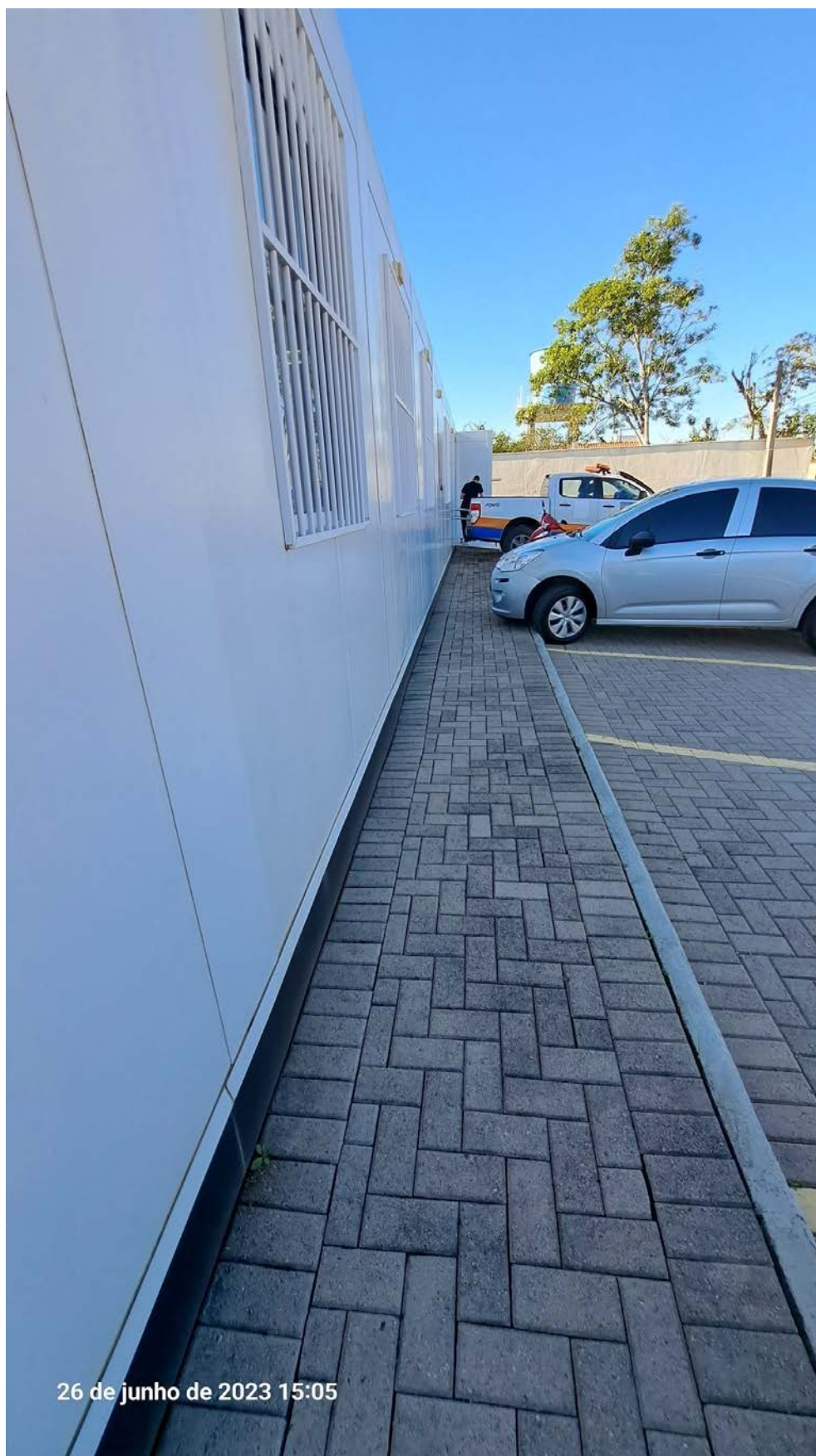
Figura 9 – Descolamento do acabamento da saia - permite a entrada de água na parede.
