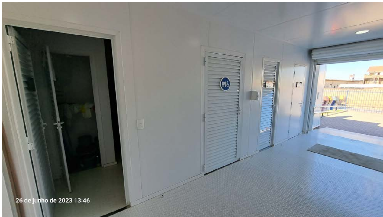
Figura 25 - Piso externo apresenta pontos de ferrugem - Pintura recente
