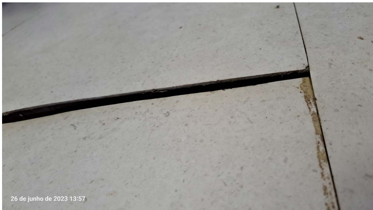
Figura 17 - Piso degradado - placa OBS danificada
