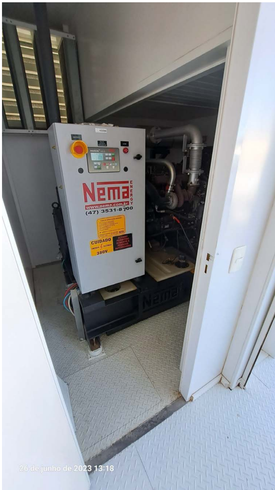
Figura 30 – Sala do gerador
