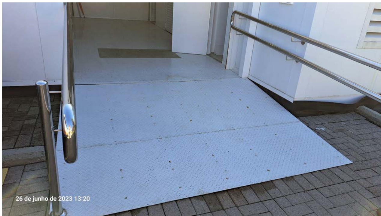
Figura 26 - Piso externo apresenta pontos de ferrugem - Pintura recente
