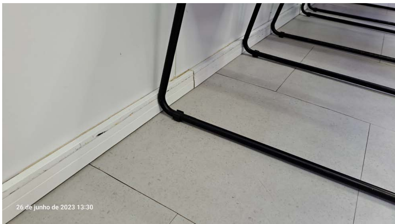
Figura 13 – Descolamento do rodapé e piso afundando
