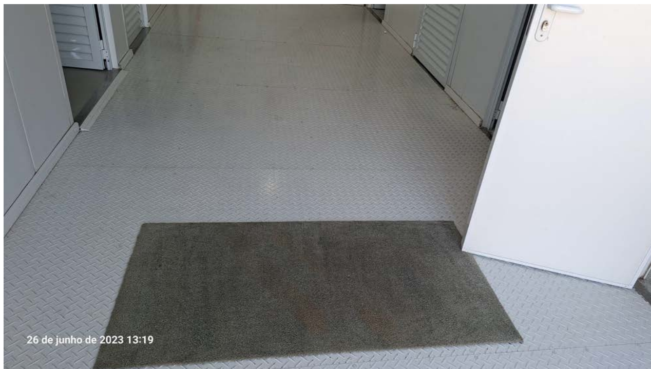
Figura 27 - Piso externo apresenta pontos de ferrugem - Pintura recente
