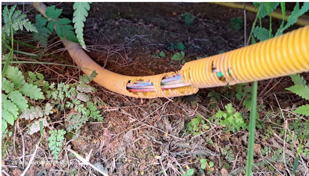
Figura 28 – Tubulação corrugada elétrica danificada - Necessário substituição por material apropriado
