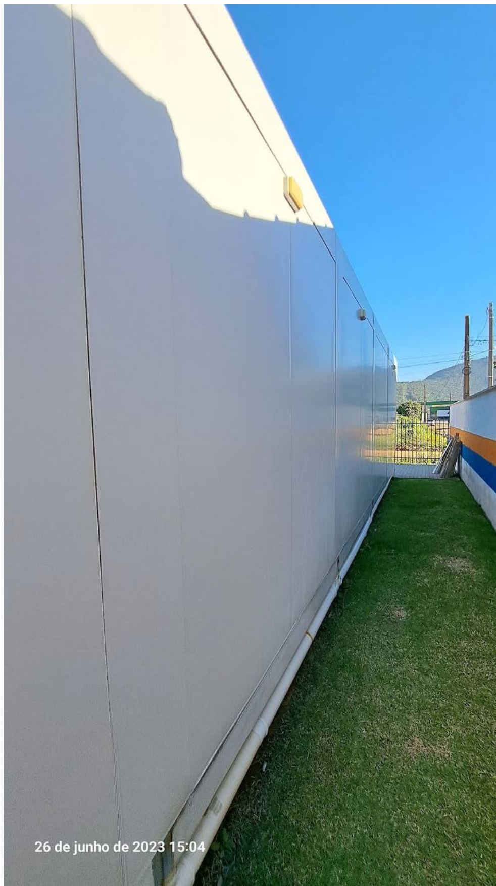
Figura 11 – Descolamento da saia de proteção
