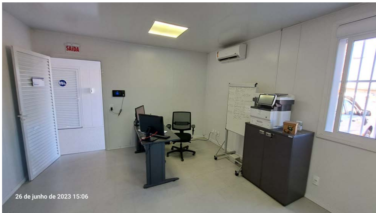
Figura 20 - Piso com ondulação
