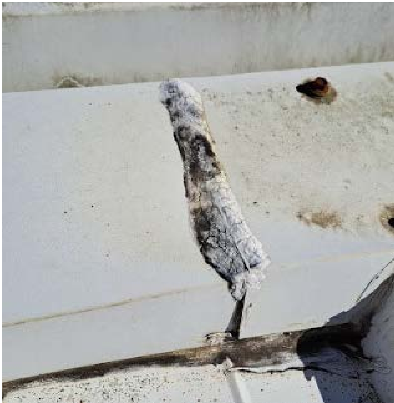
Figura 7 – Junção entre material - na proteção observa-se a falta de fixação por parafuso ou arrebite
