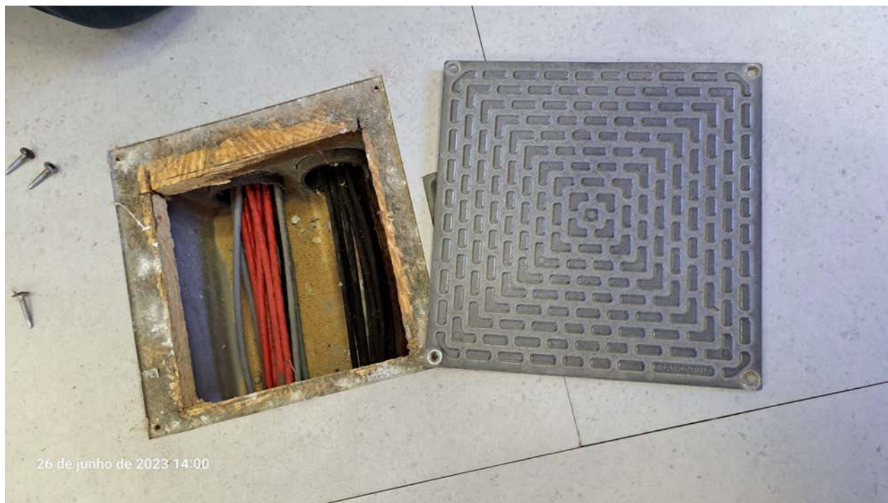
Figura 19 - Caixa de passagem - elétrica e rede
