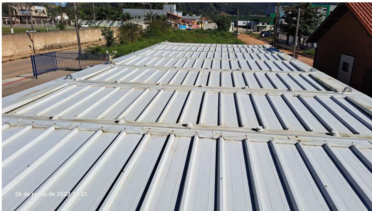
Figura 3 - Cobertura metálica - destaca-se que entre cada módulo é um ponto propício de infiltrações
