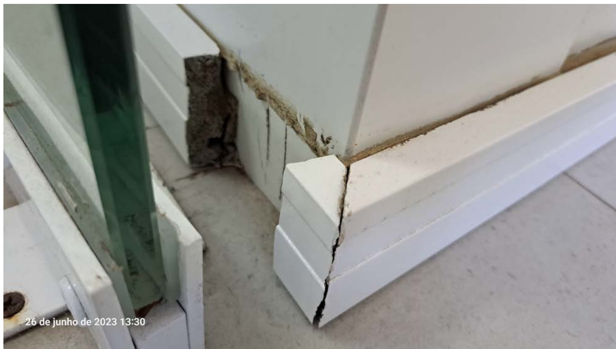
Figura 14 – Trecho sem rodapé, no local observou-se umidade no material
