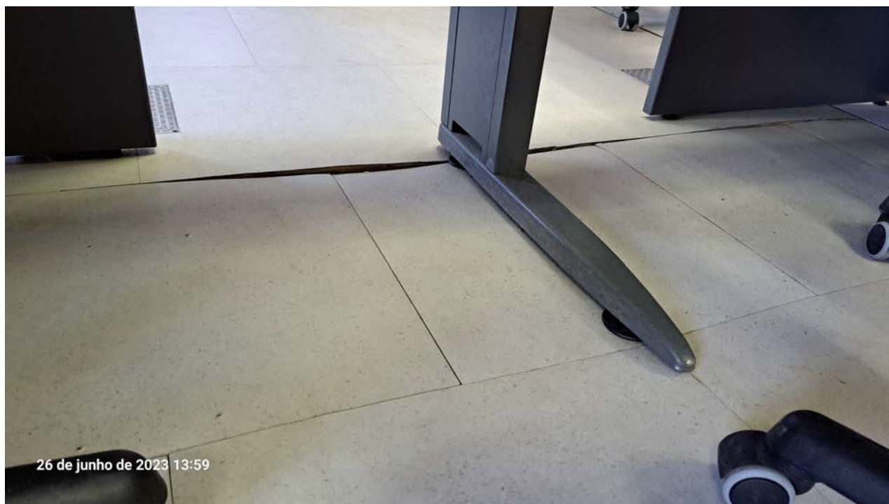
Figura 15 – Piso em placa OBS danificado em função das infiltrações da cobertura
