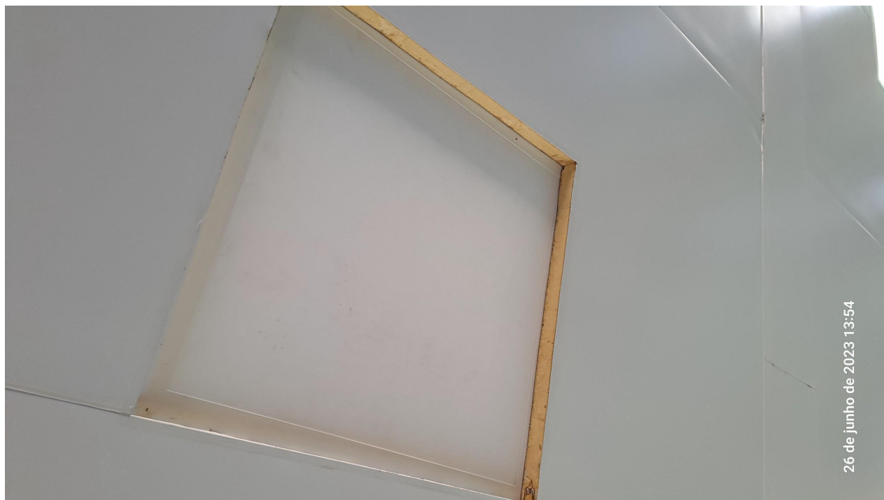
Figura 22 - Luminária removida em função de curto circuito causado pelo acúmulo d'água
