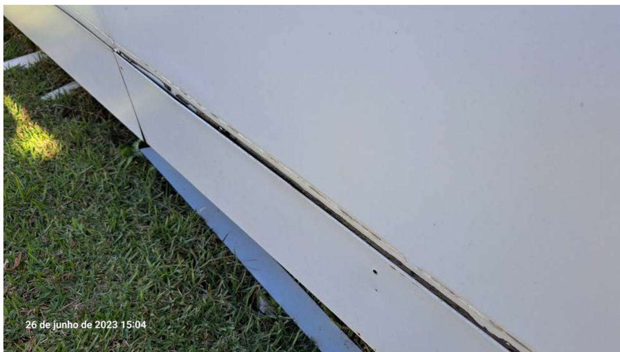
Figura 12 – Descolamento da saia de acabamento
