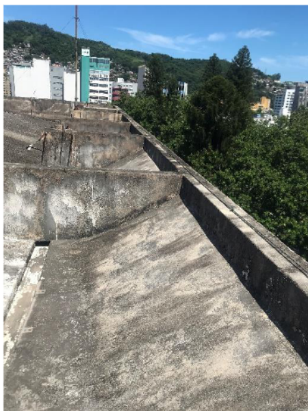
Malha de captação frontal do edifício
