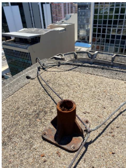
Base de sustentação captor Franklin
