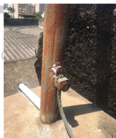
Conexões com oxidação
