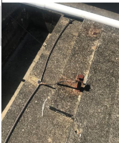
Conexões com oxidação
