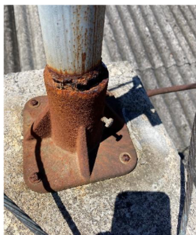
Base do captor Franklin oxidado
