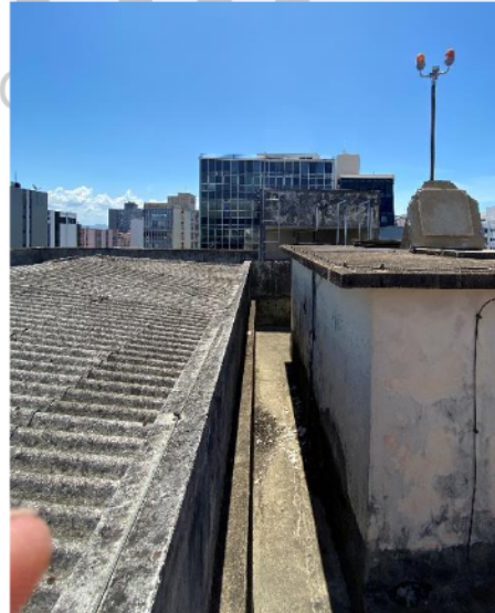
Malha de captação mais elevada
