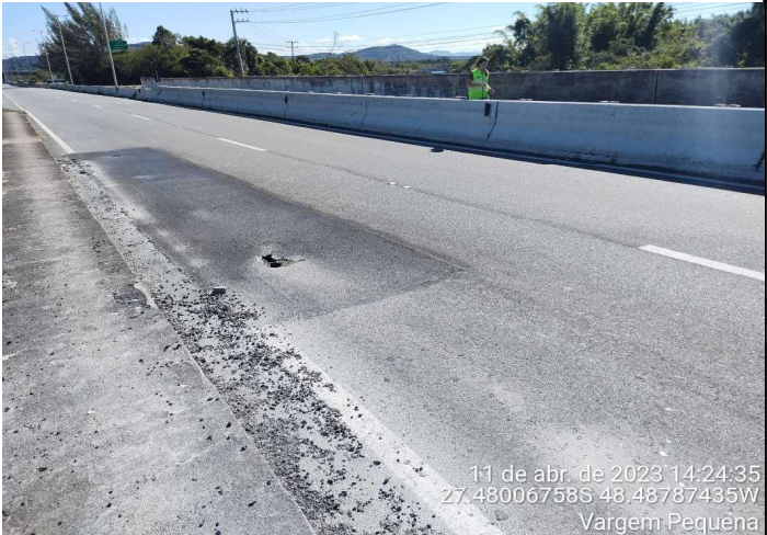
FOTO 08 - Anomalia em ponto do pavimento/laje
