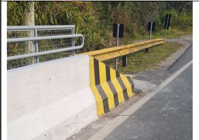
FOTO 07 - Ausência de dispositivo contra impacto
