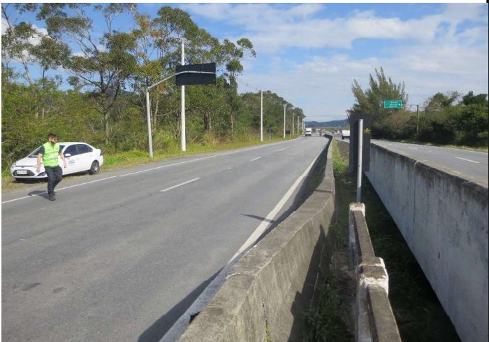
FOTO 12 - Estreitamento de pista na faixa interna, com desalinhamento da barreira rígida
