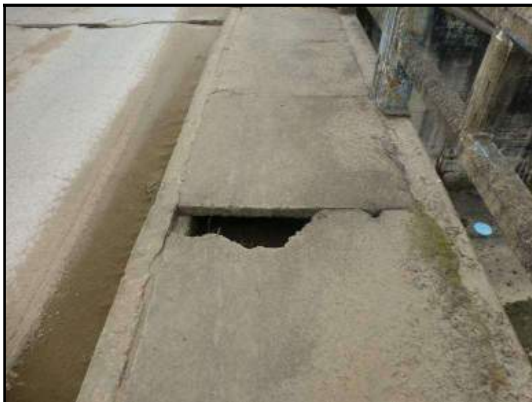
Foto 109 – Canaleta de Cabos Elétricos sob a Passarela de Pedestres da Ponte sobre o Canal de Restituição do Vertedouro
