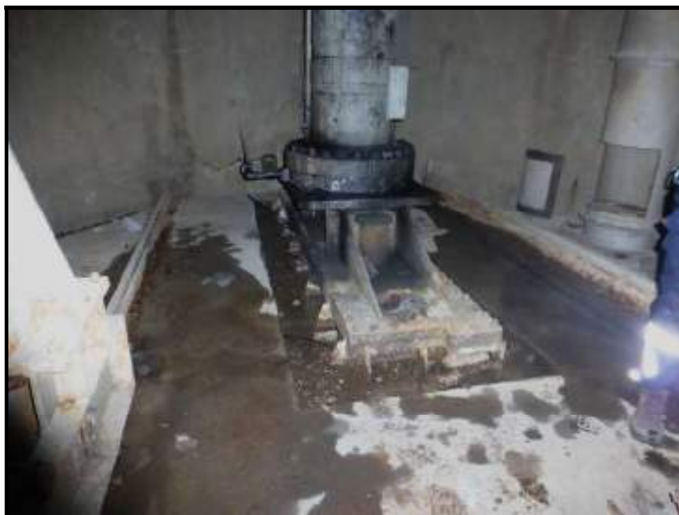
Foto 75 – Base do Servomotor de Acionamento da Comporta
