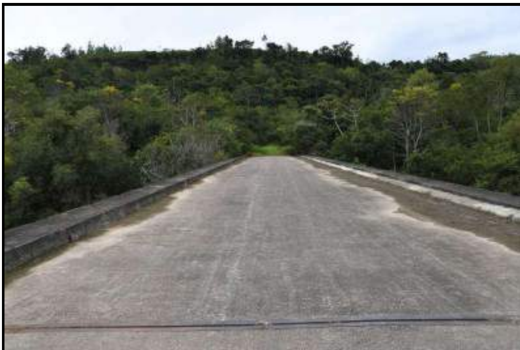
Foto 51 – Vista geral da ponte de jusante, com ausência de guarda corpo.
