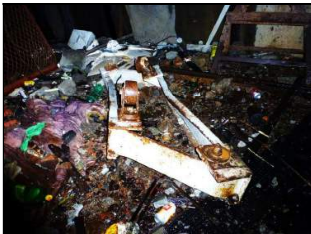
Foto 64 – Carro Metálico com Rodas (Totalmente Depredado) de Transporte de Pequenas Cargas da Galeria das Comportas
