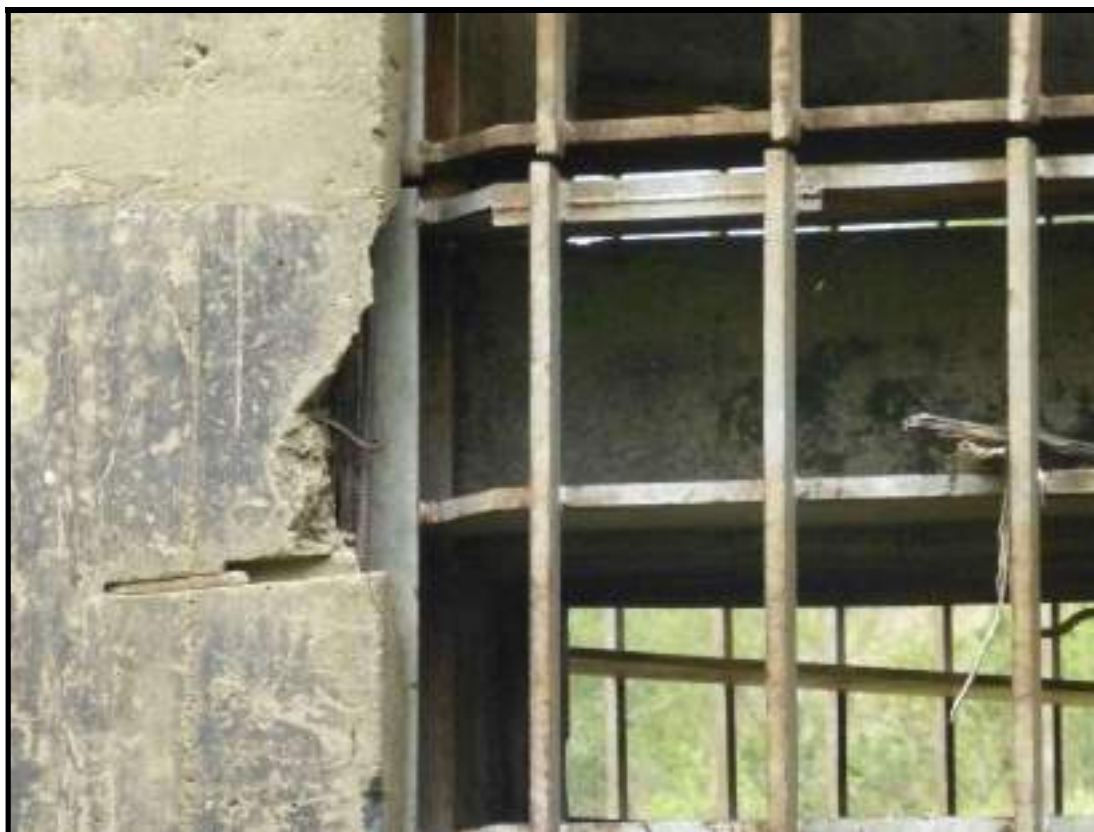
Foto 96 – Ocorrência de Ferragens Expostas junto às Guias das Grades das Estruturas de Emboque Tipo Tulipa dos Túneis de Descarga
