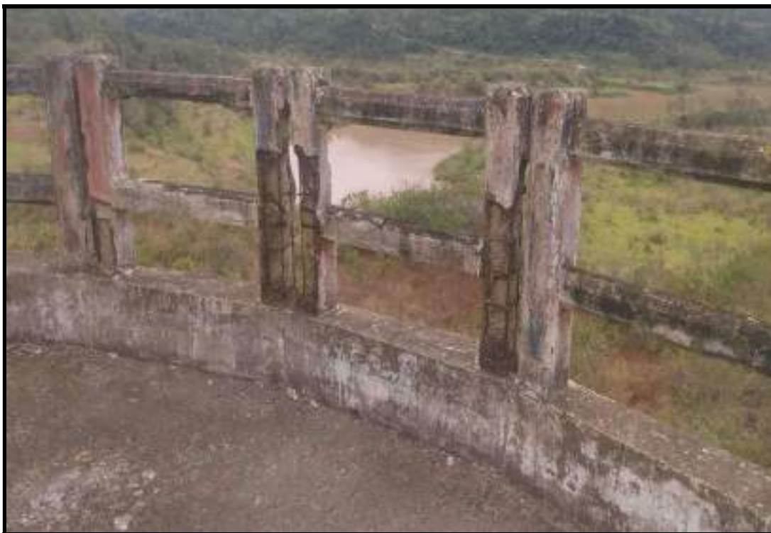
Foto 46 – Guarda corpo Deteriorado - Área da Plataforma de Operação das Comportas
