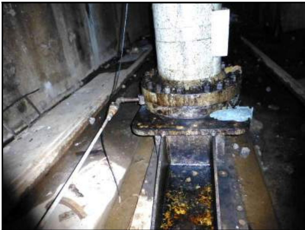
Foto 76 – Detalhe da Base do Servomotor de Acionamento da Comporta
