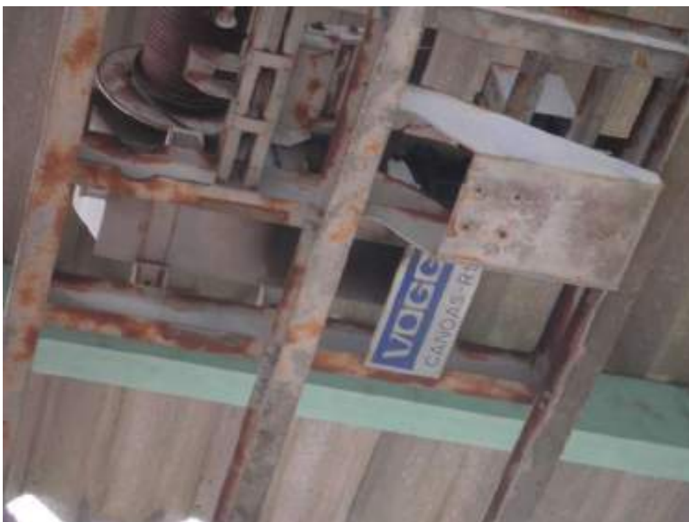
Fotos 59 – Ponte Rolante com Ausência das Roldanas, do Gancho, Cabo de Aço e Gancho da Elevação.
