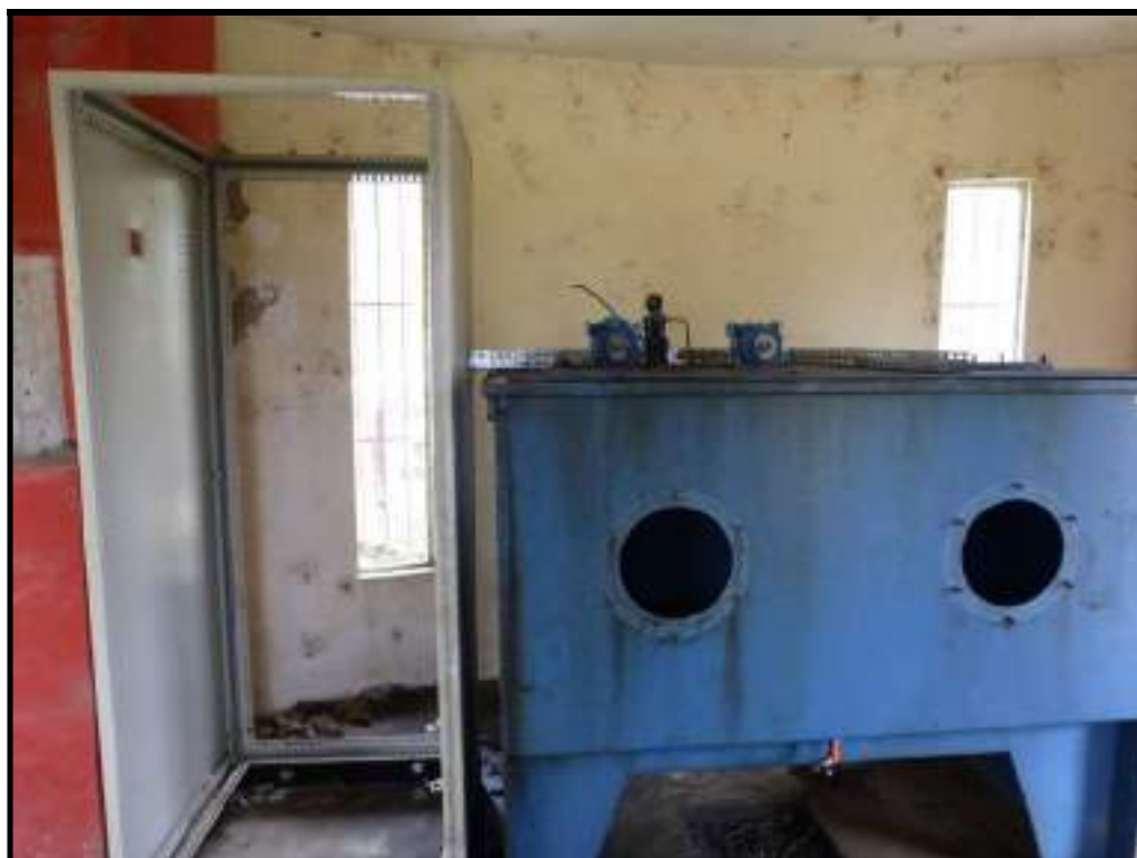
Foto 68 – Painel Elétrico de Proteção e Comando e Unidade Hidráulica de Acionamento das Comportas Inutilizados.
