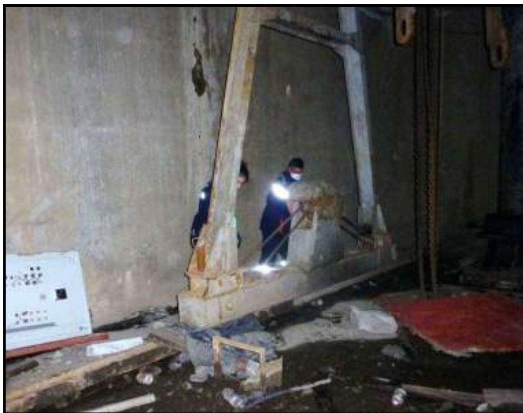
Foto 66 – “Pernas” do Pórtico Móvel de Manutenção das Comportas Deslizantes
