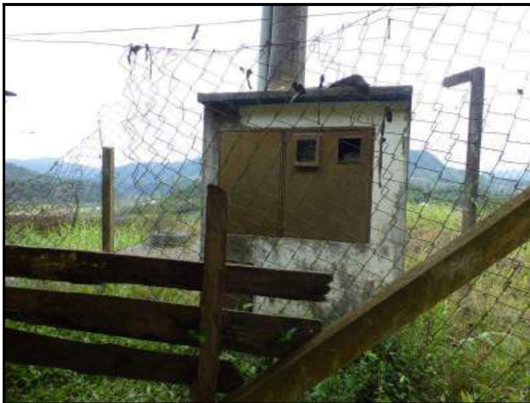
Foto 108 – Posto de Medição, Proteção e Seccionamento do Sistema de Alimentação Elétrica
