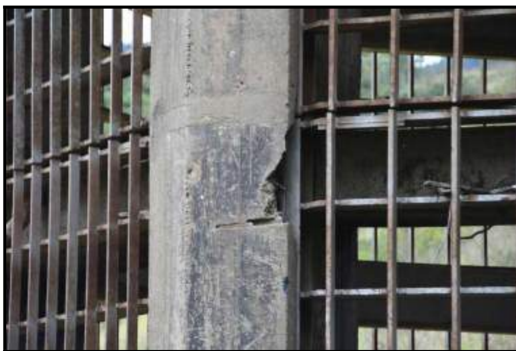
Foto 32 – Estrutura Tipo Tulipa do Túnel Interno com Falha de concretagem ou Avaria Devido a Choque de Tronco de Árvore.
