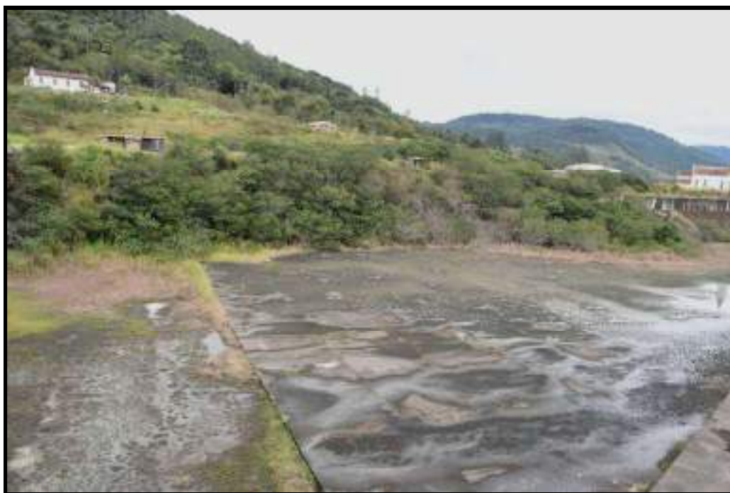
Foto 12 - Laje de Fundo do Trecho de Montante do Canal de Restituição com Vegetação nas Juntas
