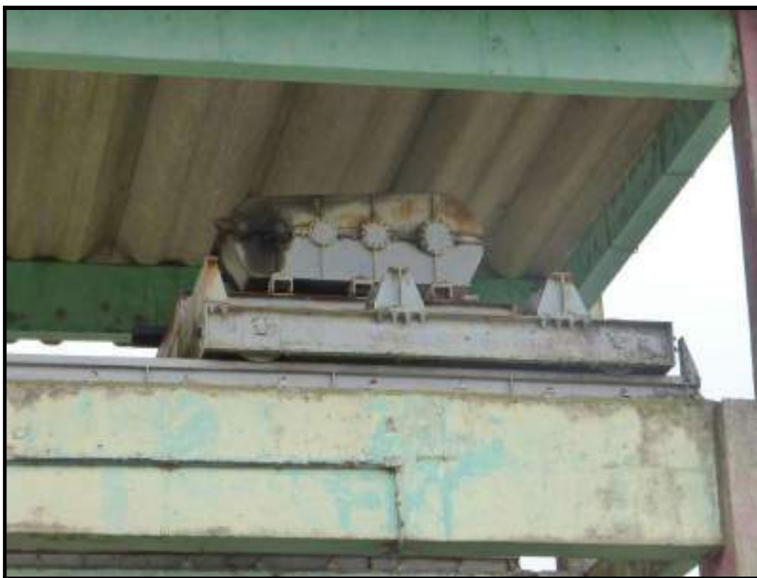
Foto 57 – Ponte Rolante de Manutenção das Comportas
