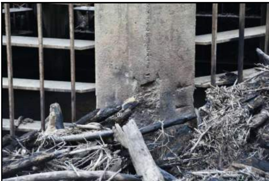
Foto 97 – Tulipa direita (entrada do Túnel Externo) com sinais de queima do material lenhoso junto à estrutura.
