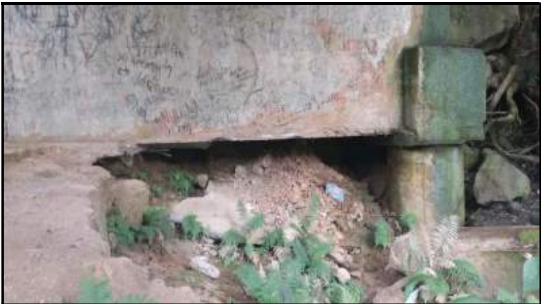
Foto 52 – Processo inicial de erosão sob os pilares da ponte que pode afetar o aterro da pista junto ao encontro esquerdo da ponte.
