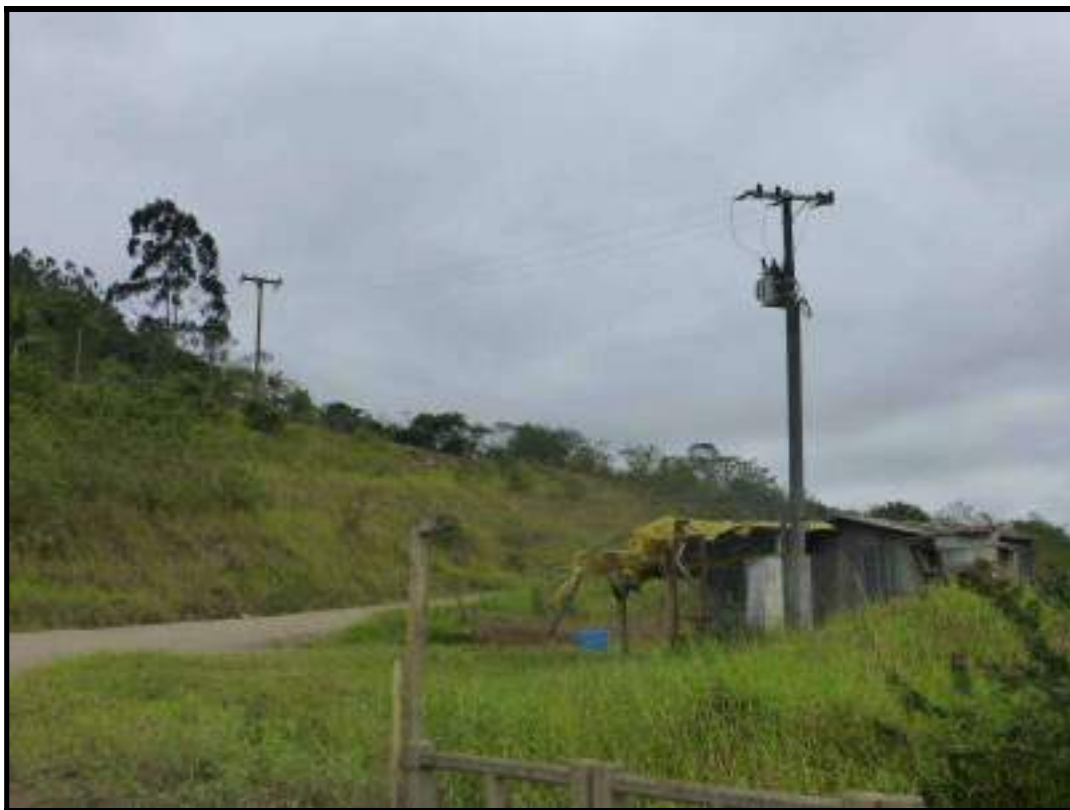
Foto 107 – Linha de Alimentação Elétrica e Posto de Transformação/Medição de Energia Elétrica
