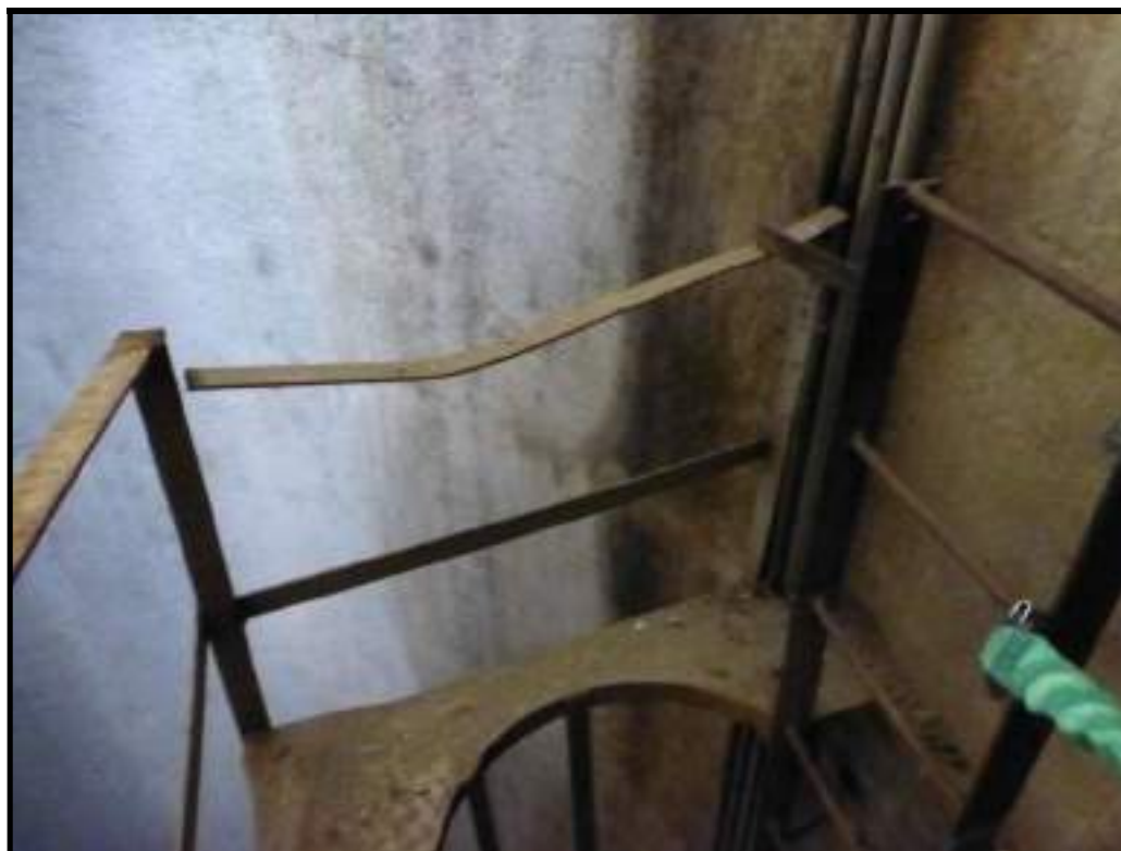
Foto 103 –Patamar de Descanso Depredado da Escada Tipo Marinheiro do Poço de Acesso à Galeria das Comportas (vista de baixo para cima)
