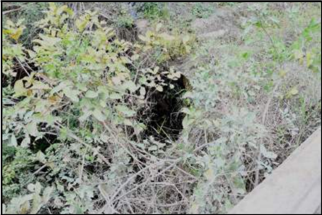
Foto 49 –Drenagem da estrada jogando água no talude próximo ao encontro direto da ponte sobre o Canal de Restituição.
