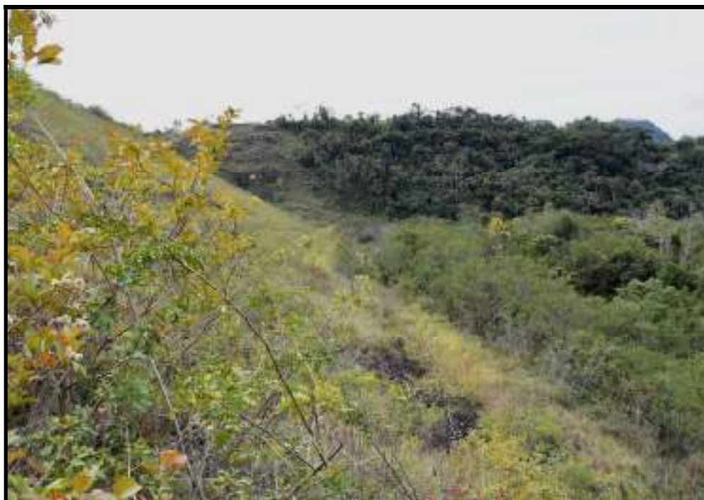
Foto 7 – Talude de Jusante junto à Ombreira Esquerda com a Presença de Vegetação Exuberante
