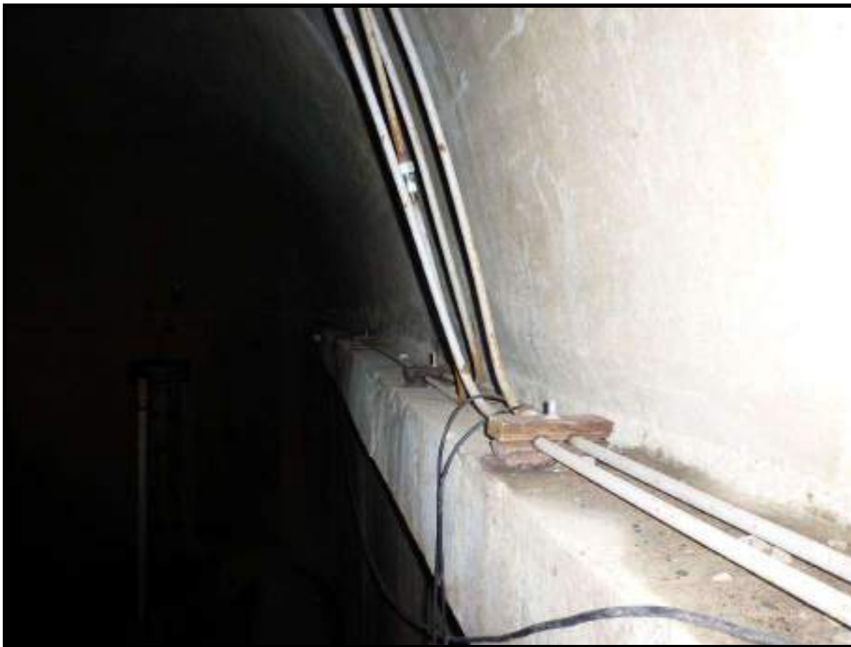
Foto 73 – Conduitos Metálicos de Óleo da Unidade Óleo-Hidráulica da Acionamento das Comportas em Bom Estado, com Necessidade Manutenção e Pintura.
