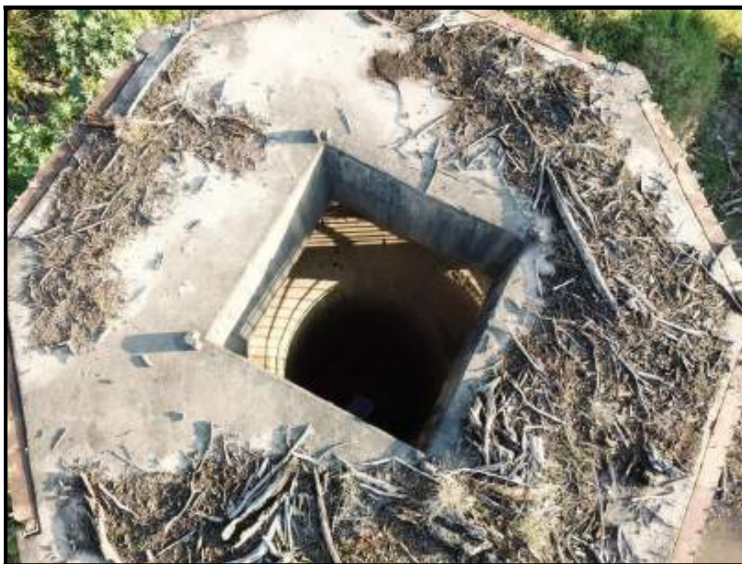
Foto 90 – Ausência da Grade da Laje Superior da Estrutura de Emboque Tipo Tulipa do Túnel Interno de Descarga (Esquerdo)
