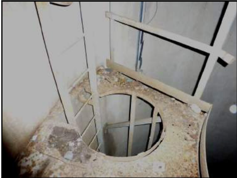
Foto 104 –Escada Tipo Marinheiro e Patamar de Descanso do poço de acesso à Galeria das Comportas, com problemas avançados de corrosão.
