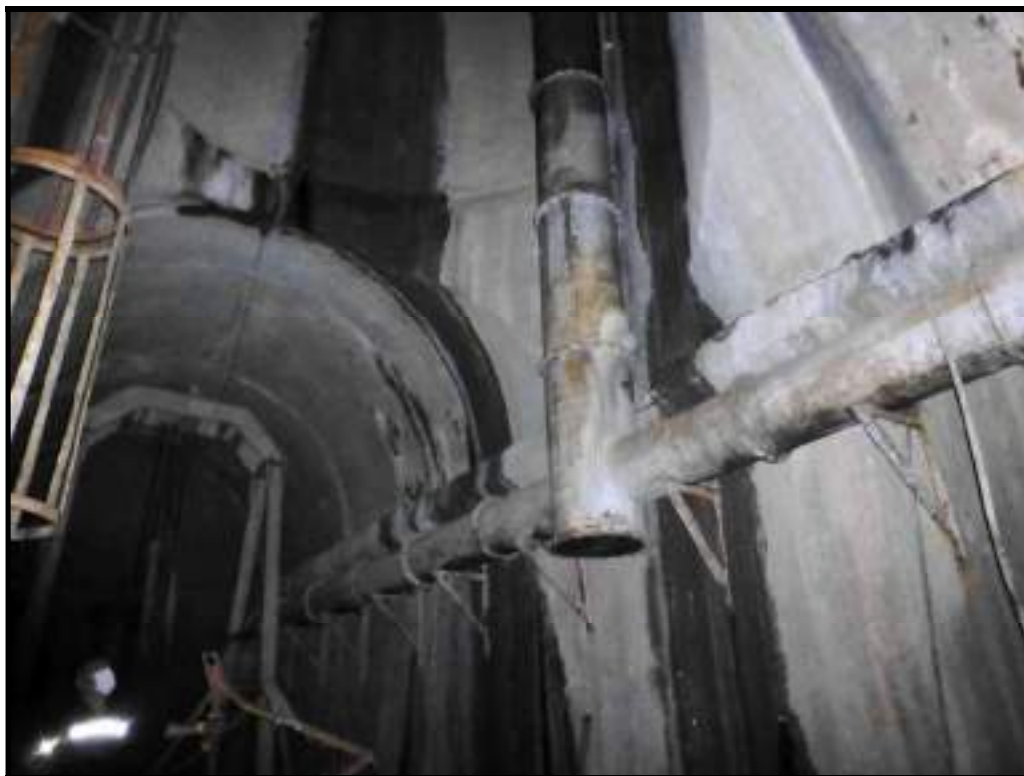
Foto 83 – “Junção” dos Dutos de Aeração das Comportas Deslizantes
