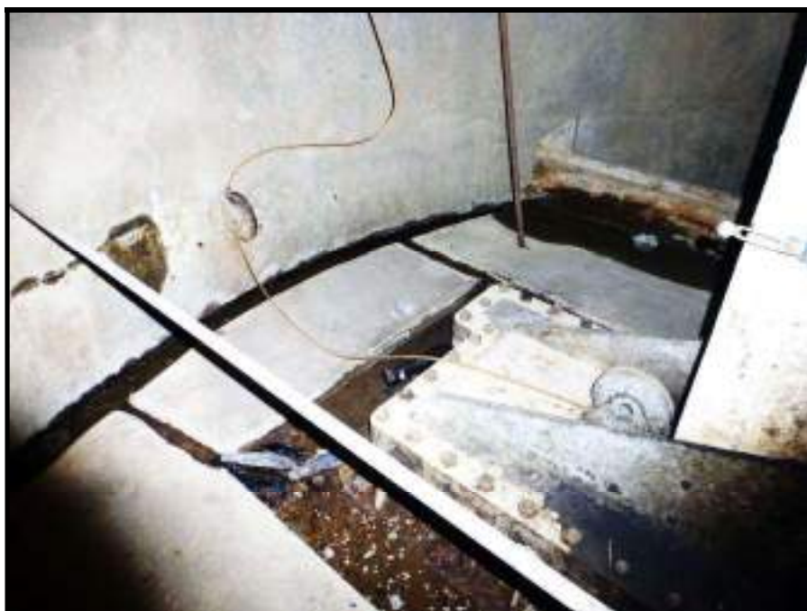
Foto 81 - Cabos e Roldanas do Sistema de Medição de Abertura das Comportas
