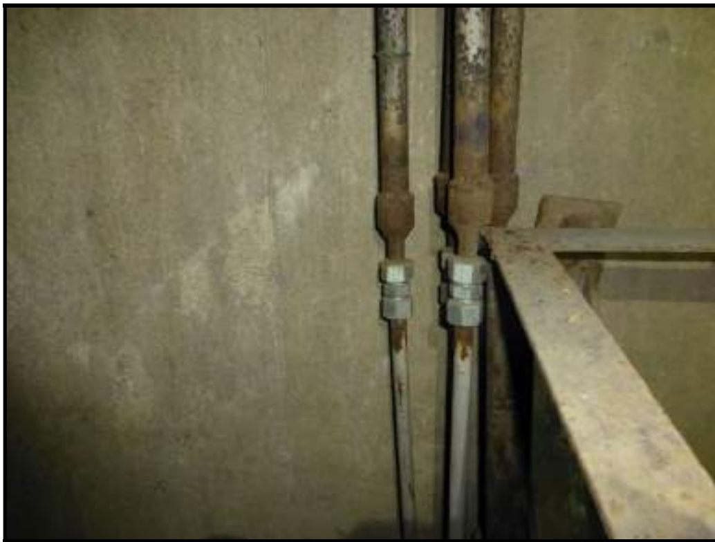
Foto 72 – Condutos Metálicos de Óleo do Sistema Óleo-Hidráulica de Acionamento das Comportas em Bom Estado, com Necessidade Manutenção e Pintura.
