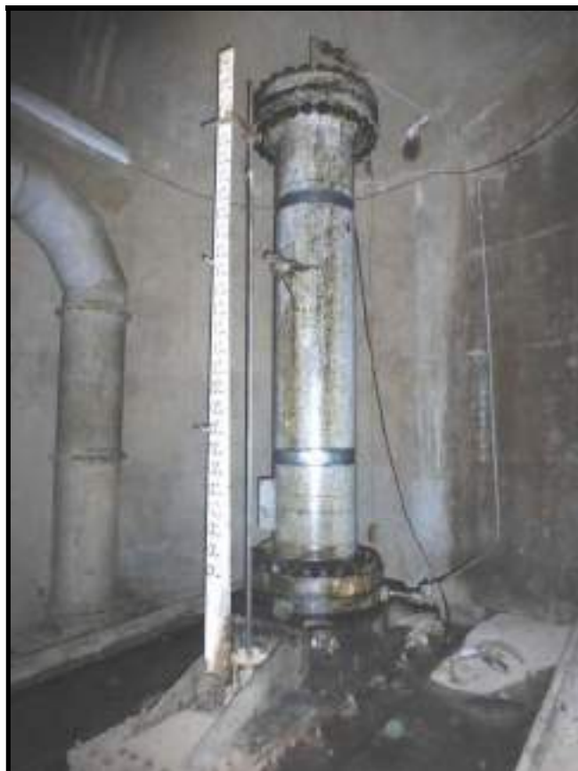
Foto 74 – Servomotor de Acionamento da Comporta
