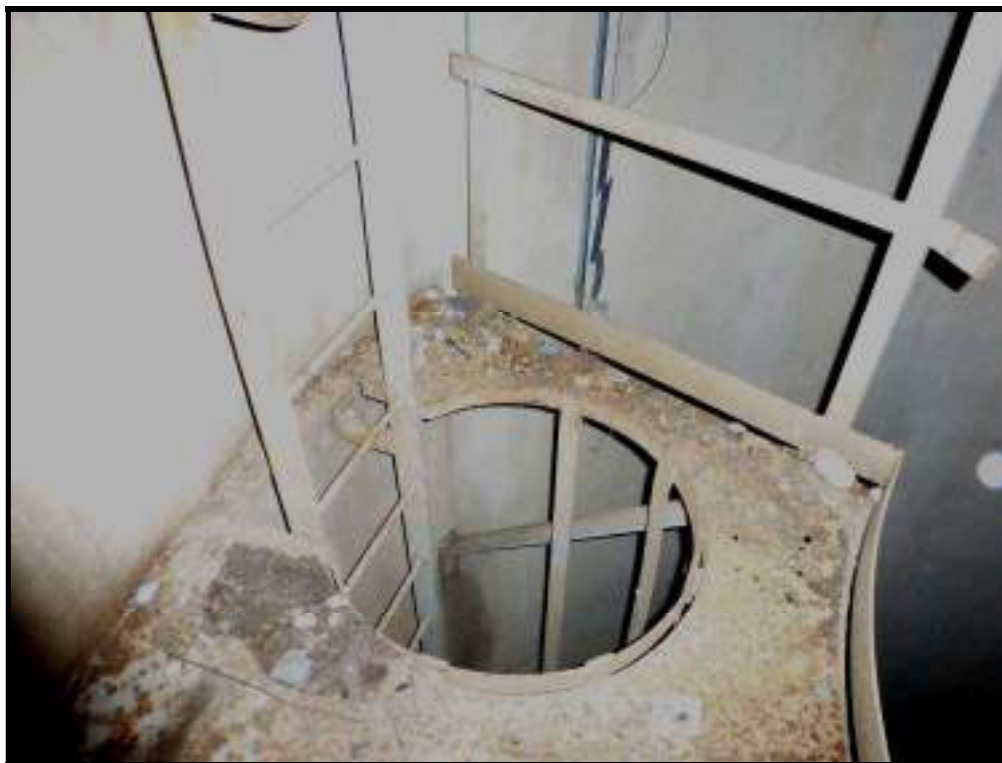
Foto 104 –Escada Tipo Marinheiro e Patamar de Descanso do poço de acesso à Galeria das Comportas, com problemas avançados de corrosão.
