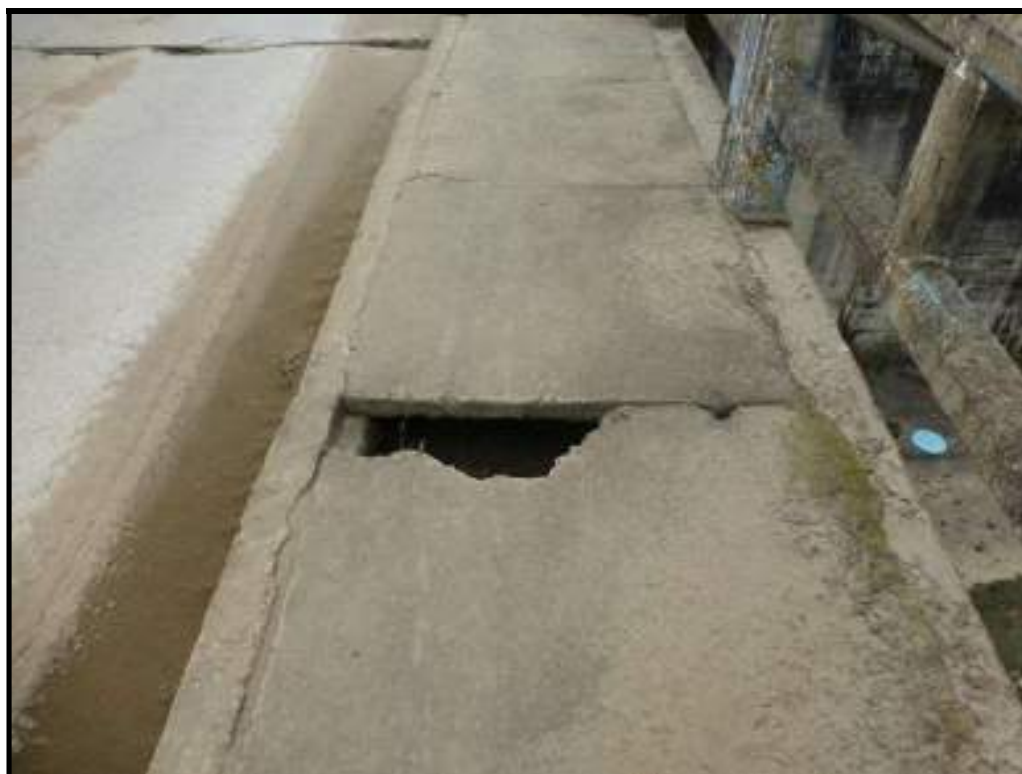
Foto 48 – Placa de concreto da calçada da ponte quebrada.
