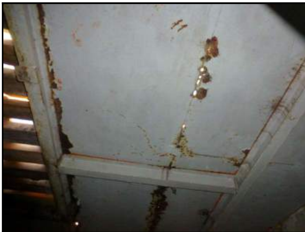
Foto 99 – Tampa Metálica do poço de acesso à Galeria das Comportas com problemas de corrosão decorrente de falta da manutenção.
