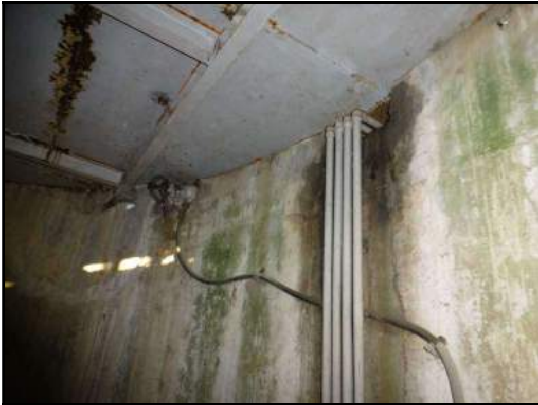
Foto 71 – Condutores Metálicos de Óleo da Unidade Óleo-Hidráulica de Acionamento das Comportas em Bom Estado, com Necessidade Manutenção e Pintura.
