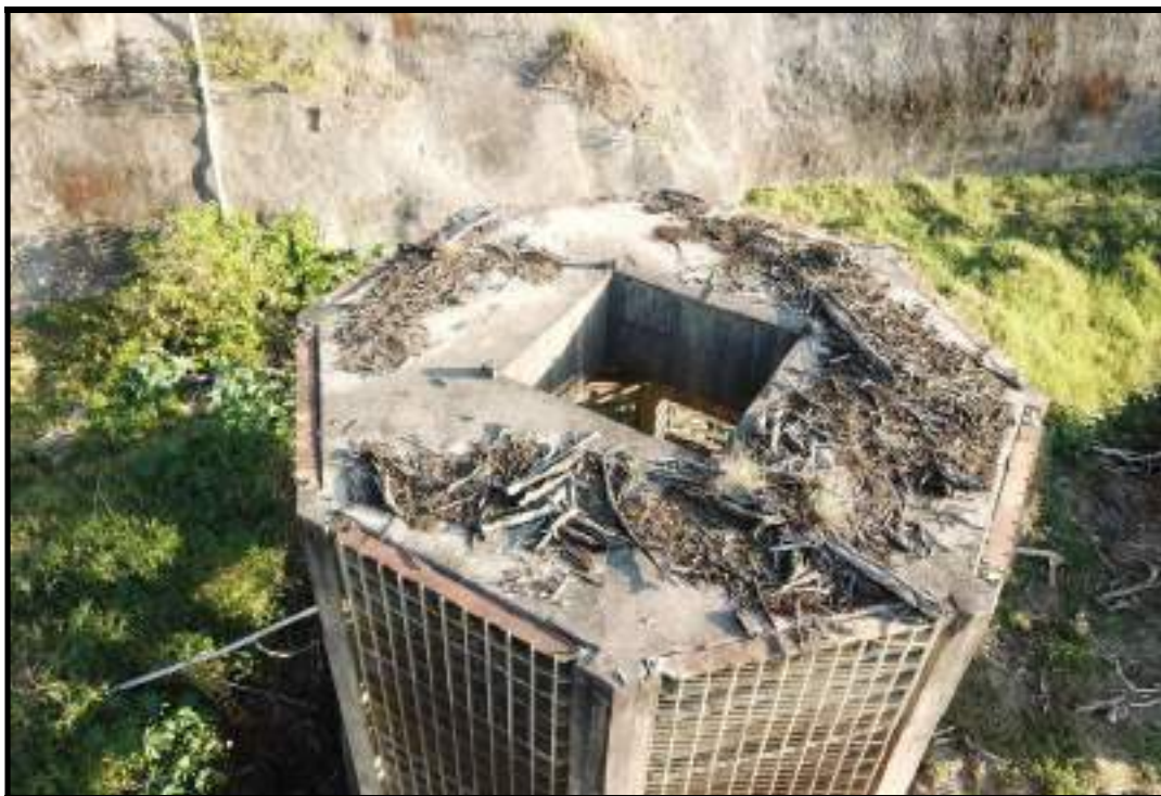
Foto 89 – Ausência da Grade da Laje Superior da Estrutura de Emboque Tipo Tulipa do Túnel Interno de Descarga (Esquerdo)
