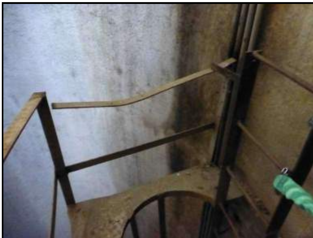
Foto 103 – Patamar de Descanso Depredado da Escada Tipo Marinheiro do Poço de Acesso à Galeria das Comportas (vista de baixo para cima)
