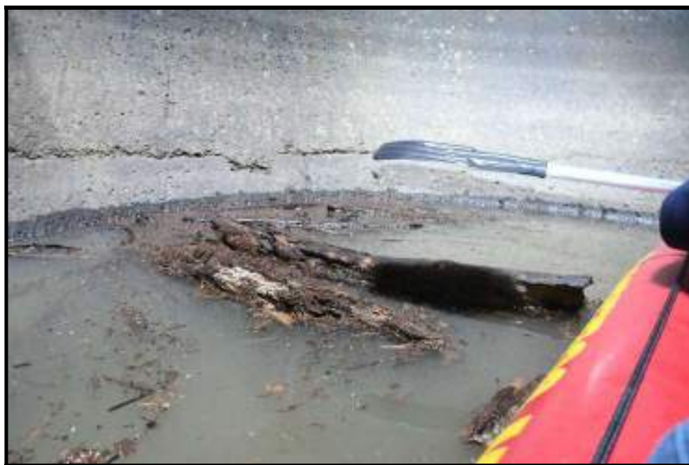
Foto 33 – Parte Interna da Estrutura de Emboque do Túnel Esquerdo (sem cavitação nem erosão mesmo com a entrada de troncos devido à ausência da grade superior. A trinca/fissura horizontal decorre de falhas na junta horizontal de concretagem.)
