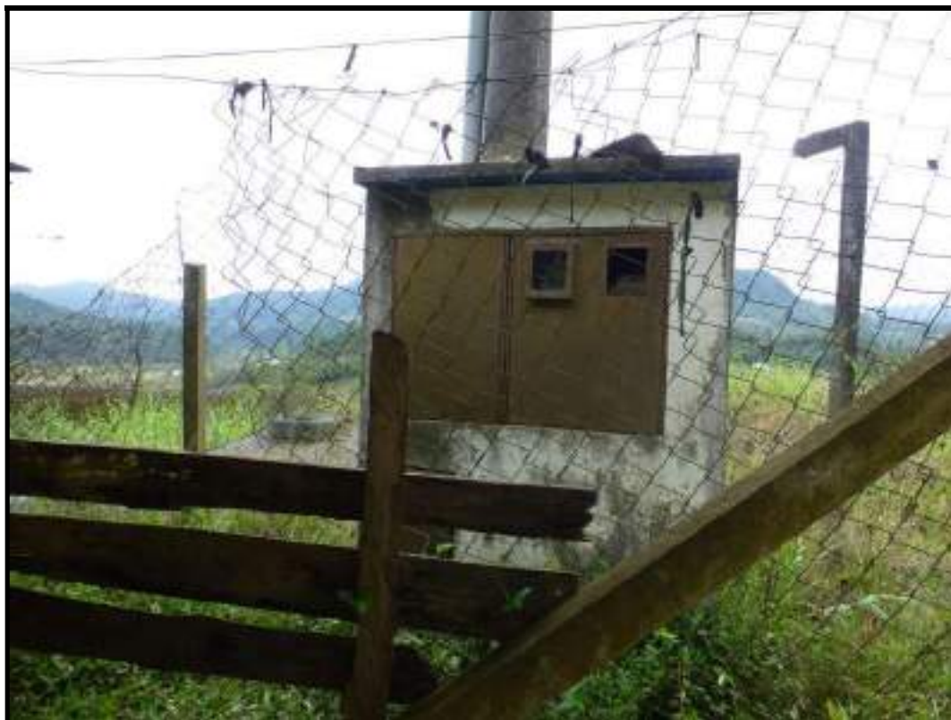
Foto 108 – Posto de Medição, Proteção e Seccionamento do Sistema de Alimentação Elétrica
