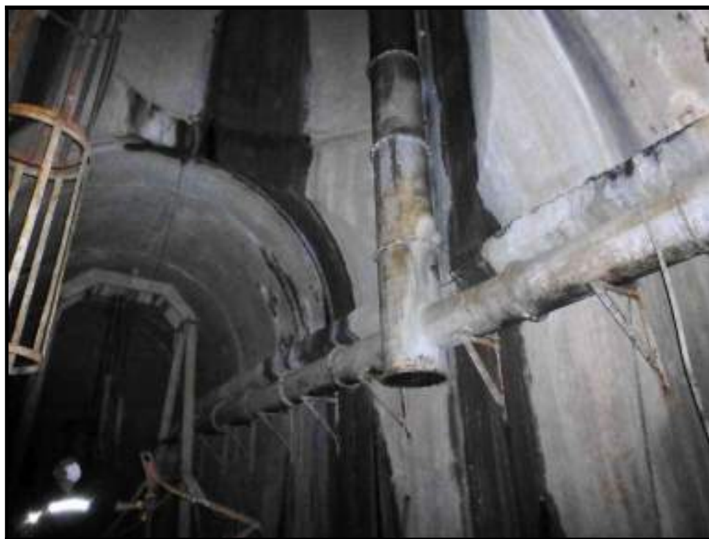
Foto 86 – “Junção” dos Dutos de Aeração das Comportas Deslizantes
