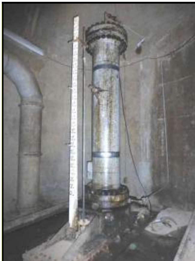
Foto 74 – Servomotor de Acionamento da Comporta
