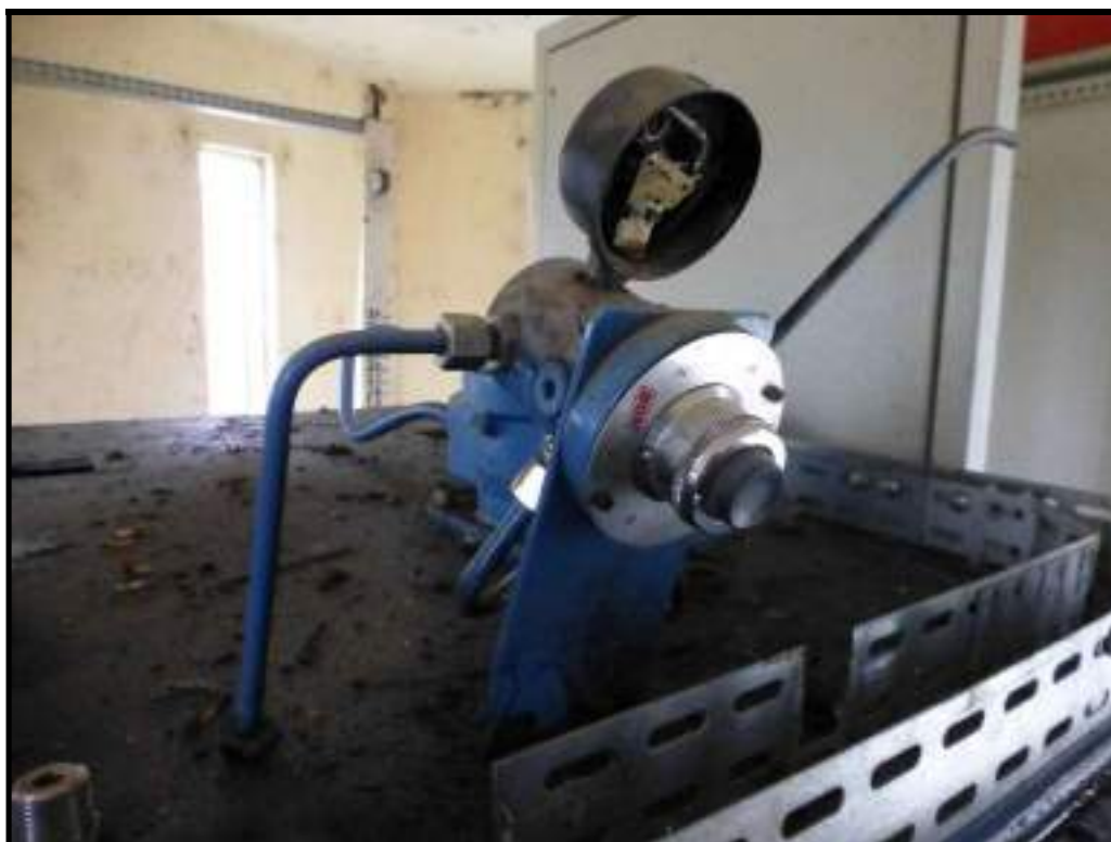
Foto 69 – Unidade Hidráulica de Acionamento das Comportas Totalmente Inutilizada
