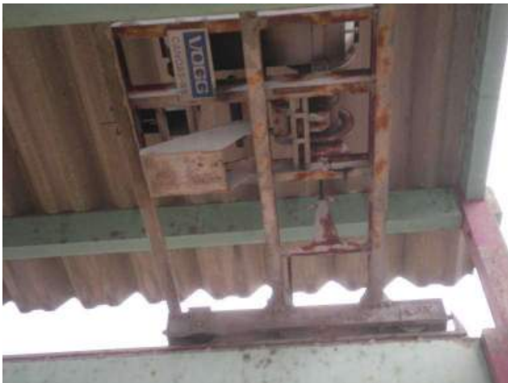
Fotos 60 – Ponte Rolante Ausência das Roldanas, do Gancho, Cabo de Aço e Gancho da Elevação.
