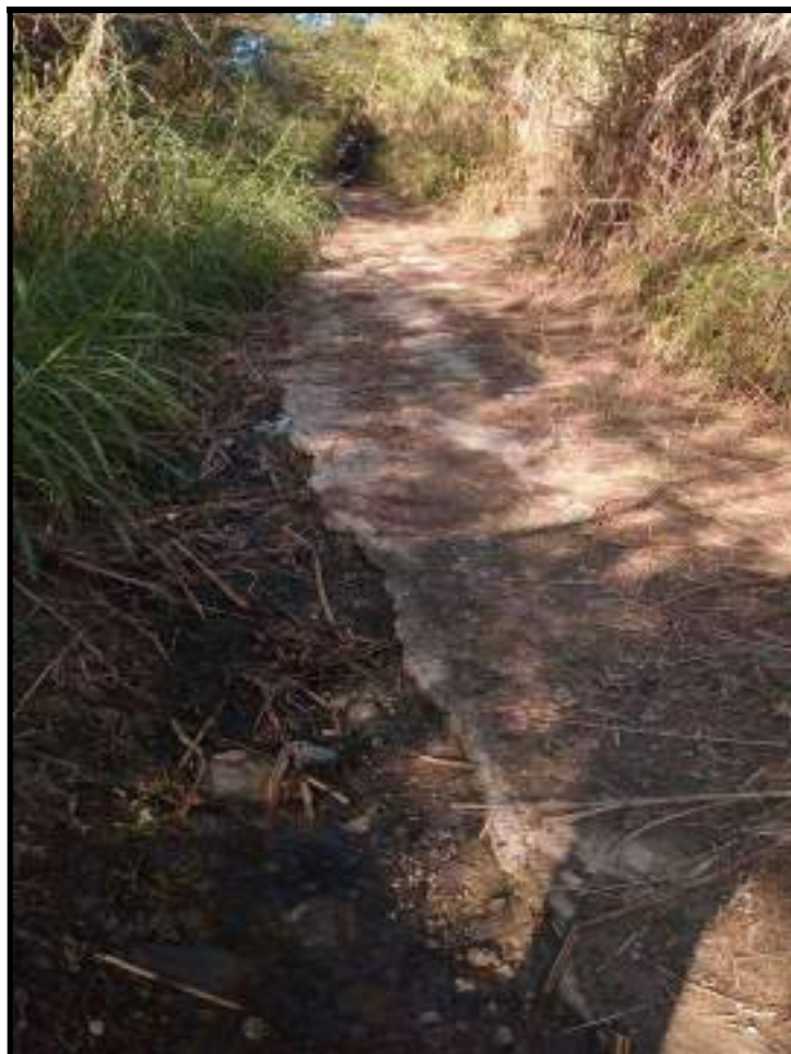
Foto 54 - Trecho da estrada a jusante da barragem, situado na margem direita, com pontos localizados de erosão e crescimento de vegetação (coord. 26°53'38.38"S, 49°40'35.00"O).
