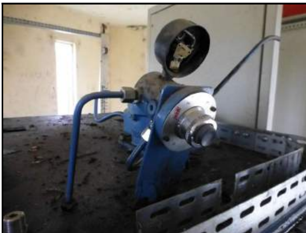
Foto 69 – Unidade Hidráulica de Acionamento das Comportas Totalmente Inutilizada
