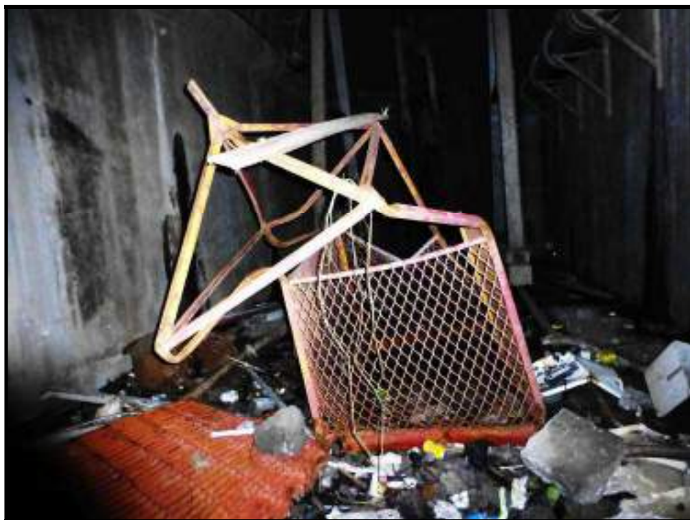
Foto 63 – Gaiola (Totalmente Depredada) de Transporte de Pequenas Cargas e Trabalhadores da Ponte Rolante Totalmente Depredada de Manutenção das Comportas
