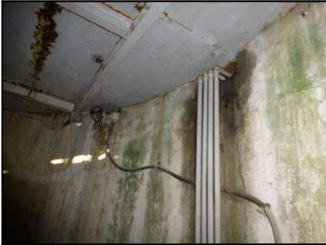
Foto 71 – Condutos Metálicos de Óleo da Unidade Óleo-Hidráulica da Acionamento das Comportas em Bom Estado, com Necessidade Manutenção e Pintura.
