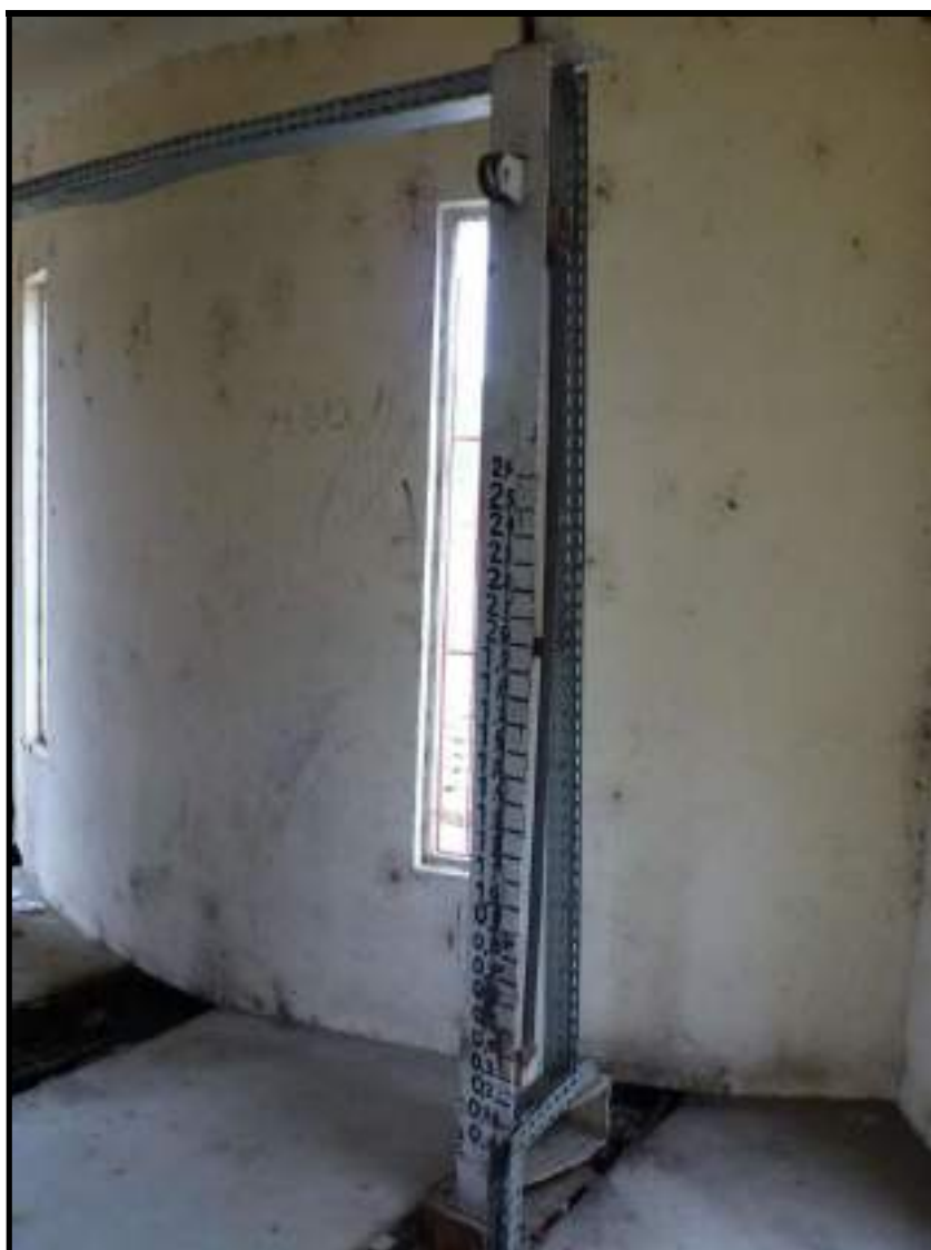
Foto 78 – Régua de Medição da Abertura da Comporta situada na Casa de Comando das Comportas
