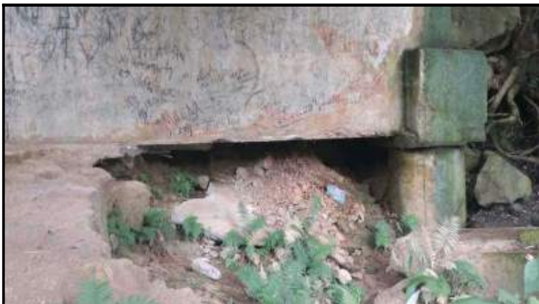
Foto 52 – Processo inicial de erosão sob os pilares da ponte que pode afetar o aterro da pista junto ao encontro esquerdo da ponte.
