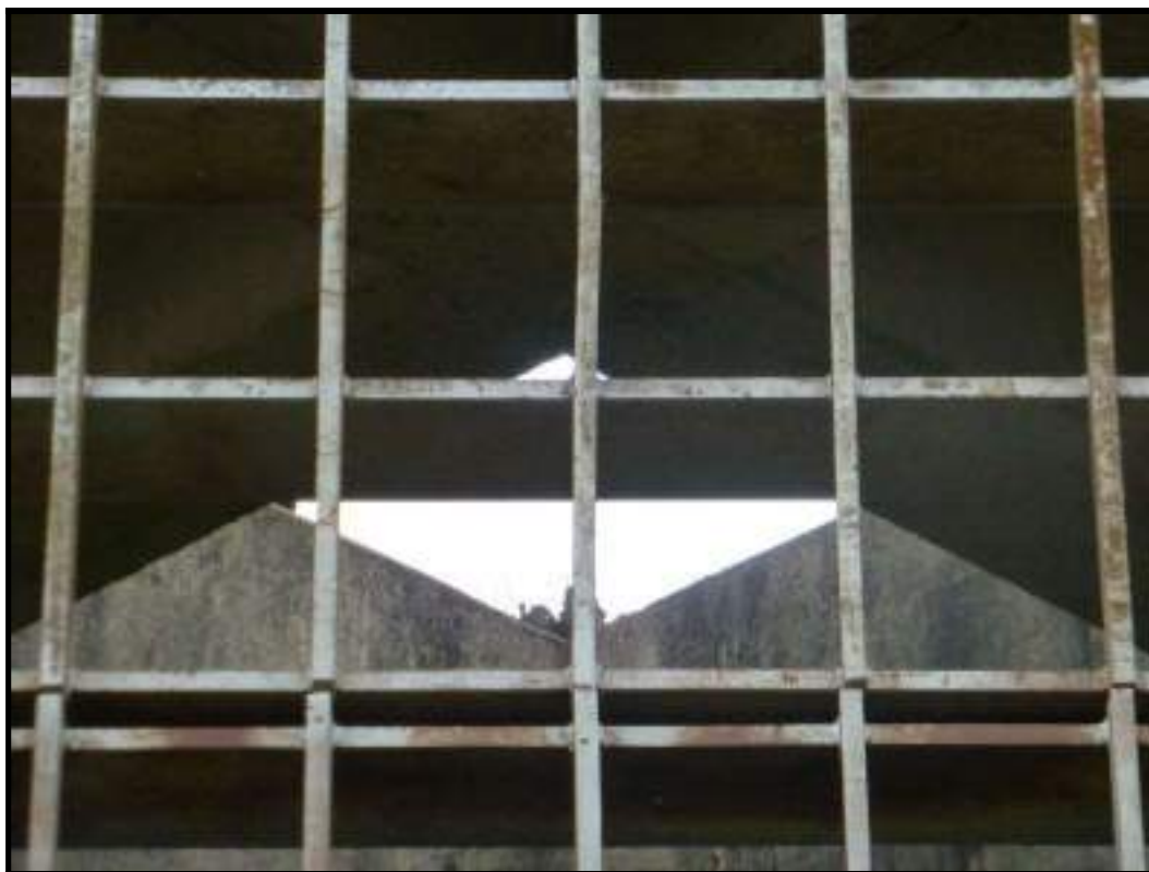
Foto 94 – Ocorrência de Problemas de Corrosão nas Lâminas das Grades
