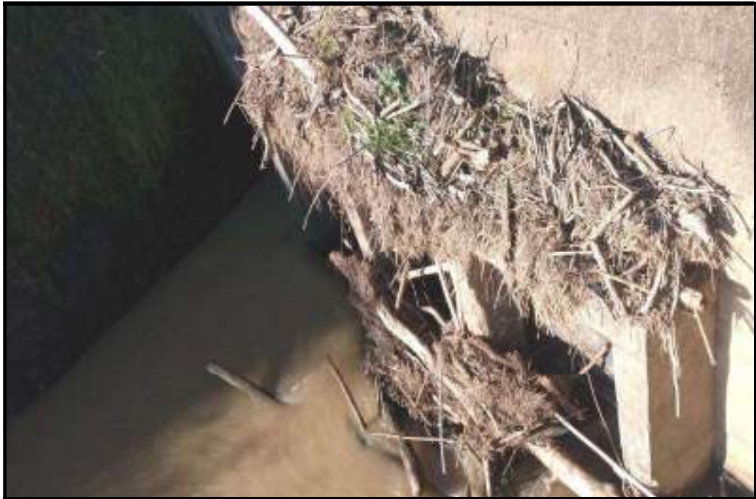
Foto 14 – Estrutura de Entrada d’Água da Galeria de Descarga com Obstrução por Galhos e Troncos de Árvore
