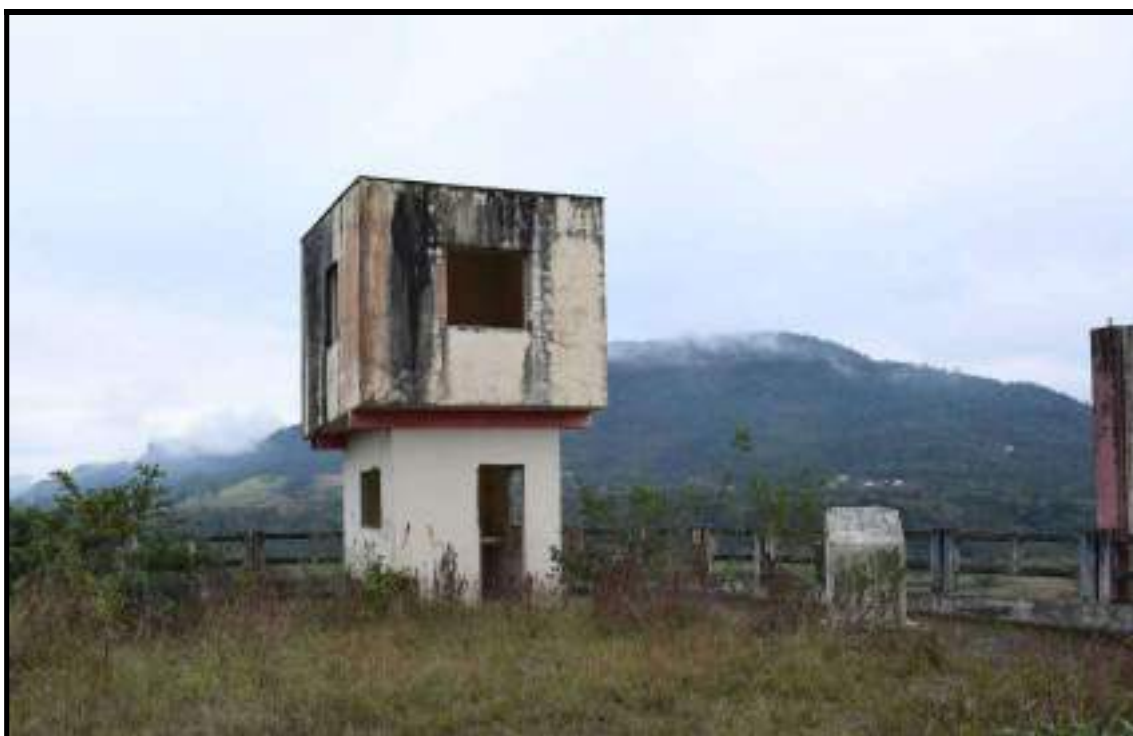
Foto 45 – Guarita de Segurança (totalmente depredada e abandonada, sem porta e janelas)
