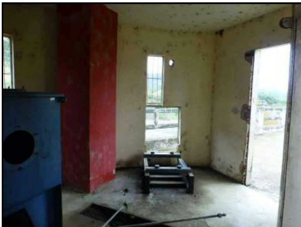
Foto 44 – Vista Interna da Edificação da Casa de Comando das Comportas (totalmente depredada)
