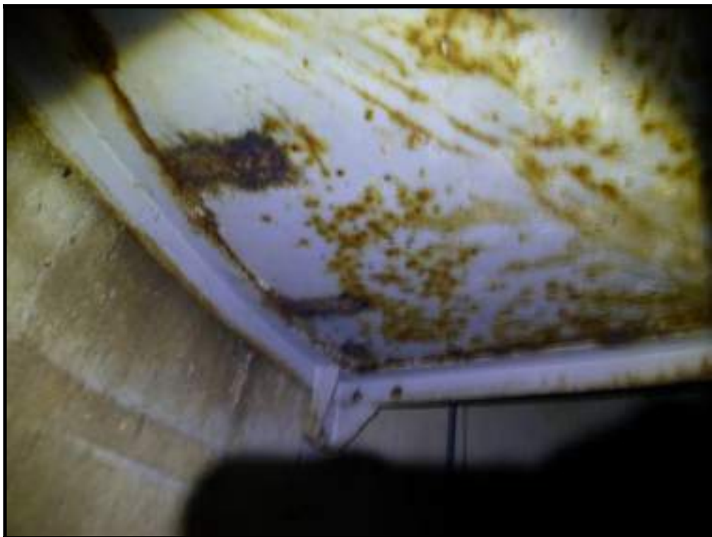
Foto 105 – Vista inferior do Patamar de Descanso da Escada Tipo Marinheiro do poço de acesso à Galeria das Comportas, com problemas avançados de corrosão.
