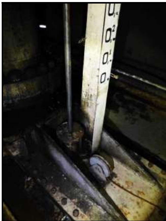
Foto 80 – Sistema de medição de Abertura da Comporta Situada na Galeria das Comportas Deslizantes
