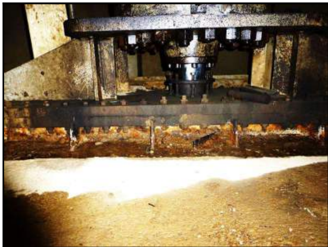
Foto 77 – Detalhe da Haste do Servomotor de Acionamento da Comporta
