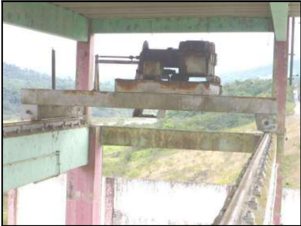
Foto 58 – Trilhos e Ponte Rolante de Manutenção das Comportas
