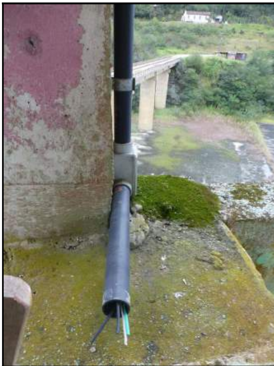
Foto 112 – Resquício do Sistema de Iluminação da Estrutura da Ponte Rolante de Manutenção das Comportas
