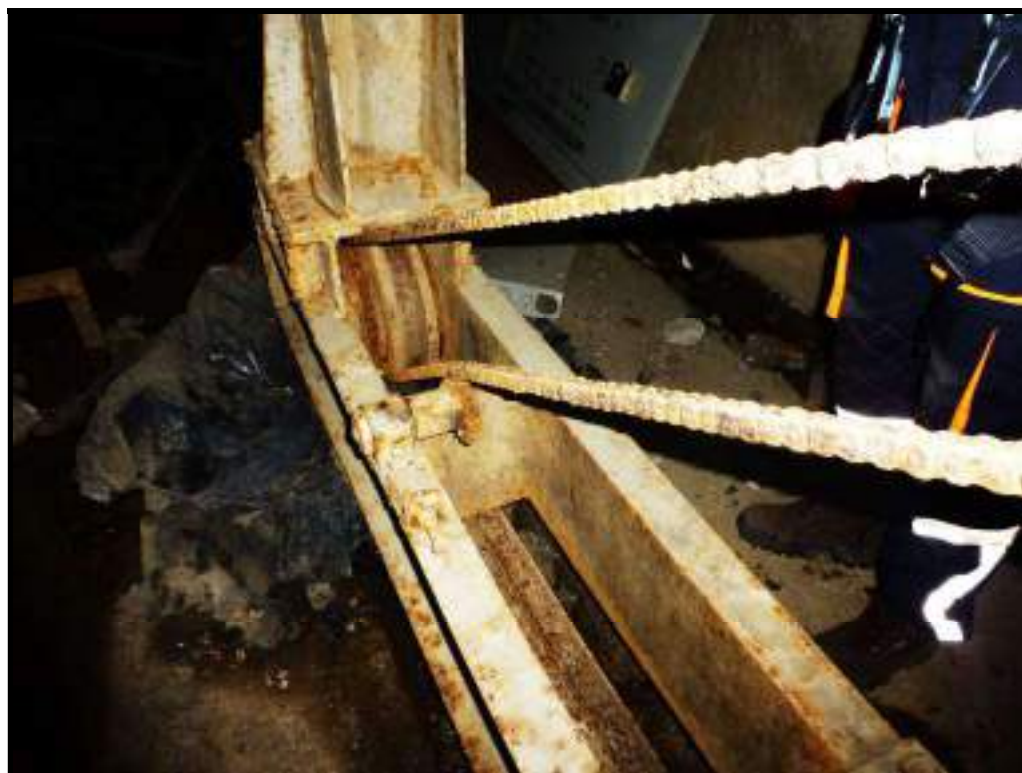
Foto 67 – Detalhe da Corrente de Acionamento das Rodas do Pórtico Móvel de Manutenção das Comportas Deslizantes
