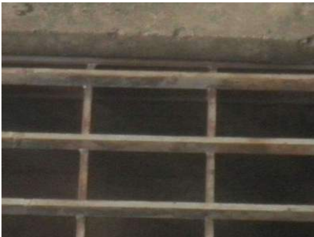
Foto 95 – Ocorrência de Problemas de Corrosão nas Lâminas das Grades
