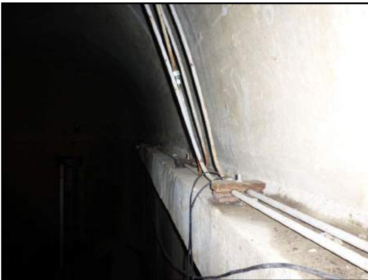
Foto 73 – Condutos Metálicos de Óleo da Unidade Óleo-Hidráulica da Acionamento das Comportas em Bom Estado, com Necessidade Manutenção e Pintura.
