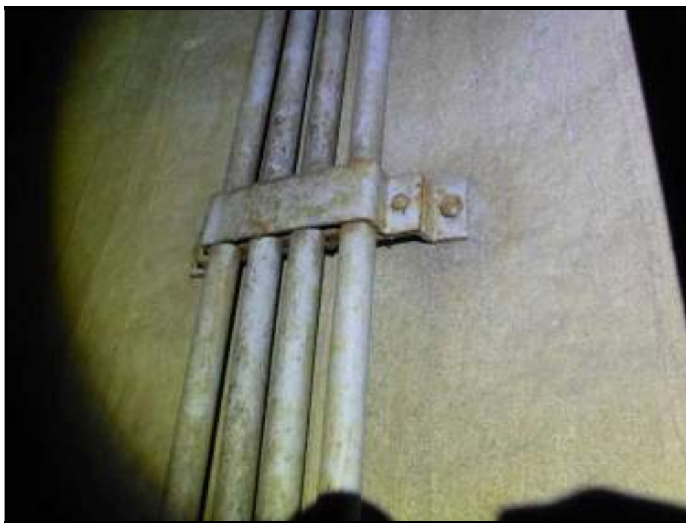
Foto 70 – Condutos Metálicos de Óleo da Unidade Óleo-Hidráulica da Acionamento das Comportas em Bom Estado, com Necessidade Manutenção e Pintura.
