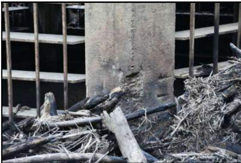
Foto 36 – Base da Estrutura de Emboque Tipo Tulipa do Túnel Externo (com sinais de queima do material lenhoso junto à estrutura)
