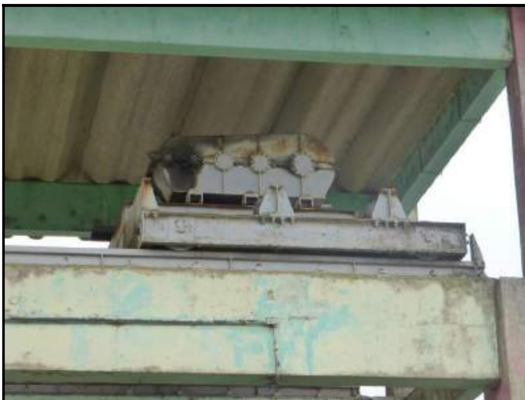
Foto 57 – Ponte Rolante de Manutenção das Comportas
