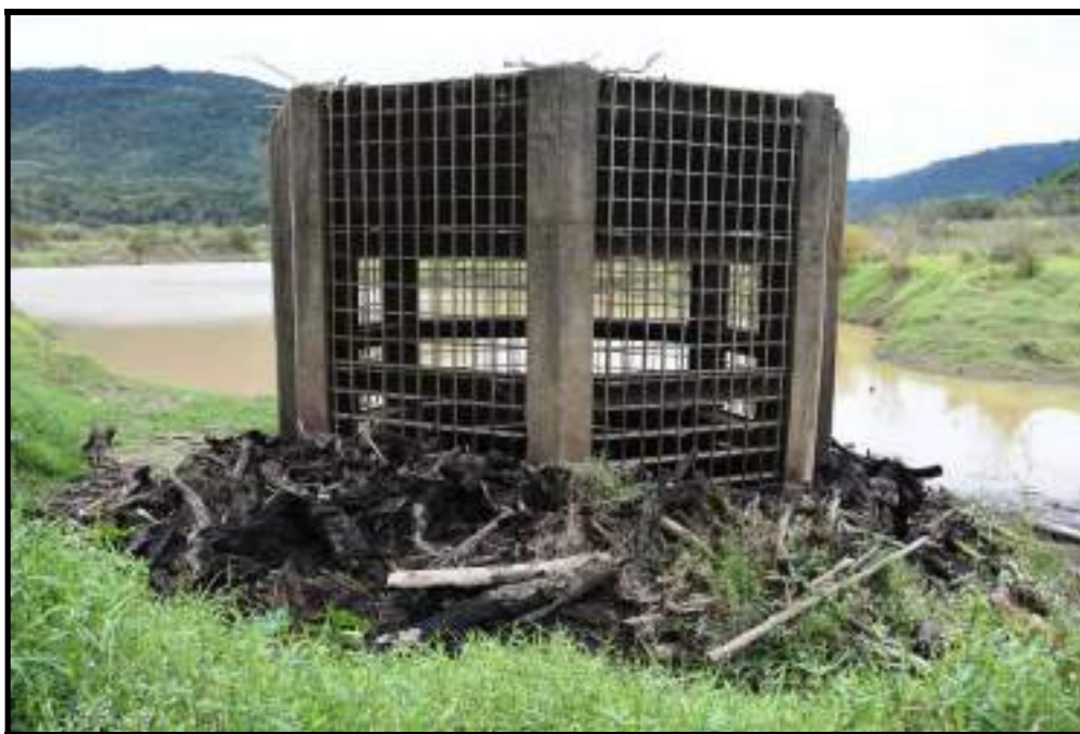
Foto 35 –Estrutura de Emboque Tipo Tulipa do Túnel Externo (com acúmulo de troncos e galhos na parte inferior)
