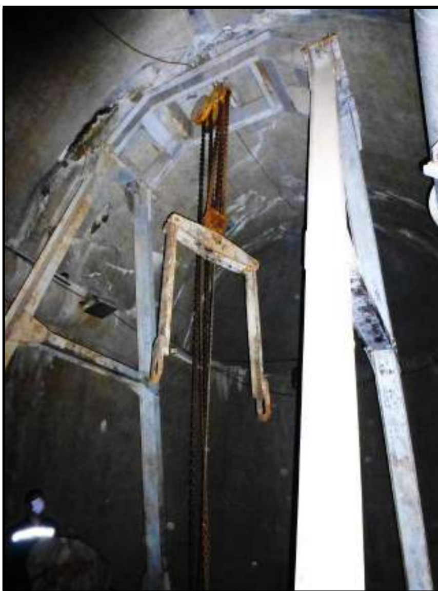
Foto 65 – Pórtico Móvel de Manutenção das Comportas de Controle de Vazão
