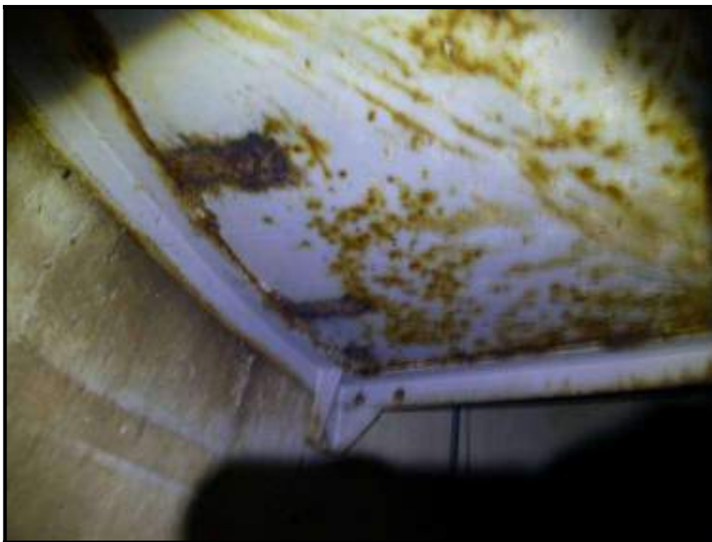
Foto 105 – Vista inferior do Patamar de Descanso da Escada Tipo Marinheiro do poço de acesso à Galeria das Comportas, com problemas avançados de corrosão.
