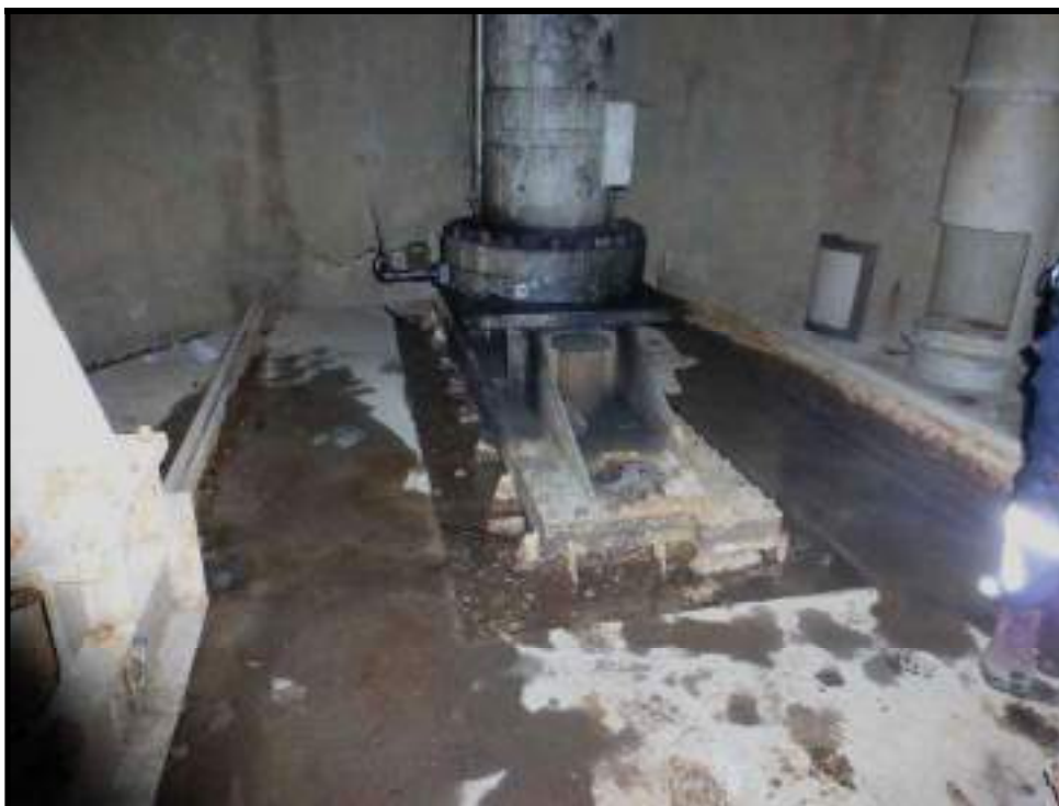
Foto 75 – Base do Servomotor de Acionamento da Comporta
