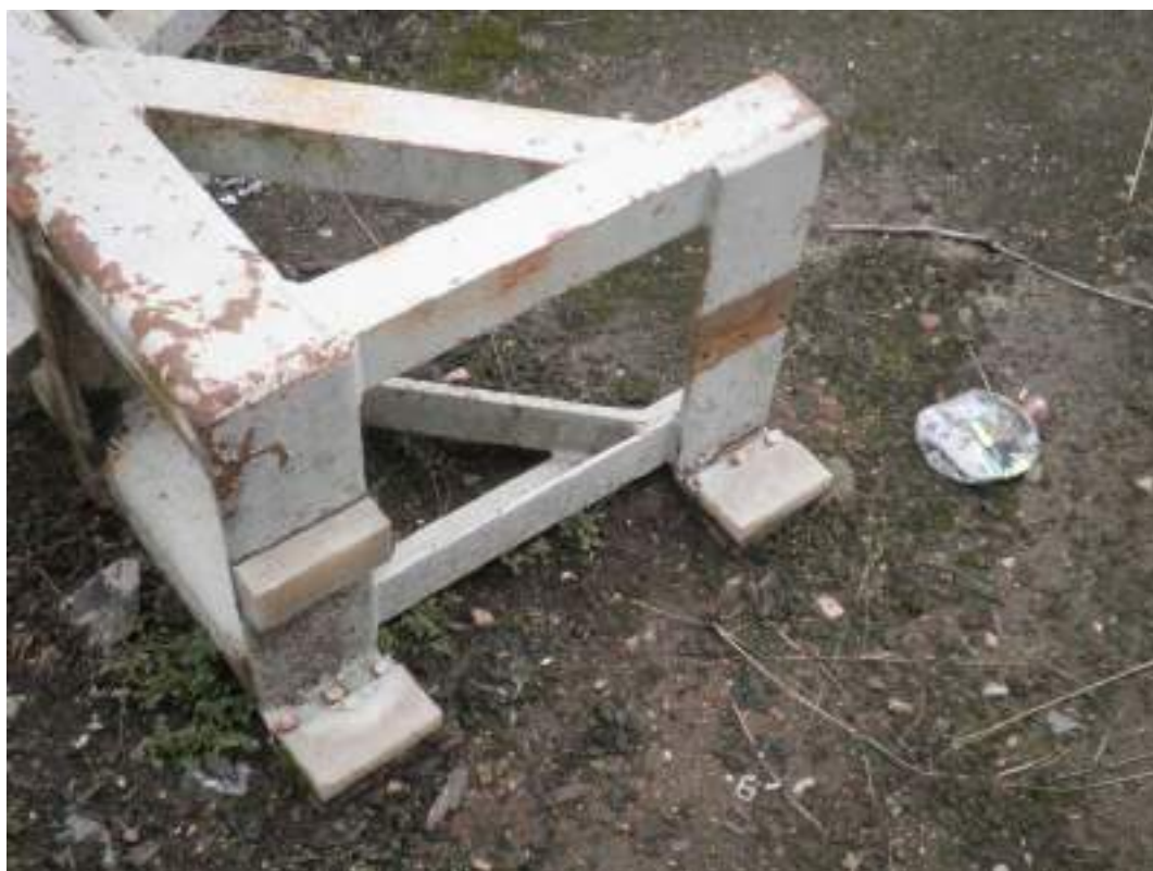
Foto 62 - Desaparecimento da Guia de Teflon da Viga Pescadora.
