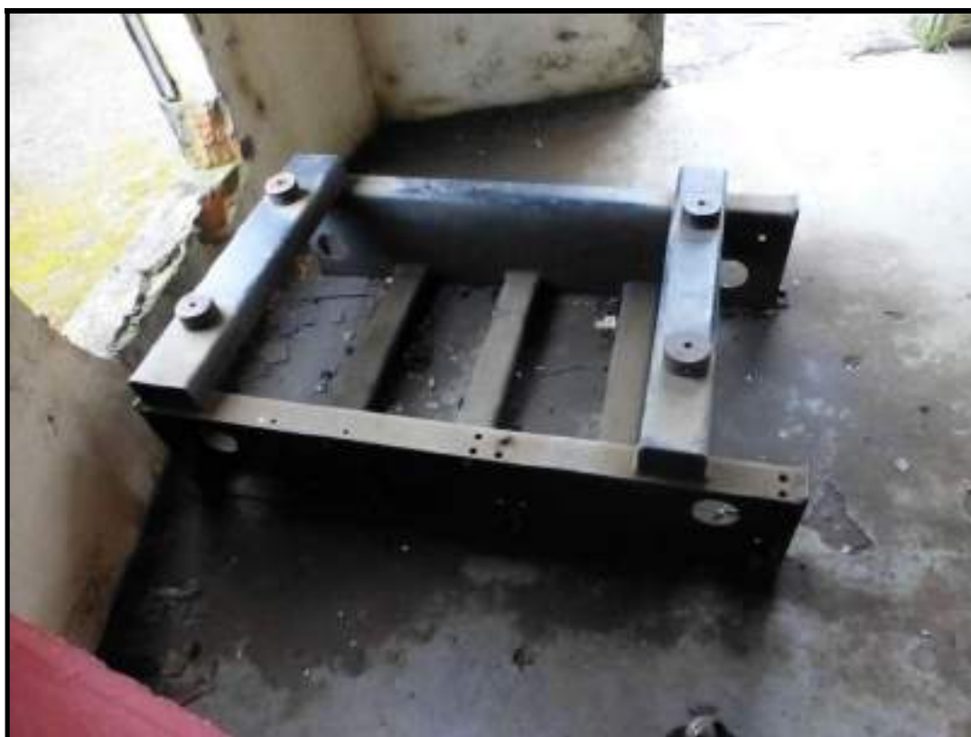
Foto 111 – “Skid” do Grupo Gerador Diesel-Elétrico do Sistema de Alimentação Emergencial de Energia Elétrica da Plataforma de Operação das Comportas.
