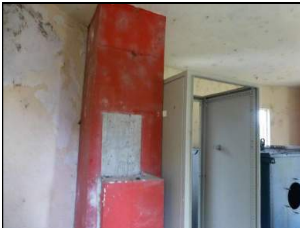
Foto 110 – Resquício da Caixa de Seccionamento, Proteção e Distribuição de Energia Elétrica (Coluna Vermelha)
