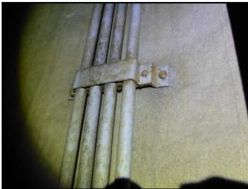
Foto 14 – Condutos Metálicos de Óleo da Unidade Óleo-Hidráulica da Acionamento das Comportas em Bom Estado, com Necessidade Manutenção e Pintura.
