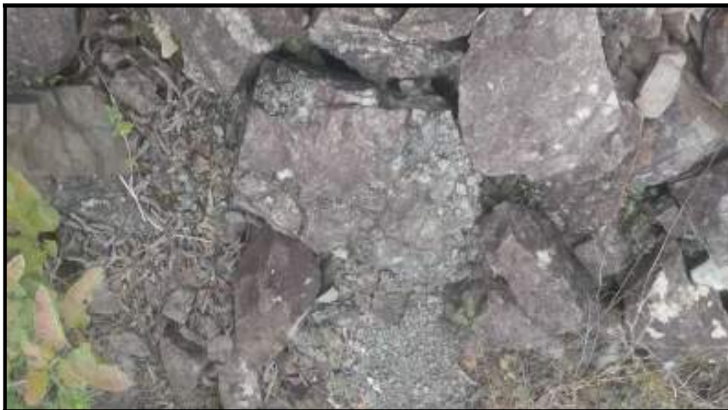
Foto 2 – Bloco de Arenito do Enrocamento com Evidências de Desagregação por Intemperismo Físico
