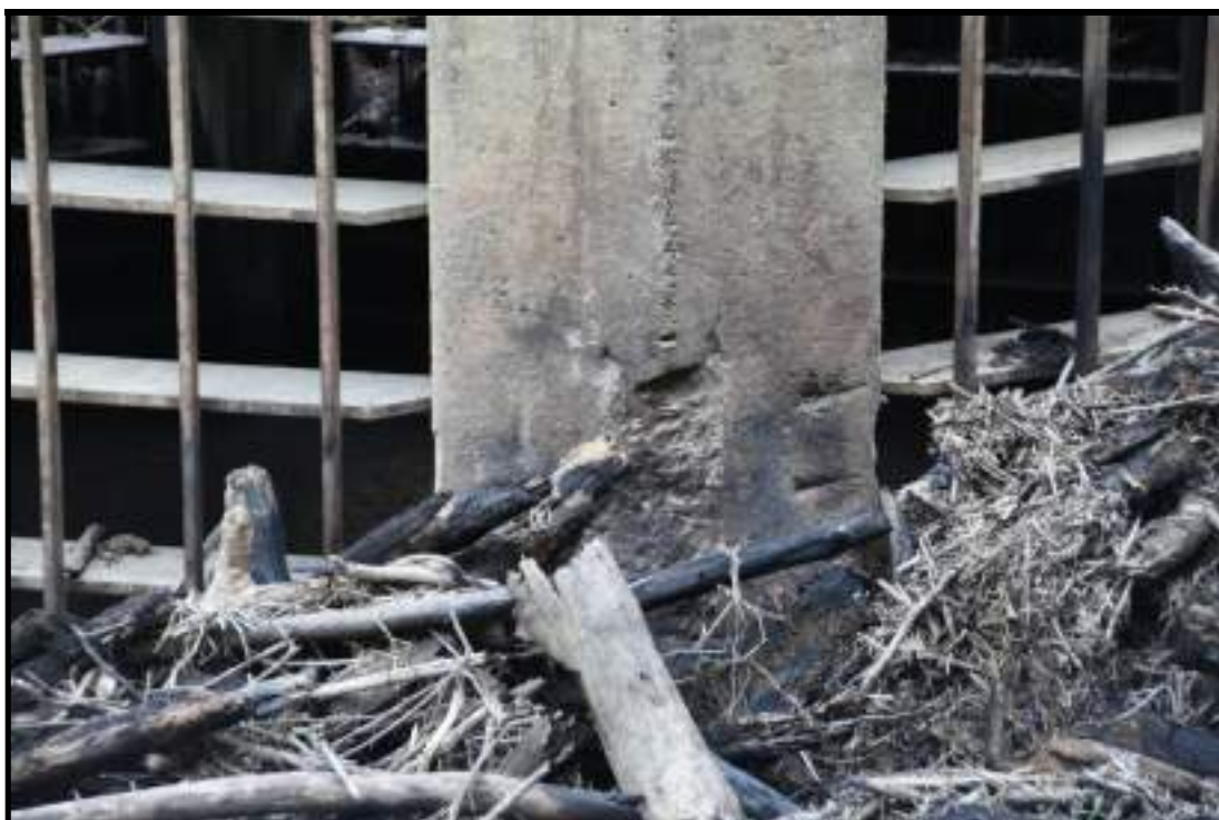
Foto 41 – Tulipa direita (entrada do Túnel Externo ) com sinais de queima do material lenhoso junto à estrutura.
