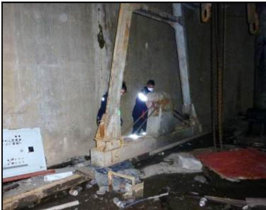
Foto 10 – “Pernas” do Pórtico Móvel de Manutenção das Comportas Deslizantes
