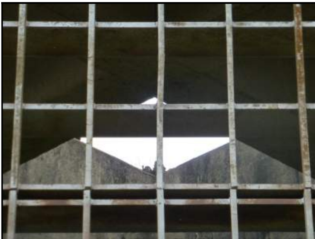
Foto 38 – Ocorrência de Problemas de Corrosão nas Lâminas das Grades
