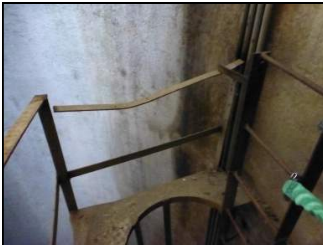
Foto 47 – Patamar de Descanso Depredado da Escada Tipo Marinheiro do Poço de Acesso à Galeria das Comportas (vista de baixo para cima)
