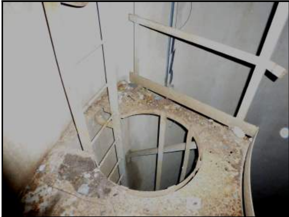
Foto 48 –Escada Tipo Marinheiro e Patamar de Descanso do poço de acesso à Galeria das Comportas, com problemas avançados de corrosão.
