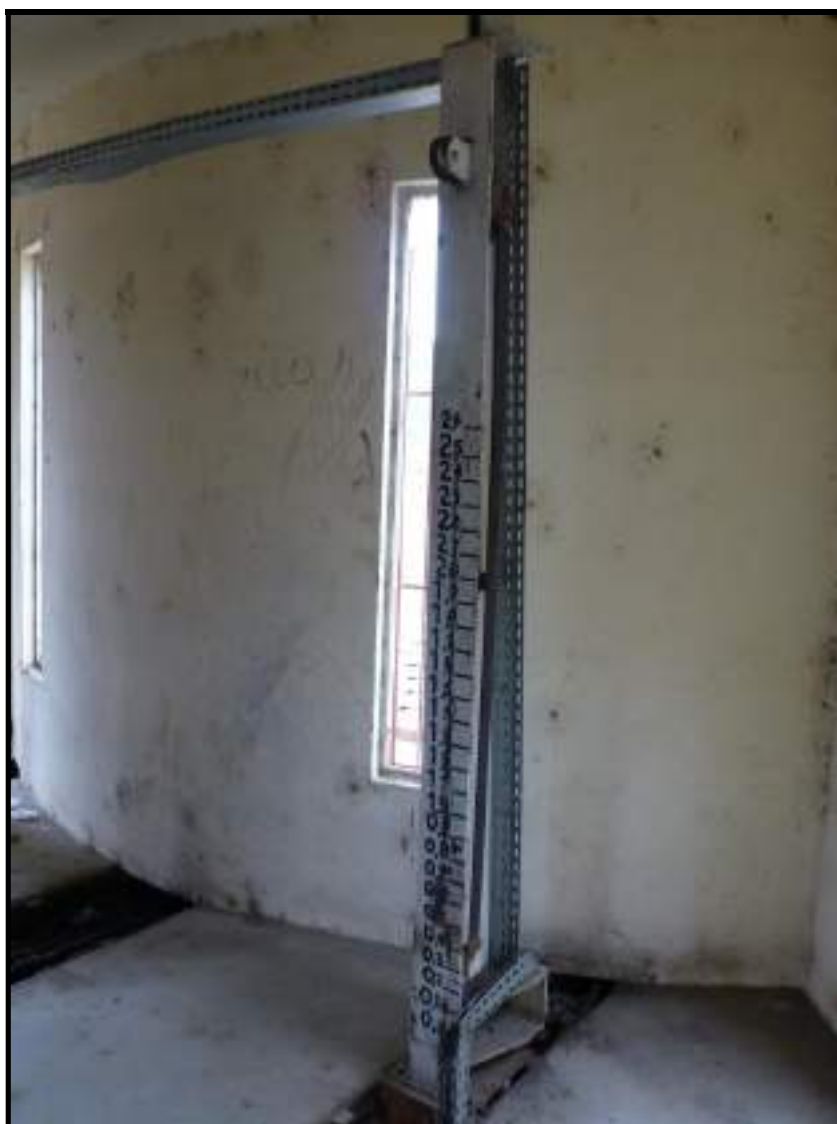
Foto 22 – Régua de Medição da Abertura da Comporta situada na Casa de Comando das Comportas
