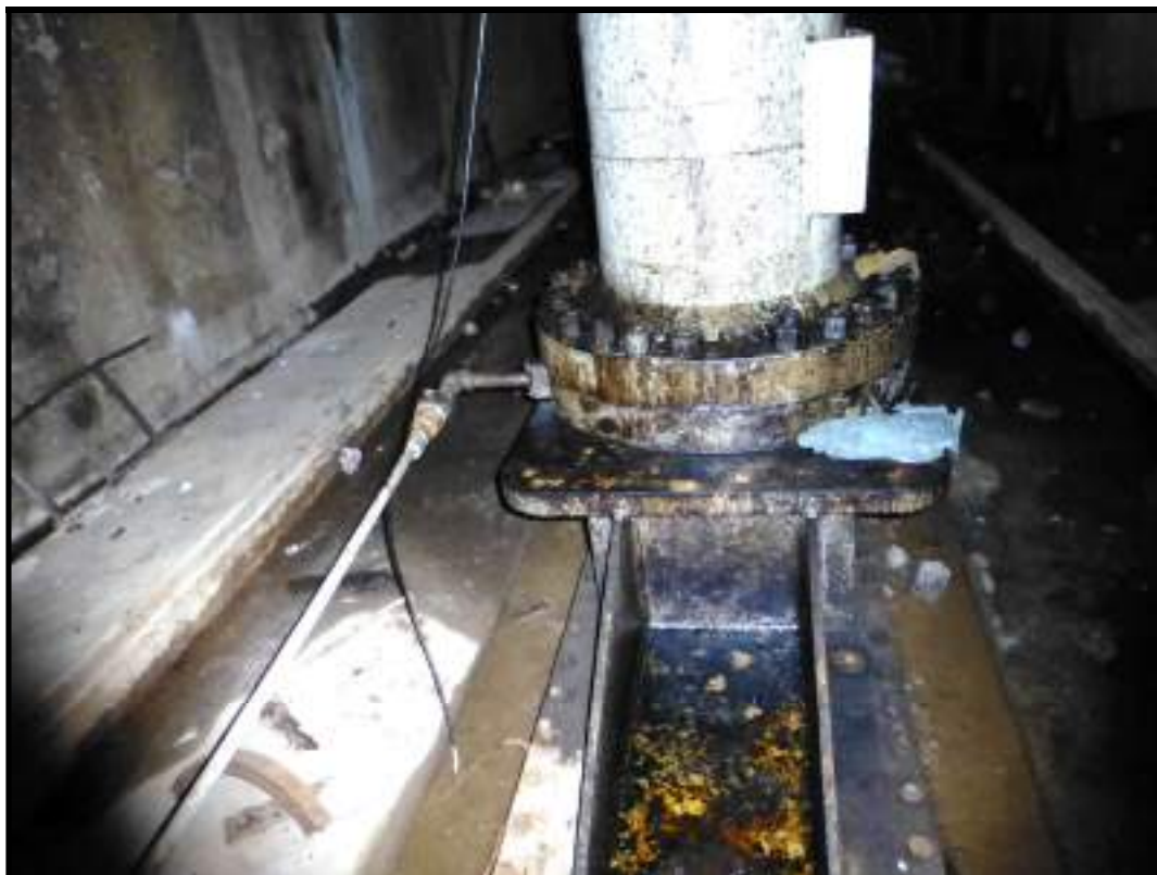
Foto 20 – Detalhe da Base do Servomotor de Acionamento da Comporta
