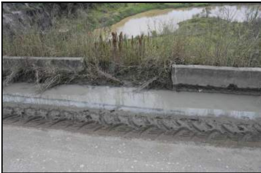
Foto 4 - Blocos do Meio Fio Removidos para Permitir a Drenagem da Crista
