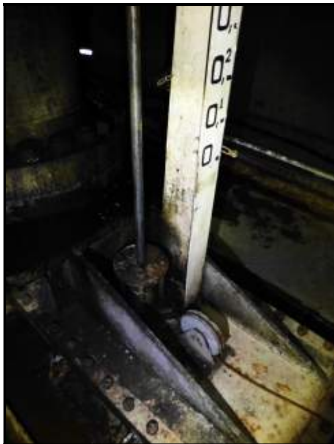
Foto 24 – Sistema de medição de Abertura da Comporta Situada na Galeria das Comportas Deslizantes
