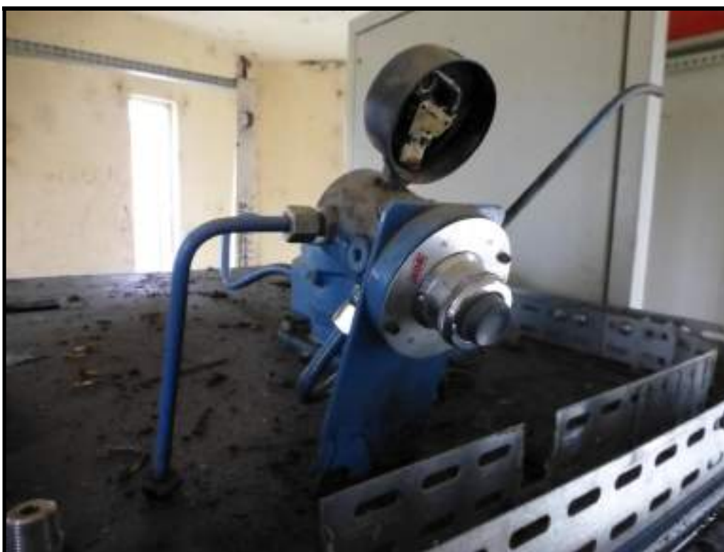
Foto 13 – Unidade Hidráulica de Acionamento das Comportas Totalmente Inutilizada
