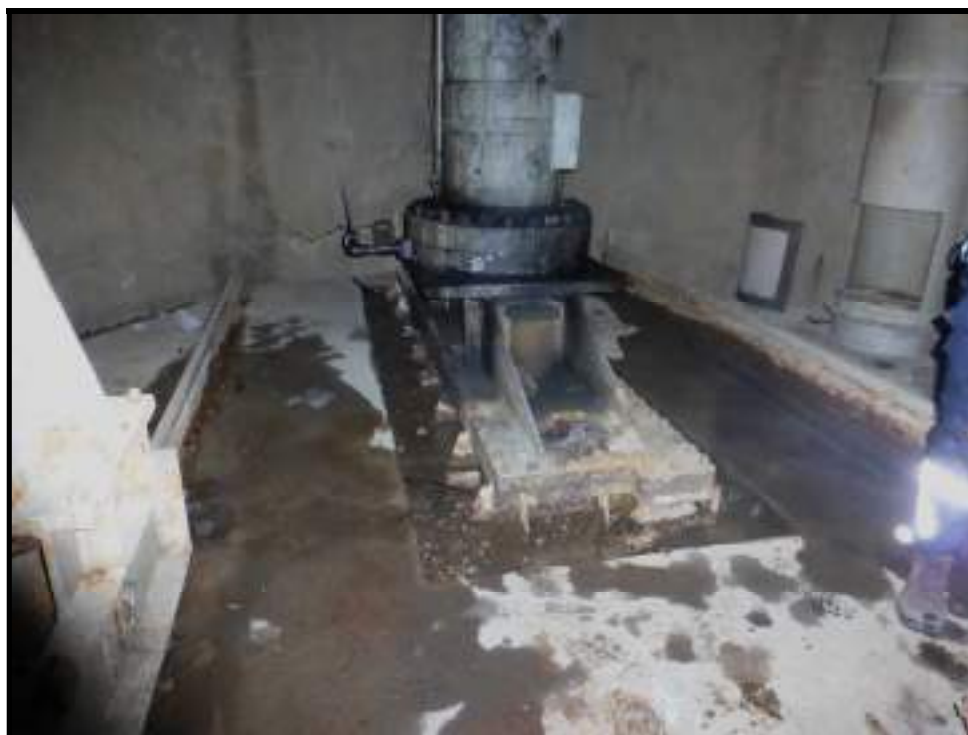
Foto 19 – Base do Servomotor de Acionamento da Comporta
