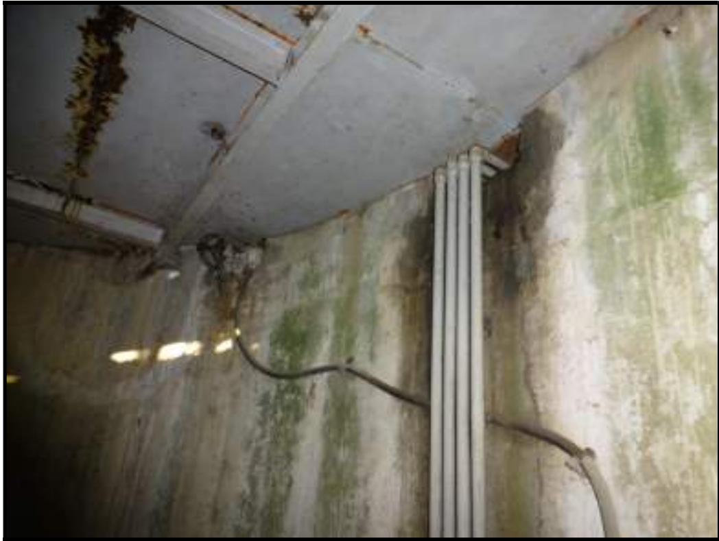
Foto 15 – Condutores Metálicos de Óleo da Unidade Óleo-Hidráulica de Acionamento das Comportas em Bom Estado, com Necessidade Manutenção e Pintura.
