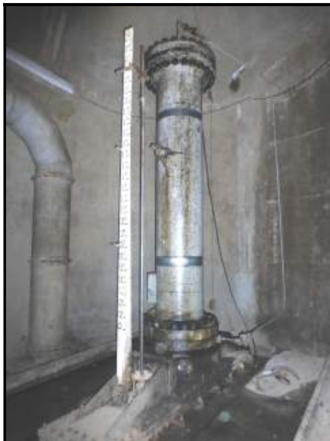
Foto 18 – Servomotor de Acionamento da Comporta
