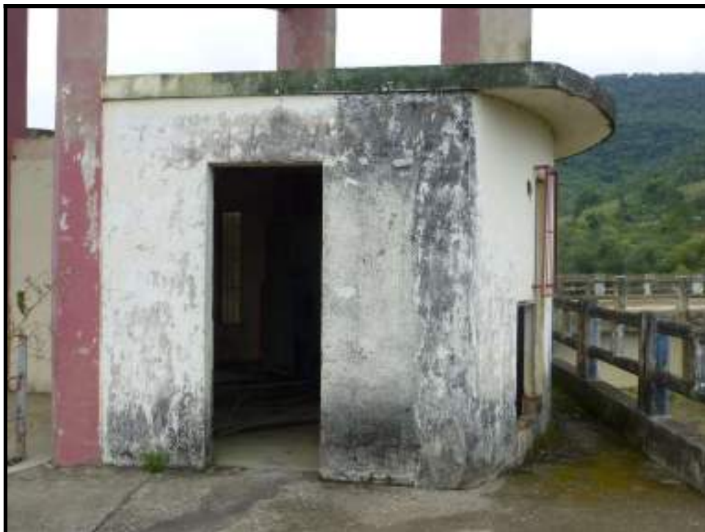
Foto 43 – Vista Externa da Edificação da Casa de Comando das Comportas (totalmente depredada)
