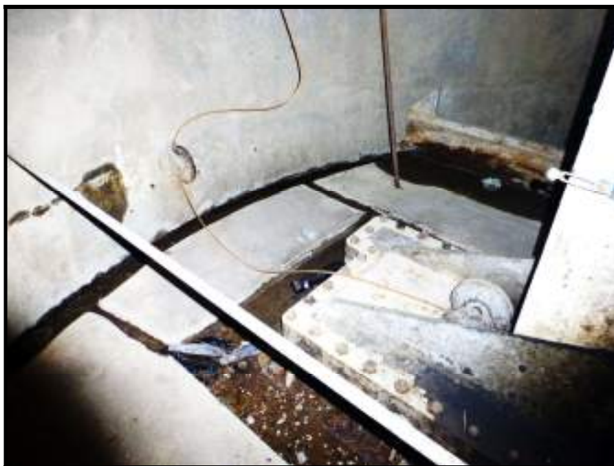
Foto 25 - Cabos e Roldanas do Sistema de Medição de Abertura das Comportas
