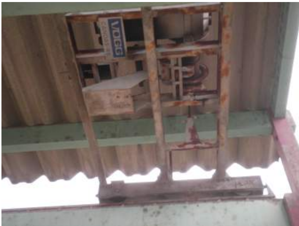
Fotos 4 – Ponte Rolante Ausência das Roldanas, do Gancho, Cabo de Aço e Gancho da Elevação.
