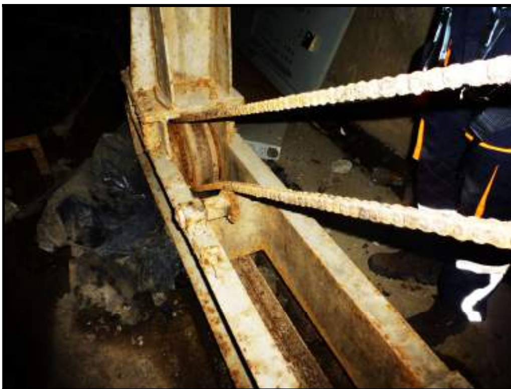
Foto 11 – Detalhe da Corrente de Acionamento das Rodas do Pórtico Móvel de Manutenção das Comportas Deslizantes
