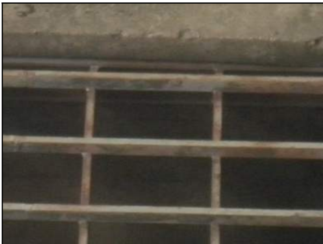
Foto 39 – Ocorrência de Problemas de Corrosão nas Lâminas das Grades
