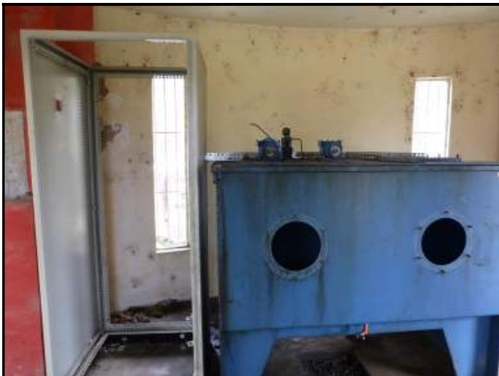
Foto 12 – Painel Elétrico de Proteção e Comando e Unidade Hidráulica de Acionamento das Comportas Inutilizados.
