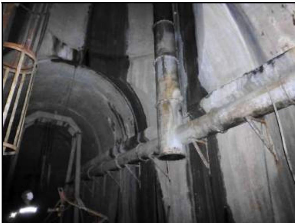
Foto 27 – “Junção” dos Dutos de Aeração das Comportas Deslizantes
