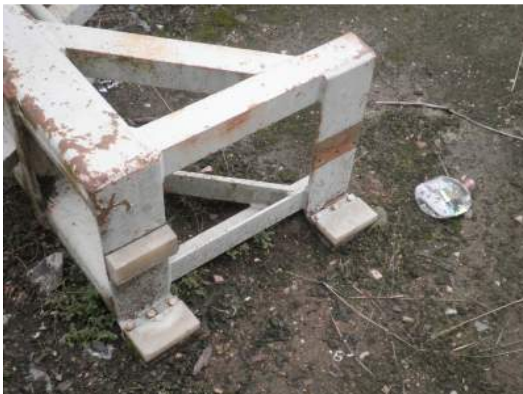
Foto 6 - Desaparecimento da Guia de Teflon da Viga Pescadora.
