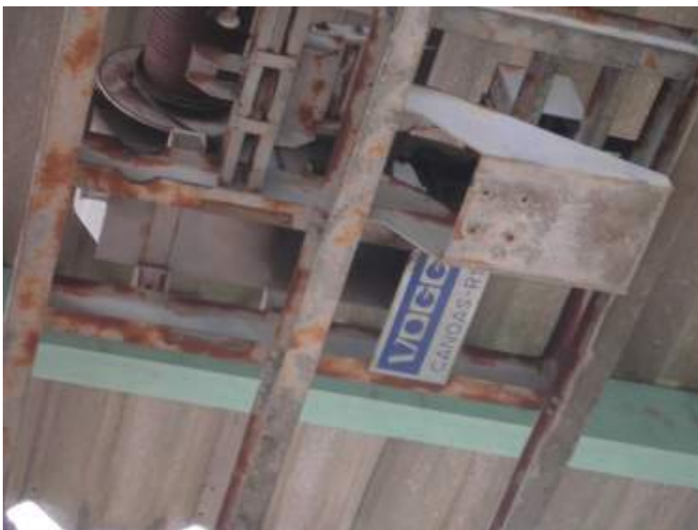
Fotos 3 – Ponte Rolante com Ausência das Roldanas, do Gancho, Cabo de Aço e Gancho da Elevação.
