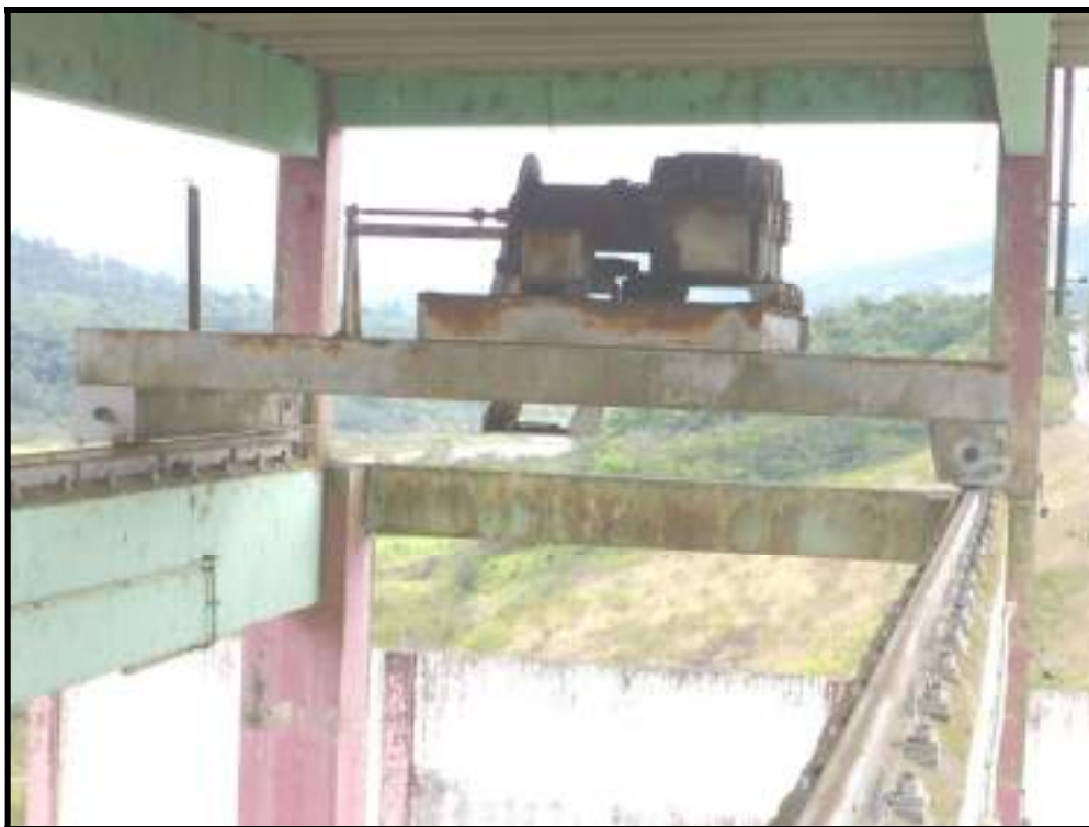
Foto 2 – Trilhos e Ponte Rolante de Manutenção das Comportas
