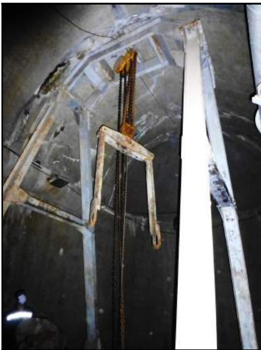
Foto 9 – Pórtico Móvel de Manutenção das Comportas de Controle de Vazão
