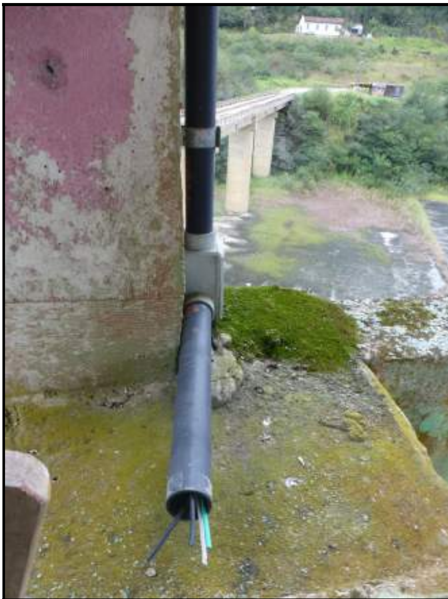
Foto 56 – Resquício do Sistema de Iluminação da Estrutura da Ponte Rolante de Manutenção das Comportas
