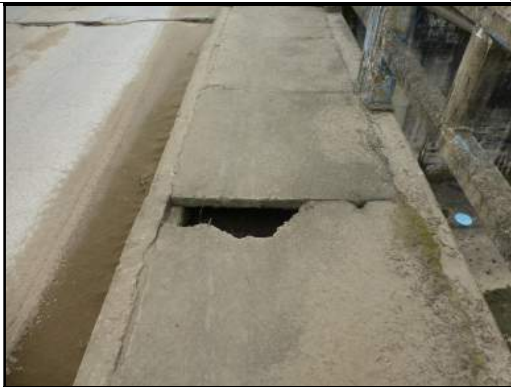
Foto 53 – Canaleta de Cabos Elétricos sob a Passarela de Pedestres da Ponte sobre o Canal de Restituição do Vertedouro
