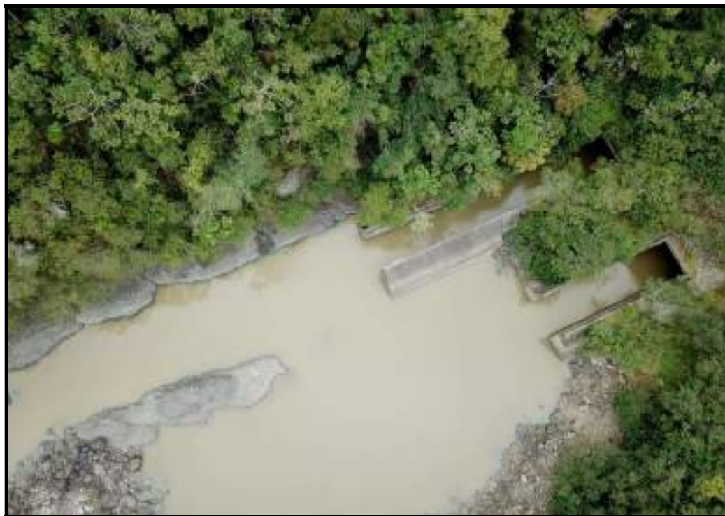
Foto 39 - Margem Esquerda do Canal a Jusante da Saída dos Túneis onde se formou uma bacia devido a erosão.
