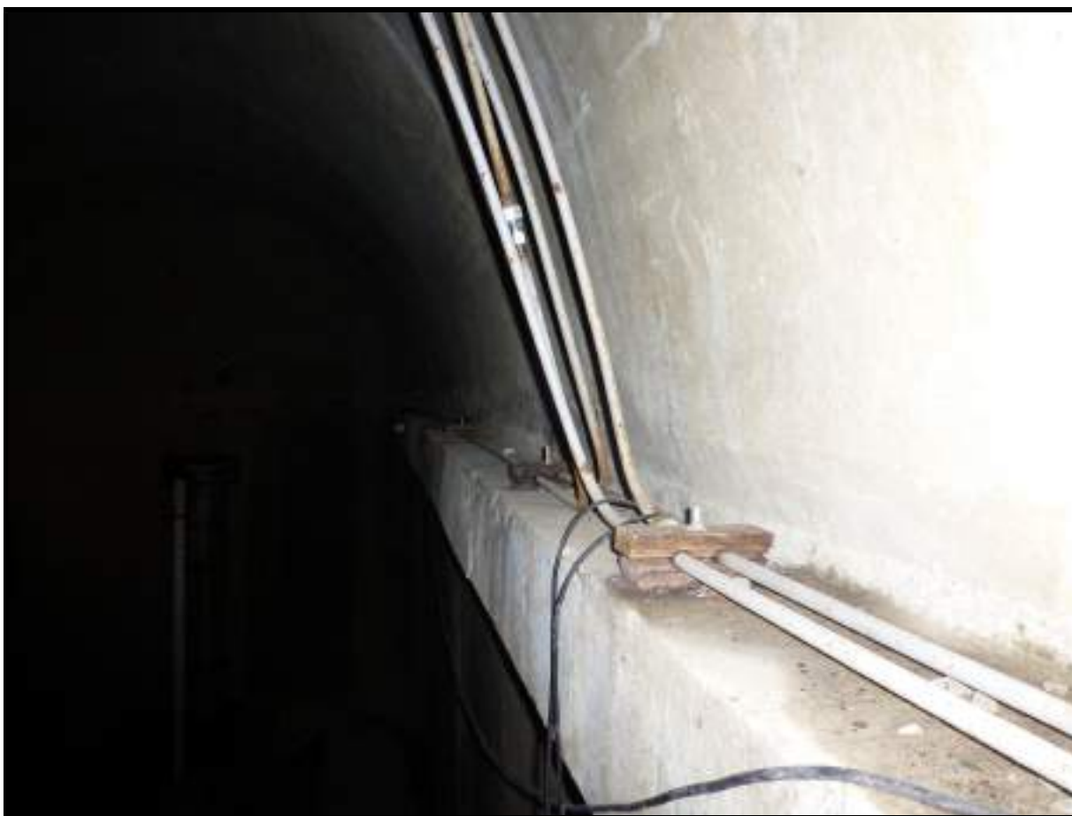
Foto 17 – Conduitos Metálicos de Óleo da Unidade Óleo-Hidráulica da Acionamento das Comportas em Bom Estado, com Necessidade Manutenção e Pintura.
