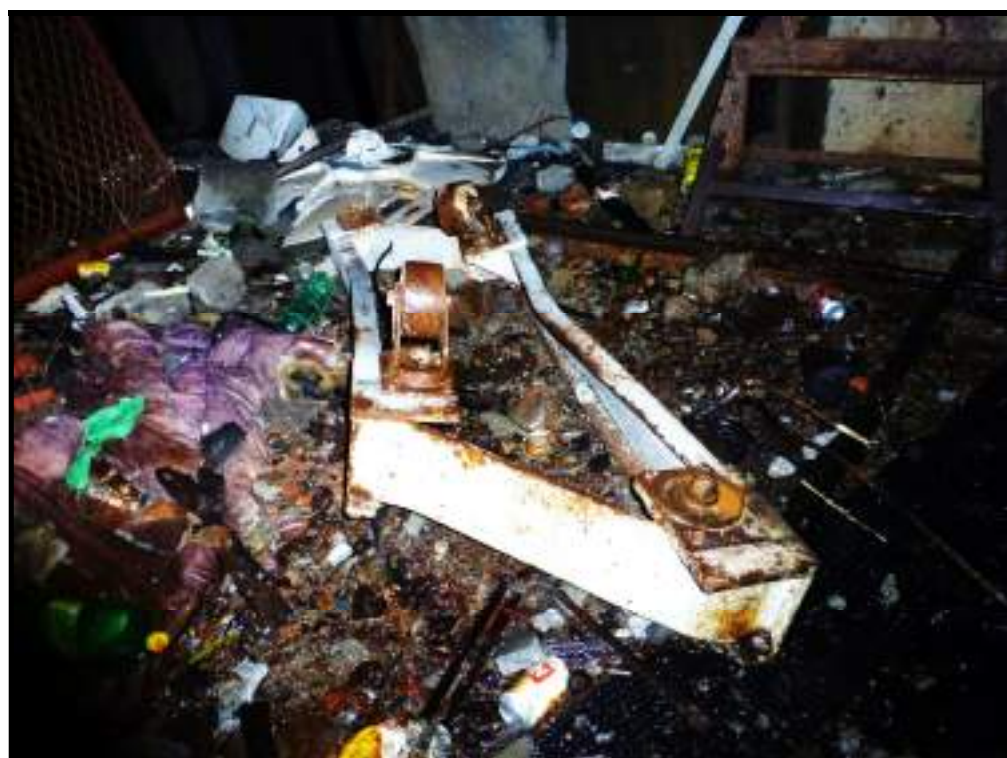
Foto 8 – Carro Metálico com Rodas (Totalmente Depredado) de Transporte de Pequenas Cargas da Galeria das Comportas
