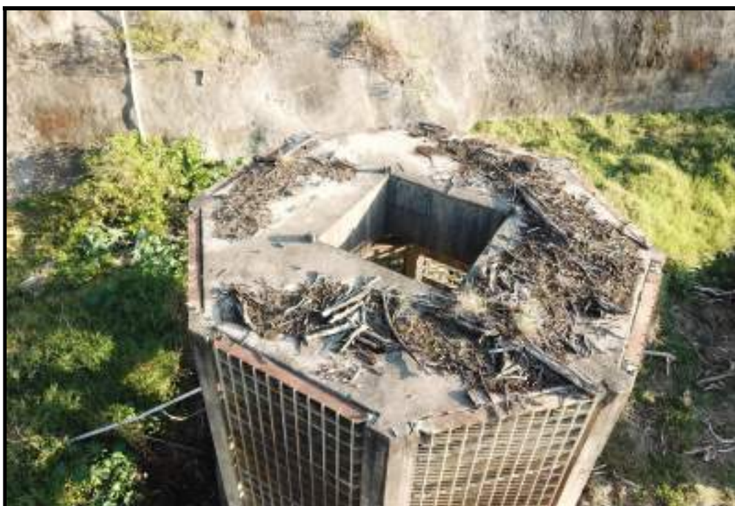
Foto 33 – Ausência da Grade da Laje Superior da Estrutura de Emboque Tipo Tulipa do Túnel Interno de Descarga (Esquerdo)
