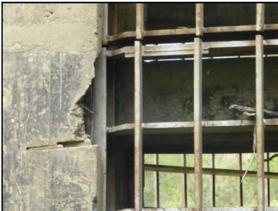
Foto 40 – Ocorrência de Ferragens Expostas junto às Guias das Grades das Estruturas de Emboque Tipo Tulipa dos Túneis de Descarga
