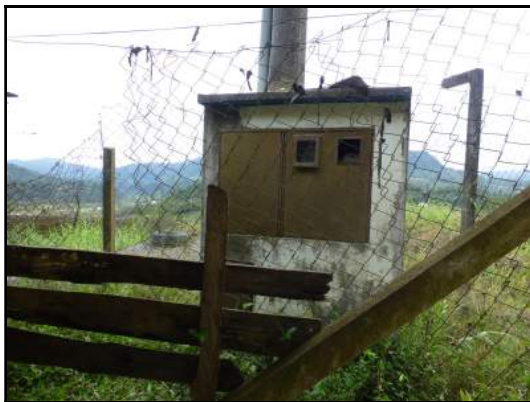
Foto 52 – Posto de Medição, Proteção e Seccionamento do Sistema de Alimentação Elétrica
