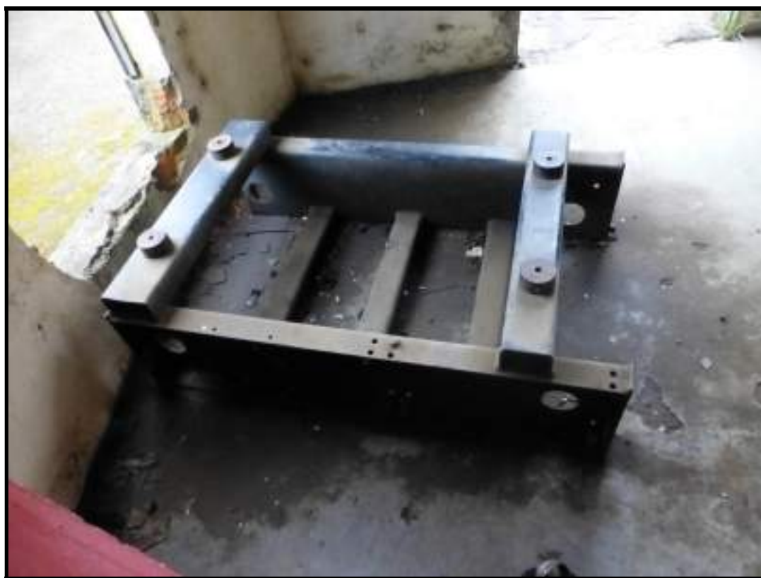
Foto 55 – “Skid” do Grupo Gerador Diesel-Elétrico do Sistema de Alimentação Emergencial de Energia Elétrica da Plataforma de Operação das Comportas.
