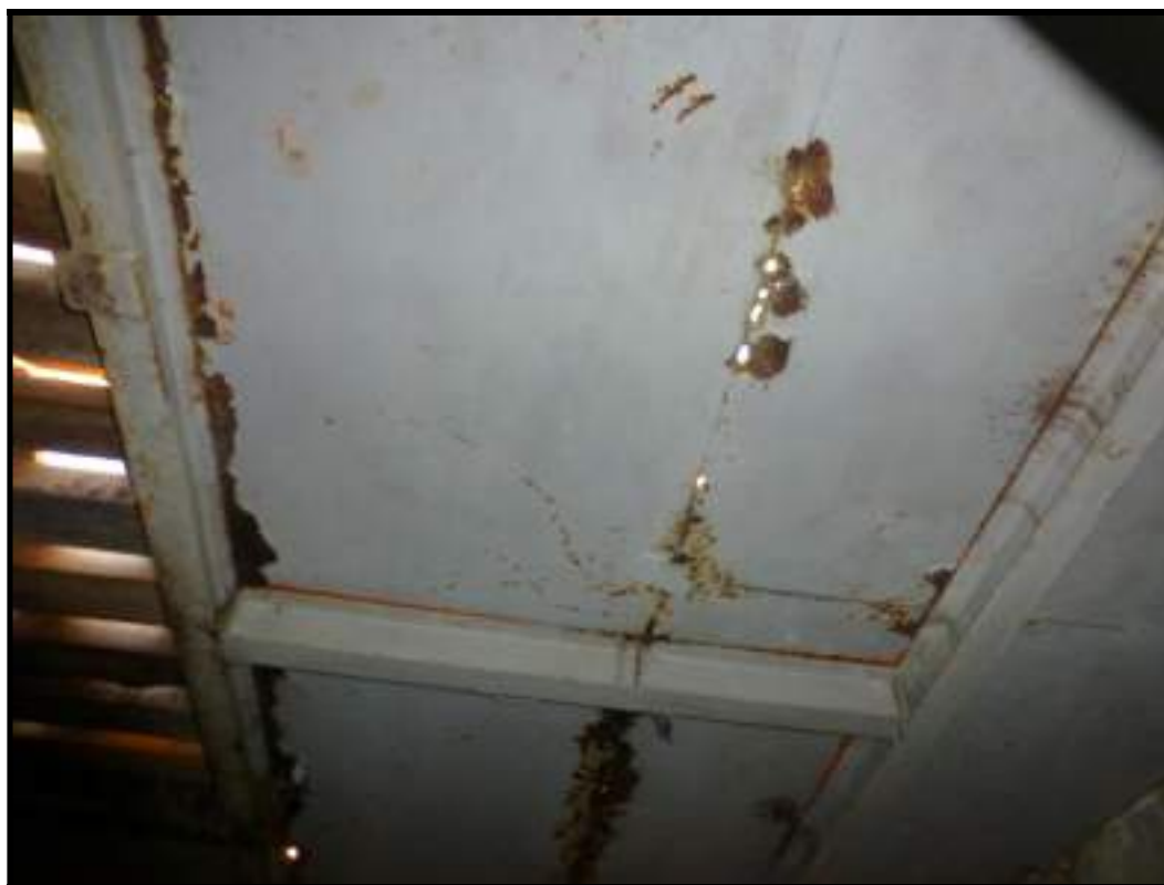
Foto 43 – Tampa Metálica do poço de acesso à Galeria das Comportas com problemas de corrosão decorrente de falta da manutenção.
