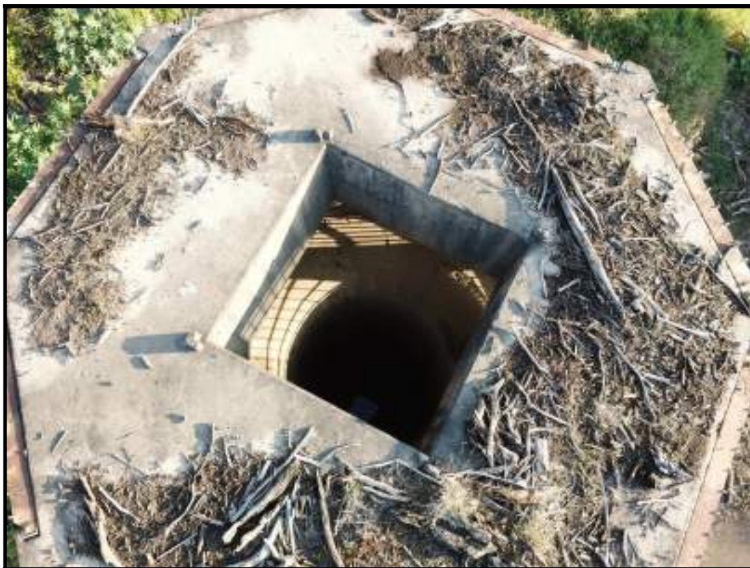
Foto 34 – Ausência da Grade da Laje Superior da Estrutura de Emboque Tipo Tulipa do Túnel Interno de Descarga (Esquerdo)
