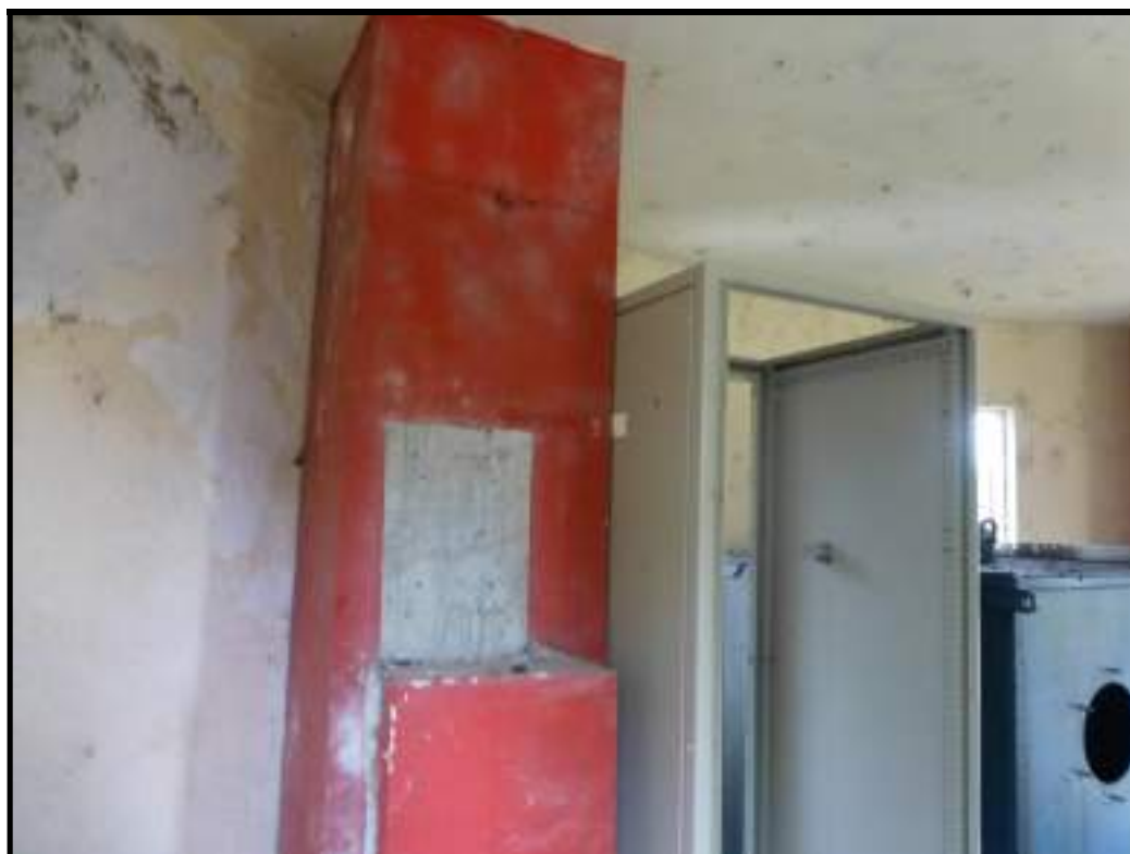
Foto 54 – Resquício da Caixa de Seccionamento, Proteção e Distribuição de Energia Elétrica (Coluna Vermelha)
