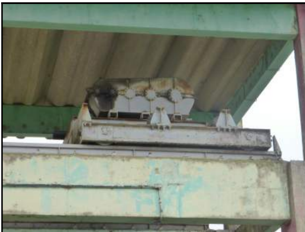
Foto 1 – Ponte Rolante de Manutenção das Comportas
