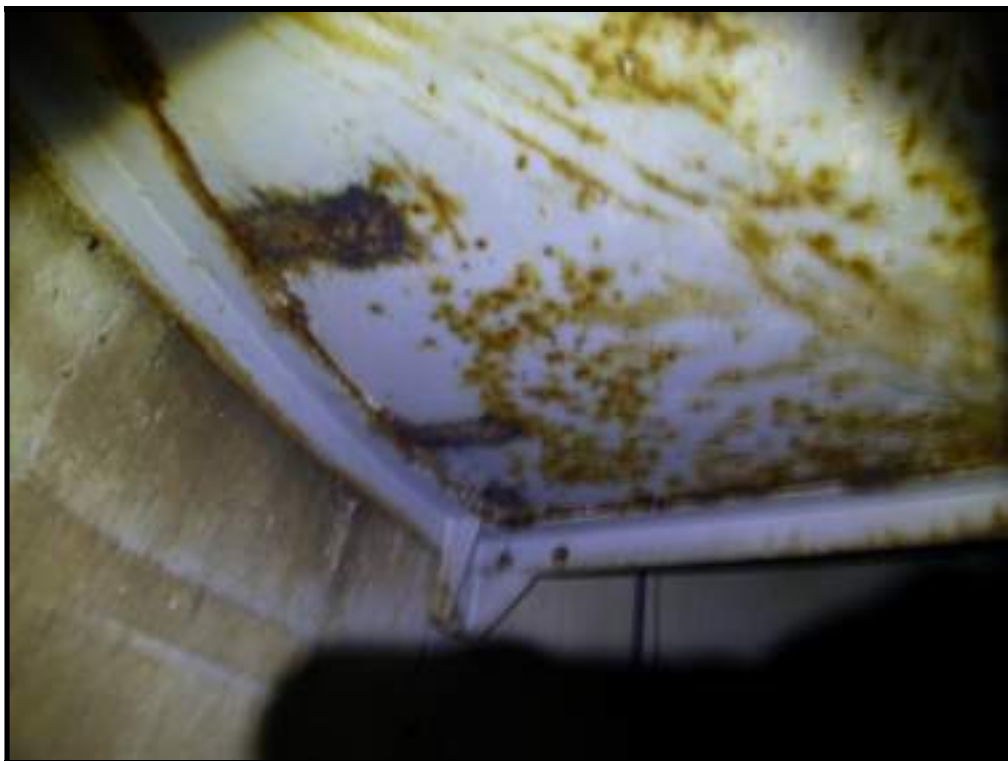
Foto 49 – Vista inferior do Patamar de Descanso da Escada Tipo Marinheiro do poço de acesso à Galeria das Comportas, com problemas avançados de corrosão.
