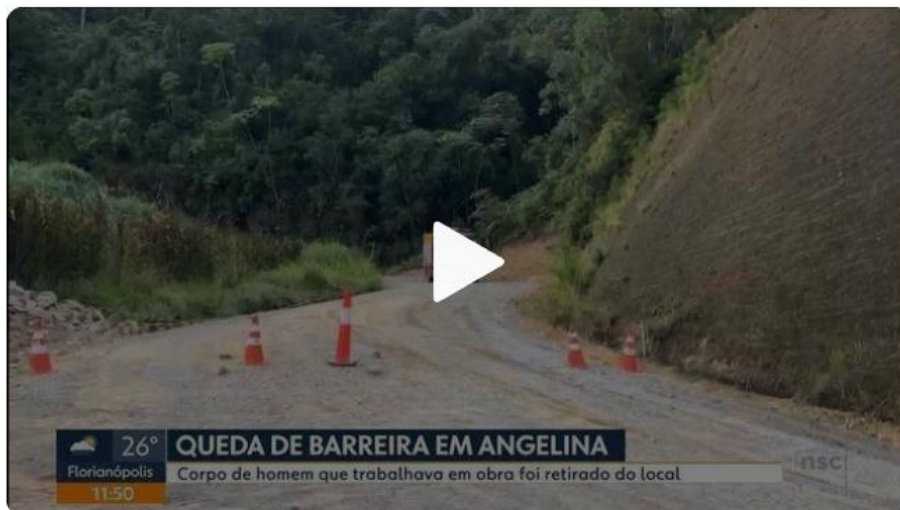
Queda de barreira em Angelina: homem que trabalhava no asfaltamento foi soterrado e morreu
