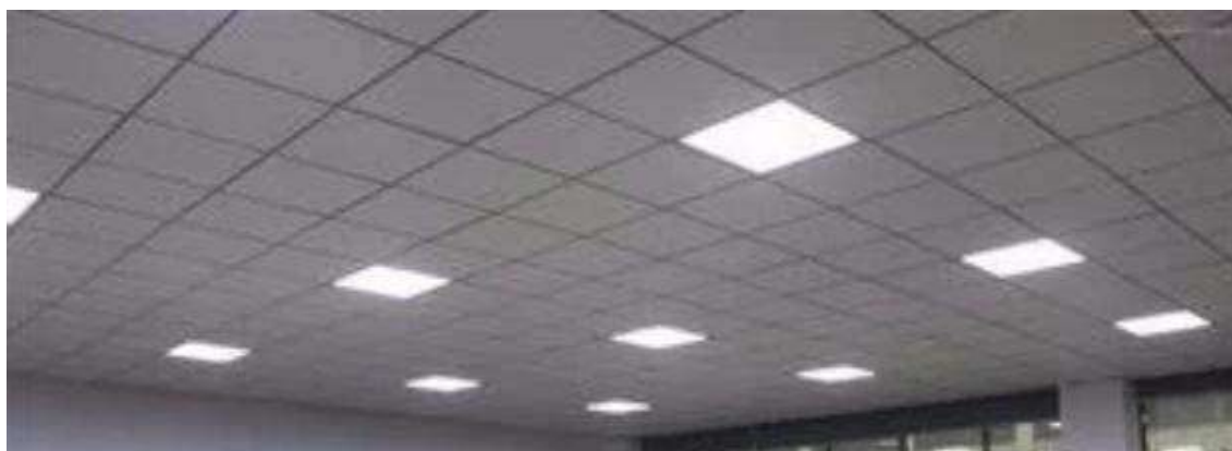
Figura 2 – Luminária Plafon instalada em forro modular.
