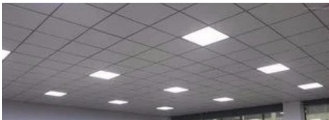
Figura 2 – Luminária Plafon instalada em forro modular.
