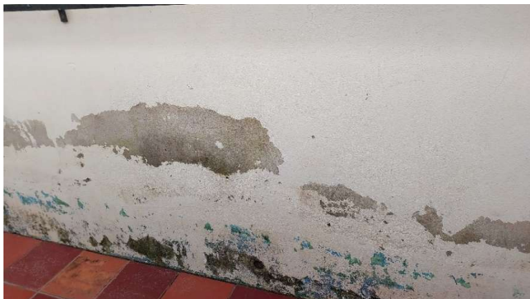
Figura 04: Áreas de Infiltração Externa
