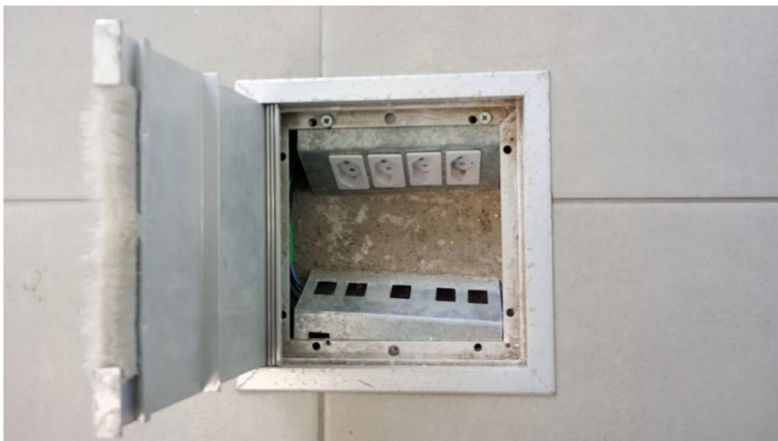
*Vista das caixas de solo para passagem de cabos
