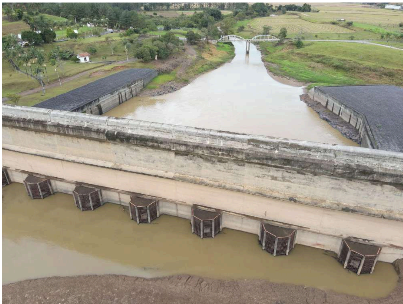
Figura 9. Montante das comportas de fundo.
