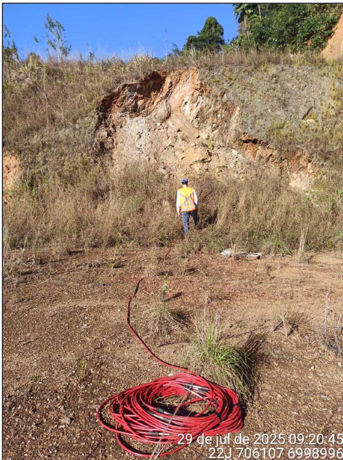
Fotografias 2 – Deslizamento observado no talude de corte do terreno onde será instalado o reservatório Rio Branco, demonstrando a instabilidade do substrato rochoso.
