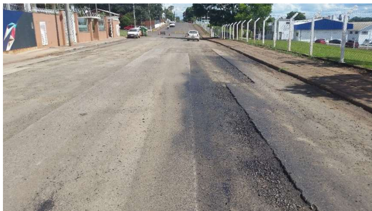
Figura 25 - Fresagem descontínua do pavimento. Ex.: Rua Antônio Morandini
