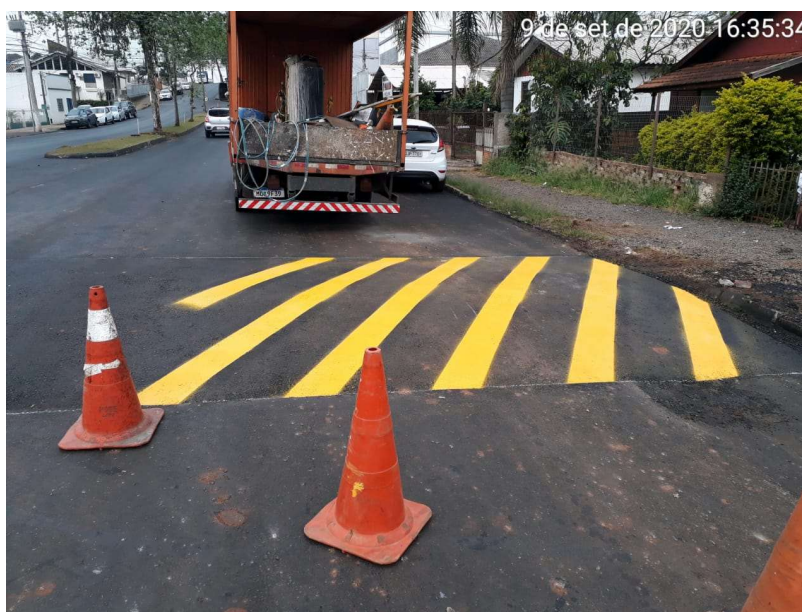
Figura 29 - Sinalização de lombadas físicas. Importante sinalizar horizontalmente para liberação do trânsito
