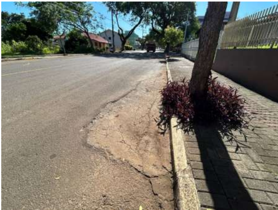
Foto 5 – Pavimentação com desgaste
