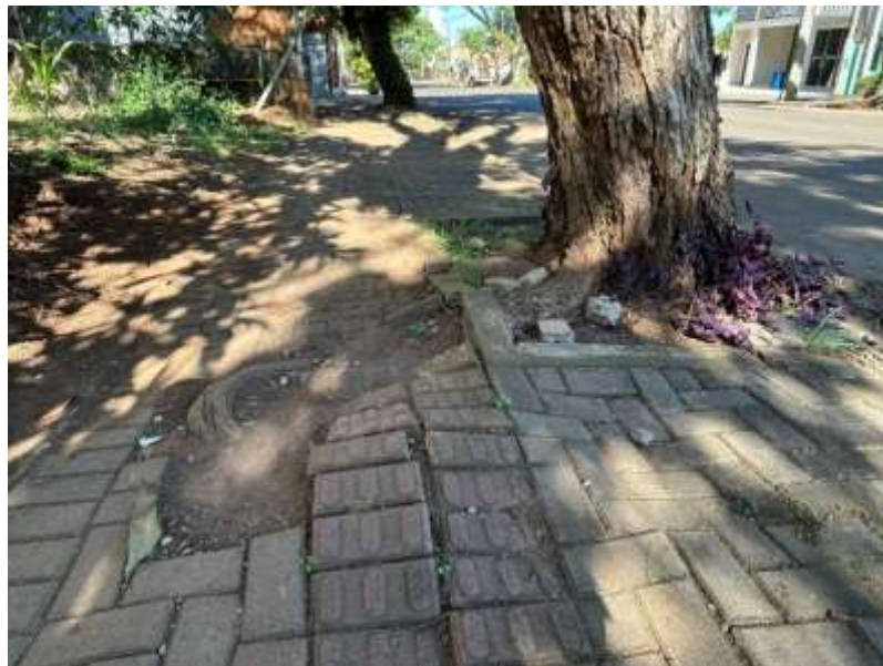
Foto 1 – Raízes das árvores danificando os passeios
