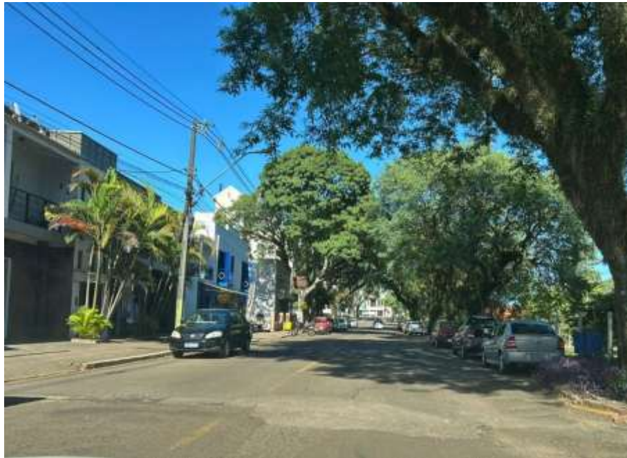
Foto 6 – Pavimentação com desgaste
