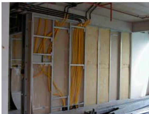
Passagem das tubulações
