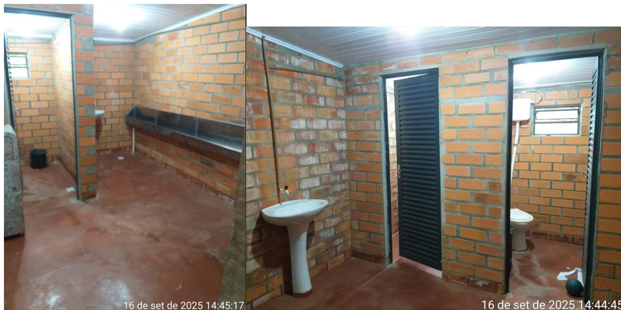
Imagem 07– Banheiros sem acessibilidade.
