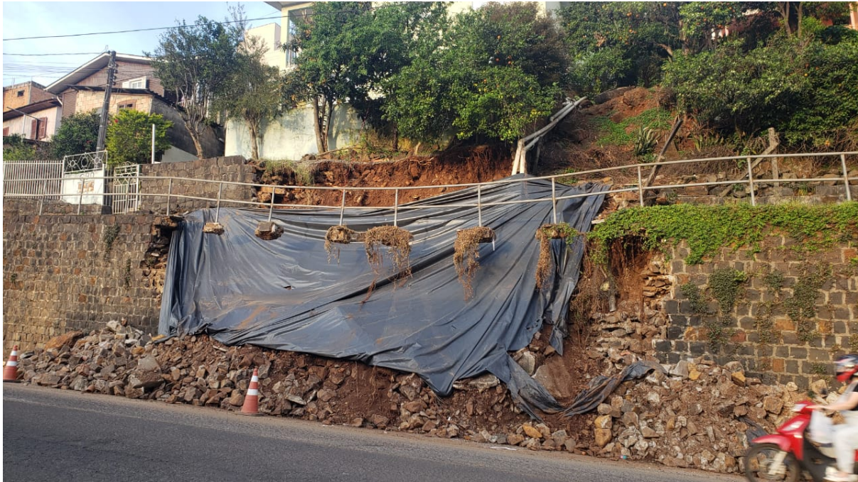
Foto 03 – Foto aérea do local dos problemas geotécnicos – Fonte: O Autor
