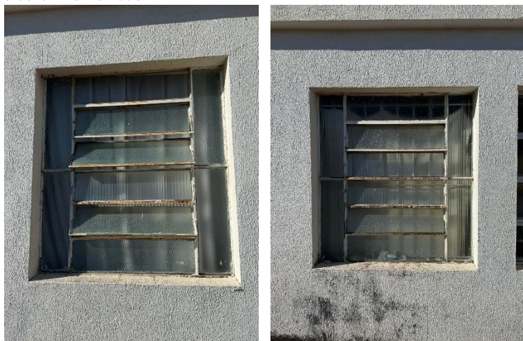
Fotografias 04 e 05 - Esquadrias de ferro e vidro existente a serem removidas.
