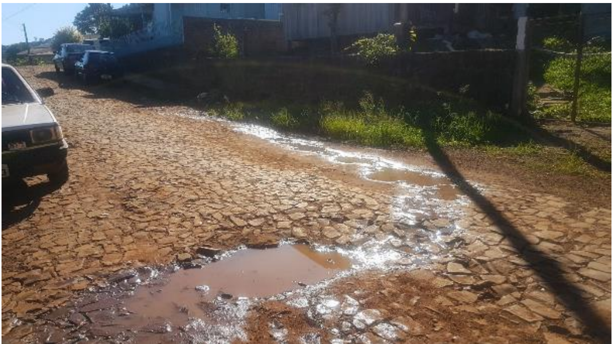
Figura 59 – Água acumulada na direção do talvegue
