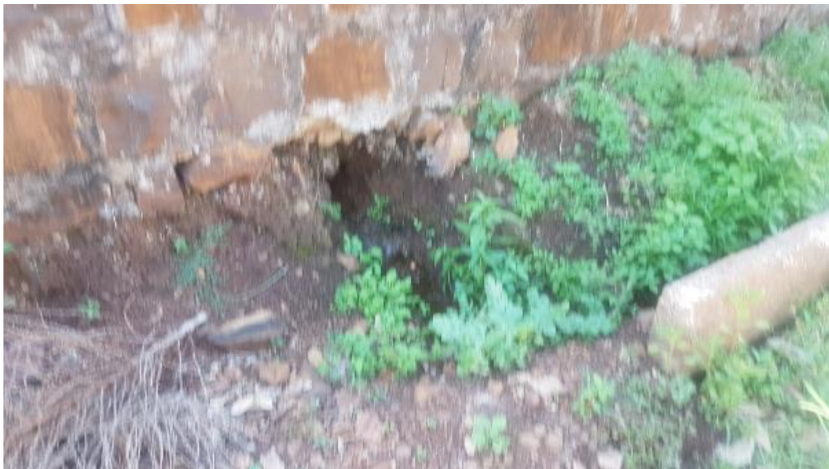
Figura 60 – Escape para a água que corre sobre o lote 6A – Q90.
