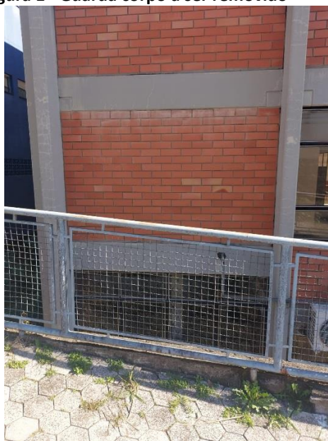
Figura 1 - Guarda corpo a ser removido
