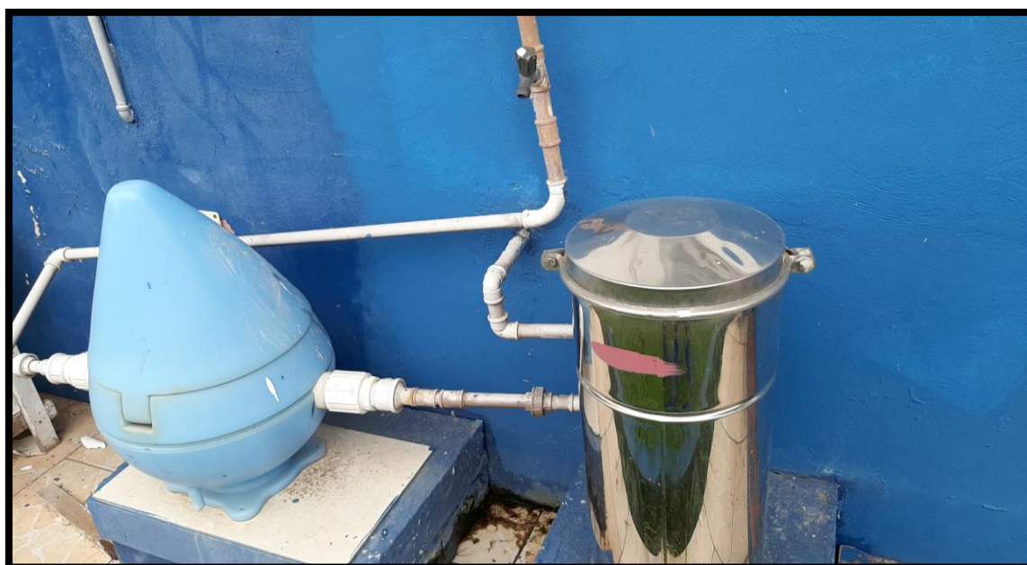
Figura 1 - Sistema Gutwasser e filtro de entrada
