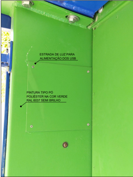
ENTRADA DE ENERGIA
